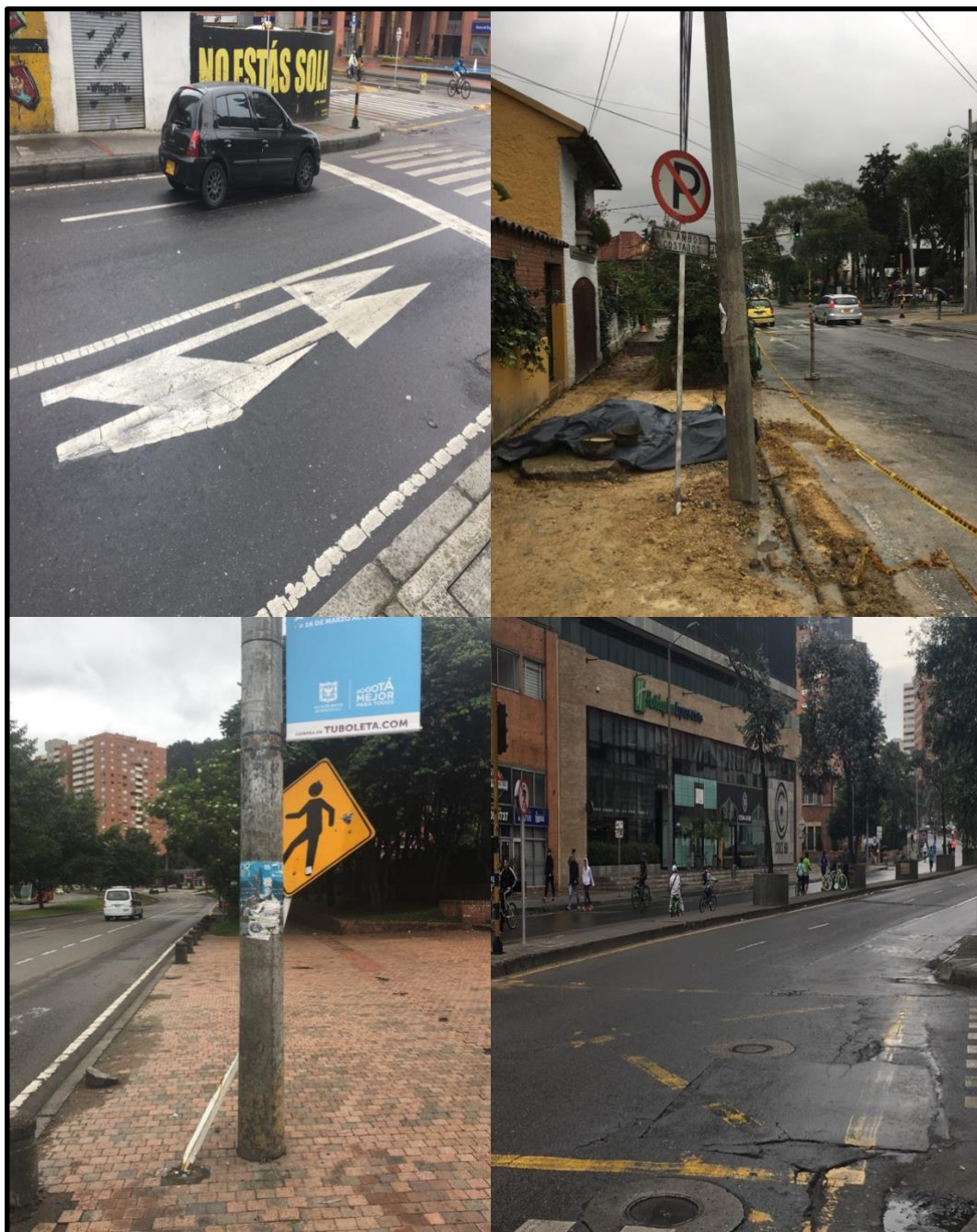
Figura 43. Fotografías del mal estado de las intersecciones
