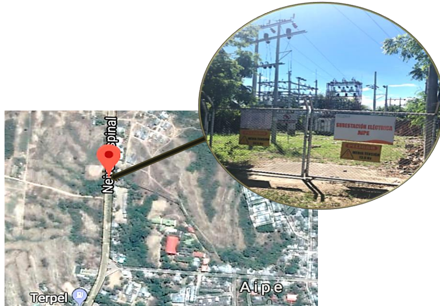
Ilustración 37. Ubicación subestación Aipe
