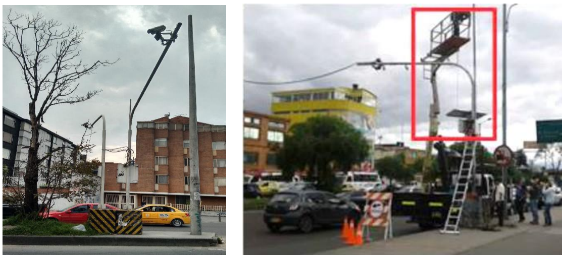
Figura 76 Instalación sistemas cámaras de video de detección.
