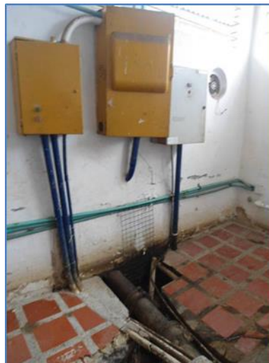
Imagen 6 Tablero de Control Bomba. Fuente: Propia autoría.
