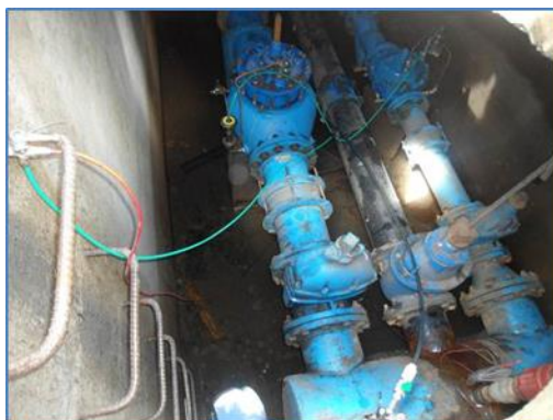
Imagen 4 Estación Reguladora de Presión- Estación Ferrocarril-La Caro. Fuente: Propia autoría
