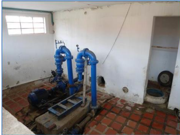
Imagen 5 Estación de bombeo de Emserchía. Fuente: Propia autoría.
