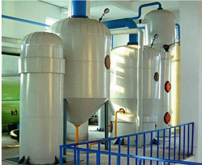
Figura 13. Evaporador de solvente para recuperación de aceite
