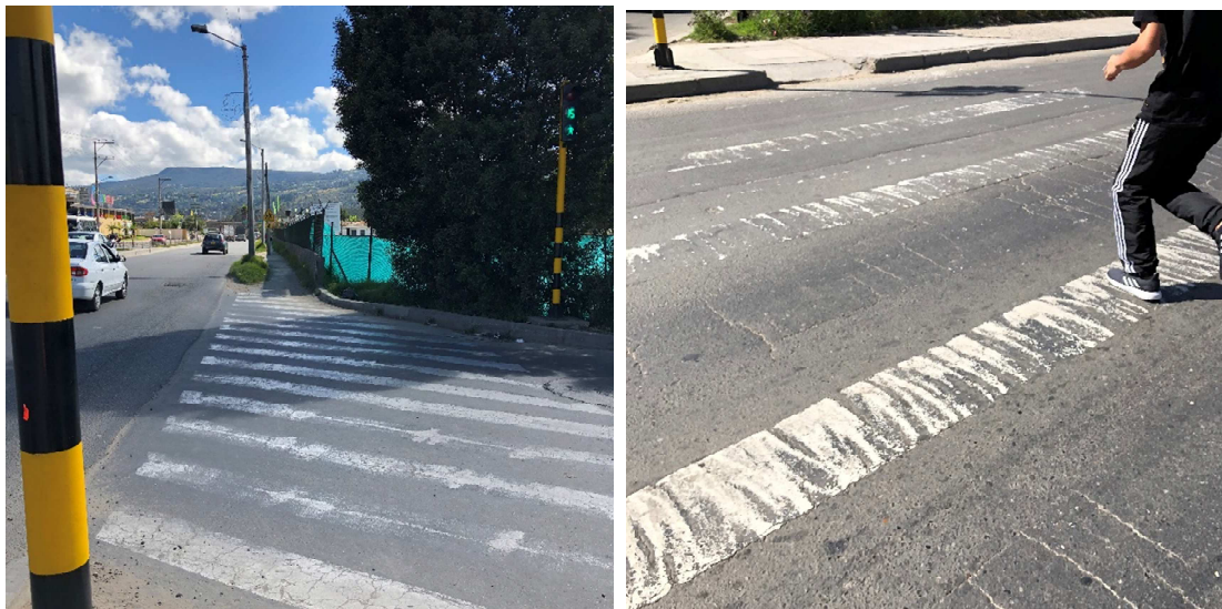
Figura 45. Señalización horizontal Av. Pradilla. Fuente: Inspección 2018
