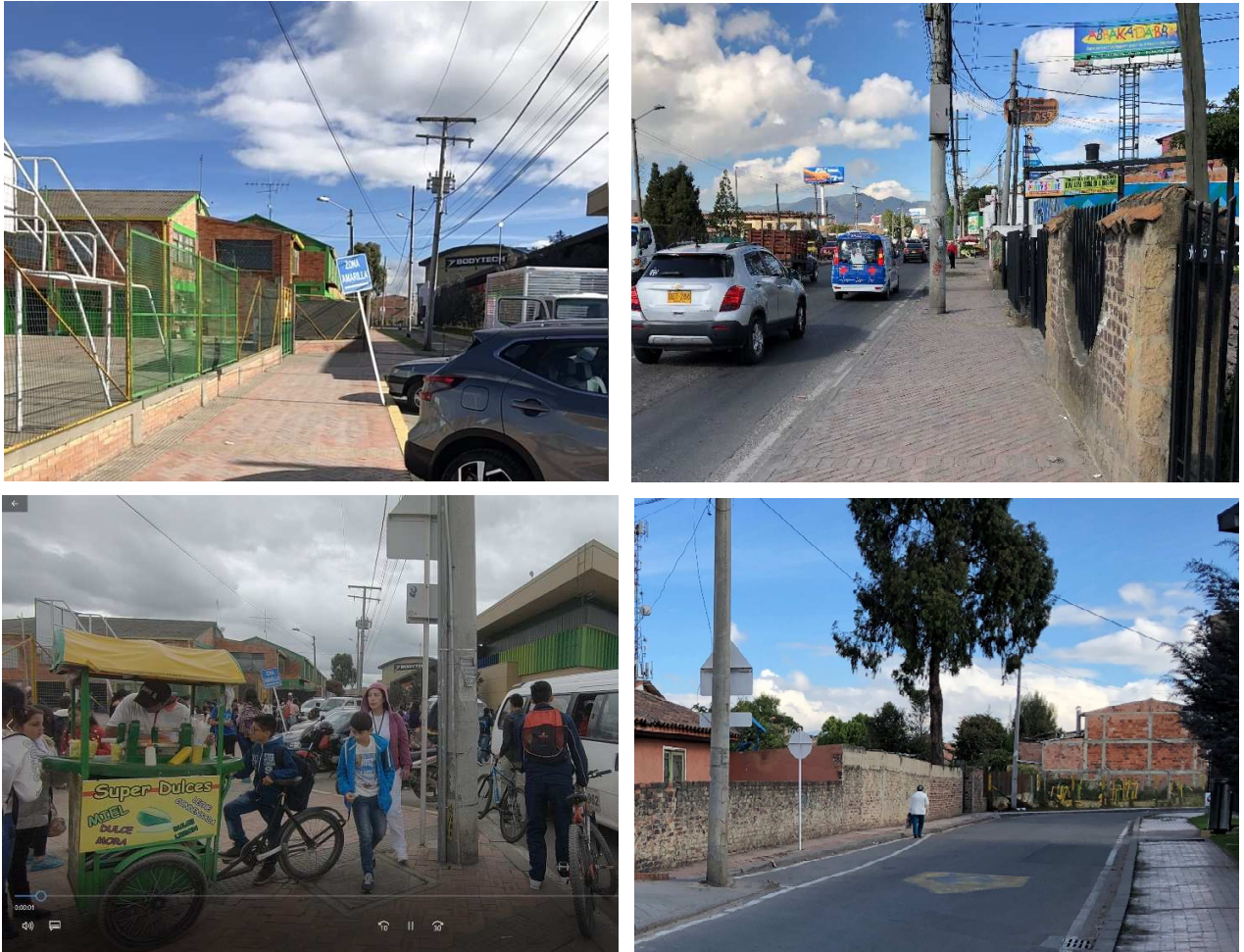
Figura 35. Deficiencia de la red de andenes. Fuente: Inspección 2018.
