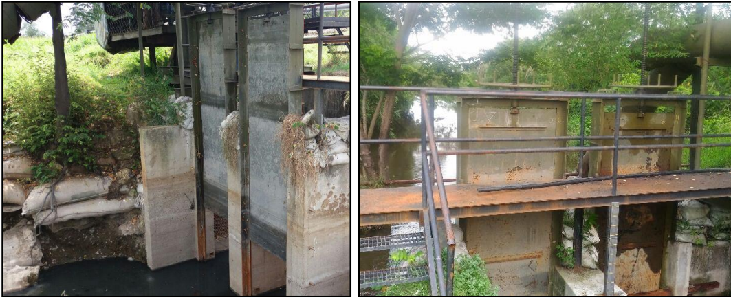
Ilustración 7. Fotografía compuertas del Canal El Progreso
