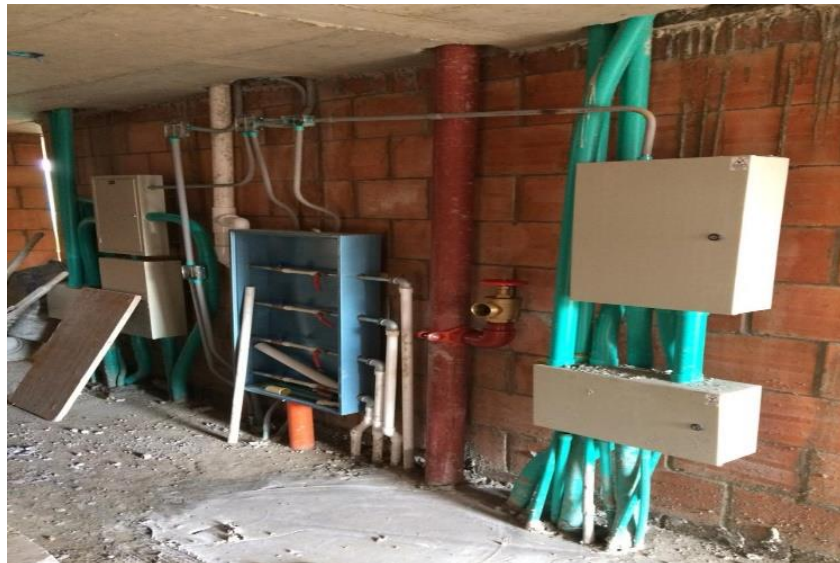
Ilustración 11.4 Área para ductos y medidores Proyecto Venti.
