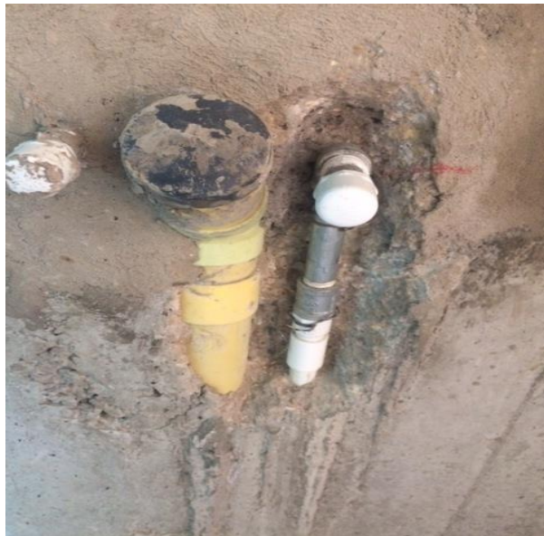
Ilustración 11.3 Acomodación de punto de A.F. en cocina debido a altura errónea, Sistema de Muros en concreto.
