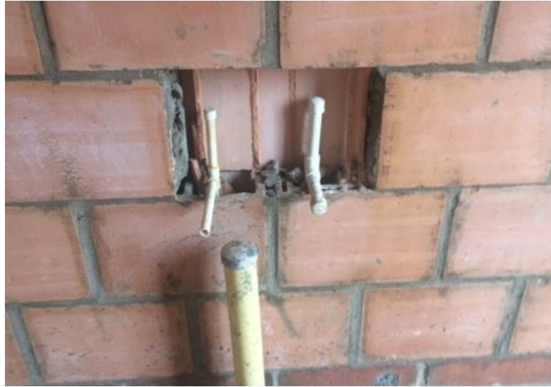
Ilustración 11.2 Acomodación de puntos de A.F. y A.C. en cocina debido a altura errónea, Sistema de Mampostería Estructural
