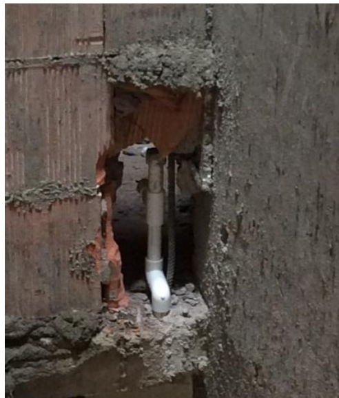
Ilustración 11.8 Reparación de punto de suministro de inodoro en muro de mampostería por perforación de acero de dovela.
