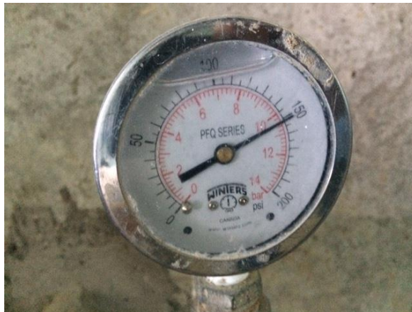
Ilustración 11.6 Manómetro de medición de presión en PSI, cargado a 150 PSI.
