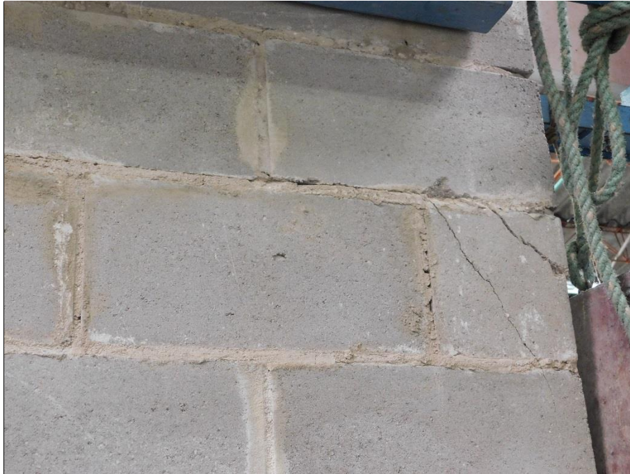
Fotografía 5.80 Línea de falla entre las hiladas 8 y 9 de parte derecha en la cara posterior
