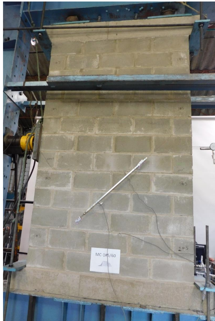
Fotografía 5.56 Fisuras en la cara frontal del muro MC-1#5/60
