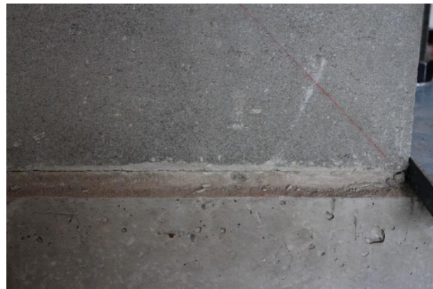
Fotografía 5.55 Desprendimiento entre la primera hilada de mampostería y la viga de cimentación
