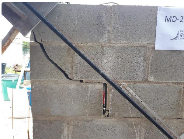
Fotografía 5.30 Fisuras de la parte superior izquierda en la cara frontal
