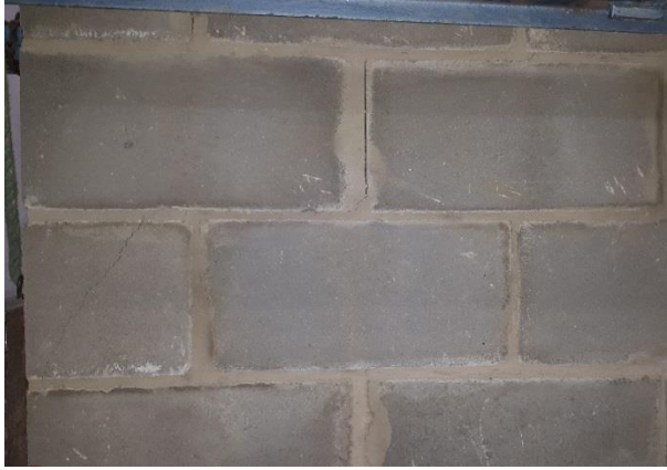
Fotografía 5.47 Fisuras de la parte central izquierda en la cara frontal
