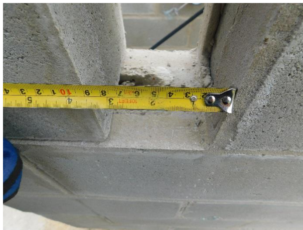
Fotografía 5.16 Desplazamiento horizontal de aproximadamente 9 cm
