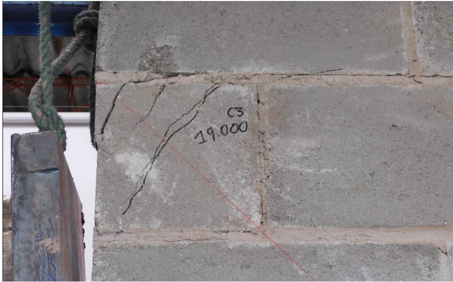
Fotografía 5.76 Aplastamiento del primer bloque de mampostería de la hilada 8
