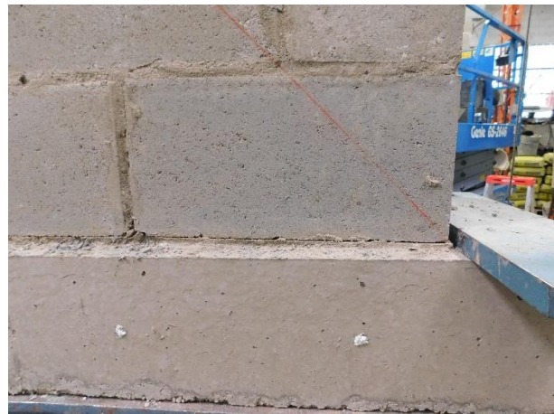
Fotografía 5.82 Desprendimiento del primer bloque de mampostería entre la primera hilada y la viga de cimentación en la cara posterior
