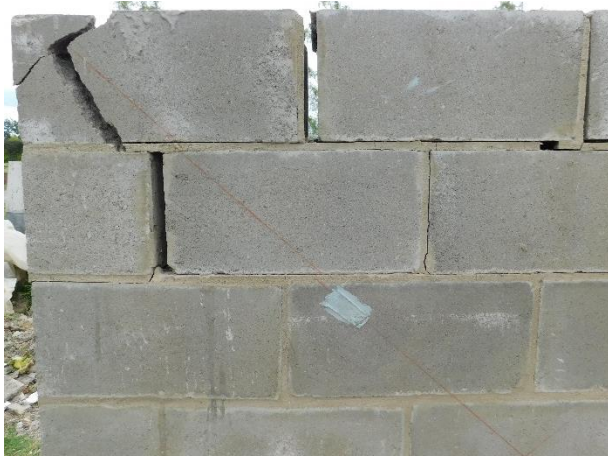
Fotografía 5.21 Fisuras de la parte superior izquierda en la cara posterior
