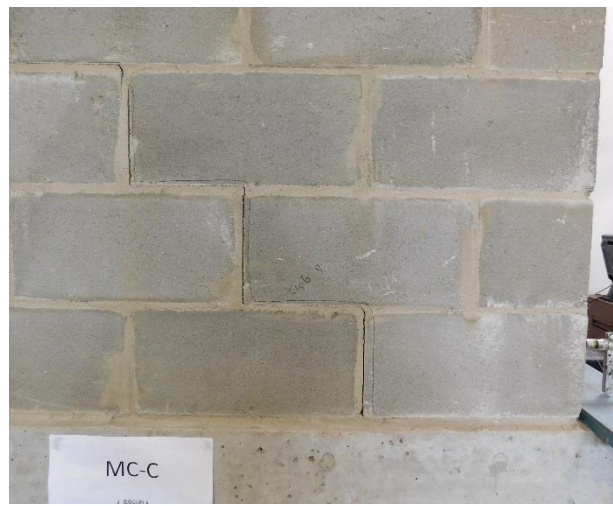
Fotografía 5.43 Fisuras de la parte inferior derecha en la cara frontal
