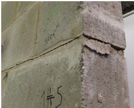
Fotografía 5.63 Desplazamiento horizontal entre las hiladas 5 y 6 en la parte derecha de la cara frontal
