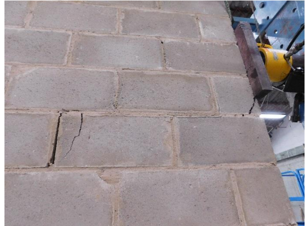
Fotografía 5.91 Fisuras en la parte derecha de la cara posterior
