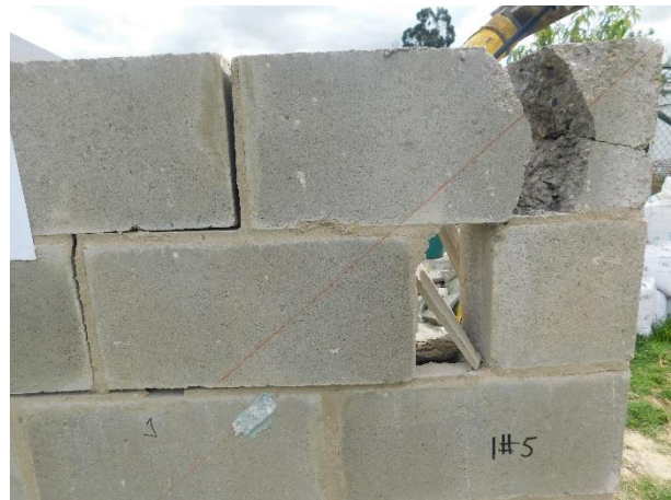
Fotografía 5.15 Fisuras de la parte superior derecha en la cara frontal
