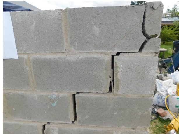
Fotografía 5.10 Fisuras de la parte superior derecha en la cara frontal
