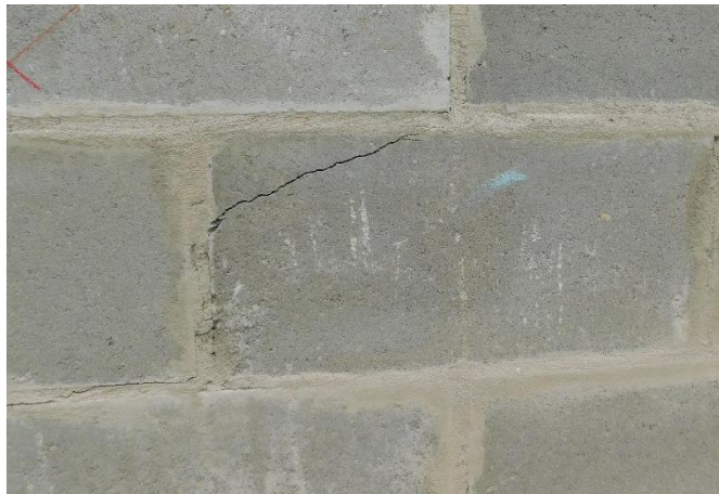
Fotografía 5.26 Fisuras en el bloque de la hilada 2 de la cara frontal
