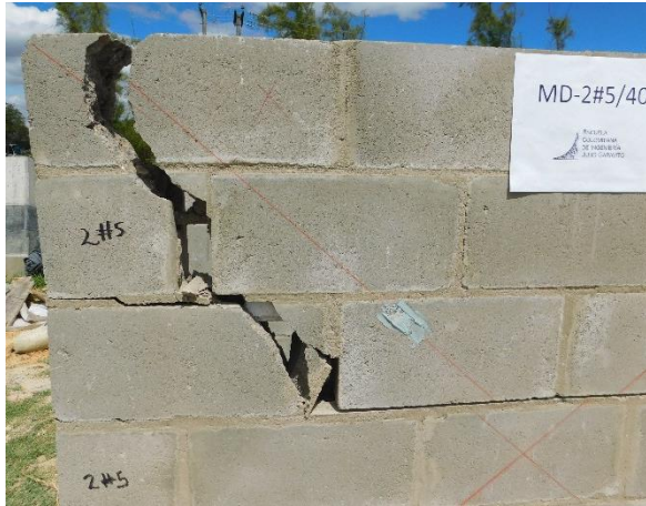
Fotografía 5.35 Fisuras de la parte superior izquierda en la cara frontal
