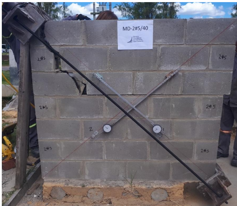
Fotografía 5.34 Fisuras en la cara frontal del muro MD-2#5/40
