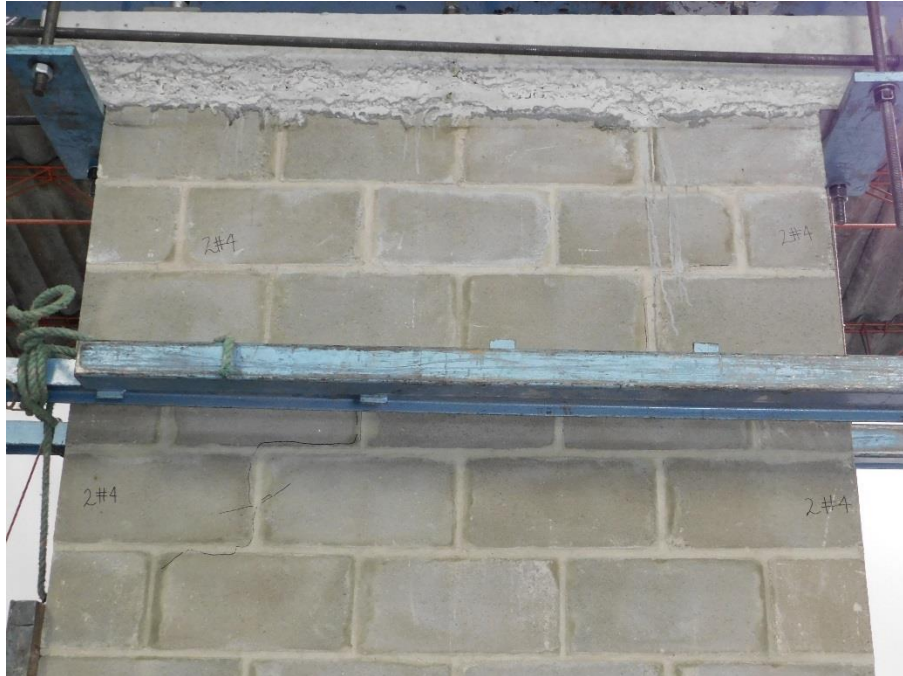
Fotografía 5.70 Fisuras de la parte superior en la cara frontal
