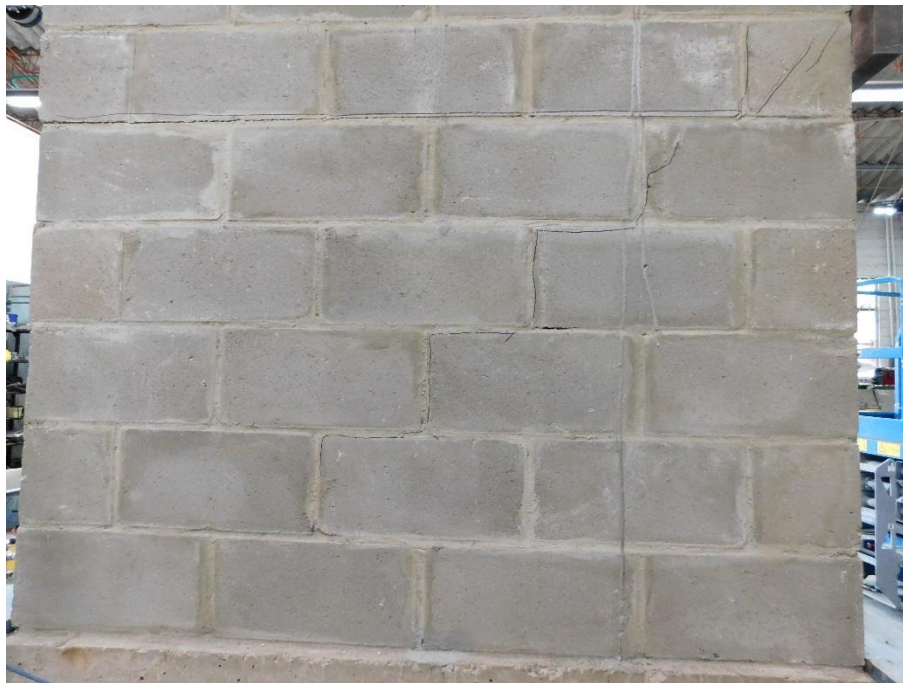
Fotografía 5.71 Fisuras de la parte inferior en la cara posterior
