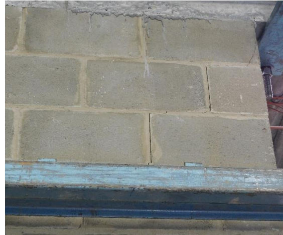
Fotografía 5.48 Fisuras de la parte superior derecha en la cara frontal
