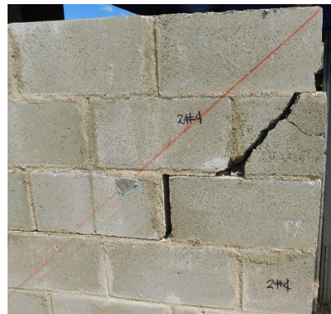
Fotografía 5.31 Fisuras de la parte superior derecha en la cara posterior
