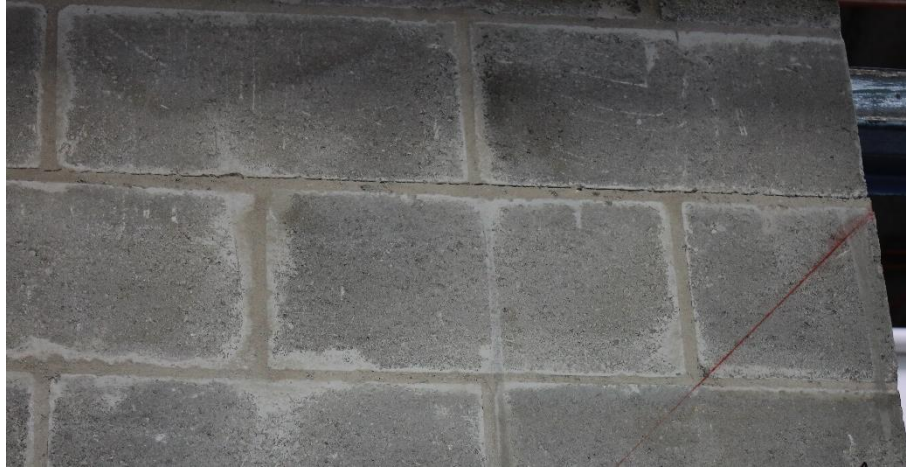
Fotografía 5.53 Línea de falla entre las hiladas 8 y 9 de la parte derecha en la cara frontal
