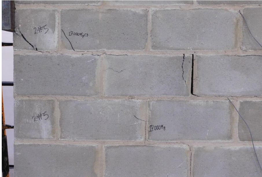
Fotografía 5.85 Fisuras de la parte inferior izquierda en la cara frontal
