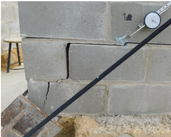
Fotografía 5.9 Fisuras de la parte inferior izquierda en la cara frontal
