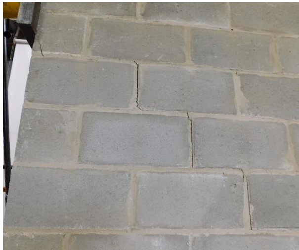
Fotografía 5.42 Fisuras de la parte central izquierda en la cara frontal
