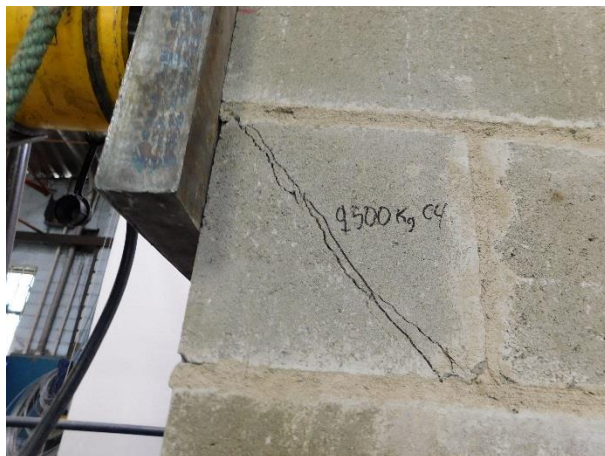
Fotografía 5.61 Fisuras en el bloque de la hilada 6 de la cara frontal
