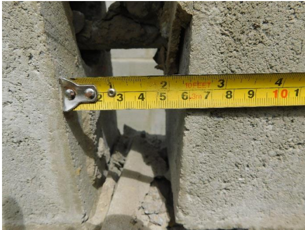
Fotografía 5.37 Desplazamiento horizontal de aproximadamente 6 cm/
