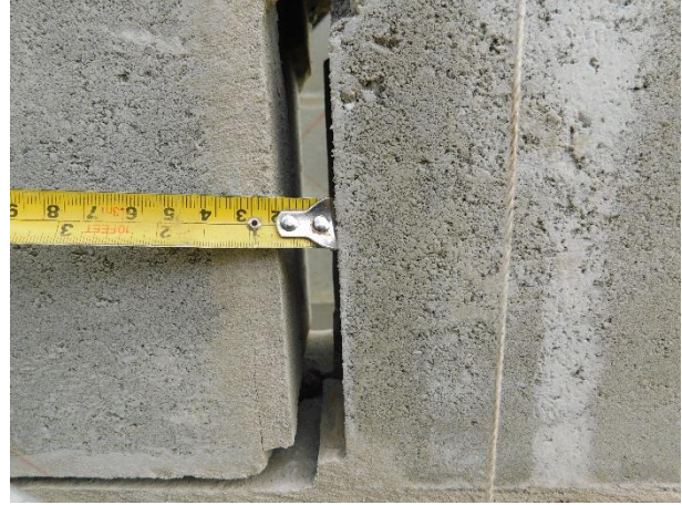
Fotografía 5.12 Desplazamiento horizontal de aproximadamente 2 cm/
