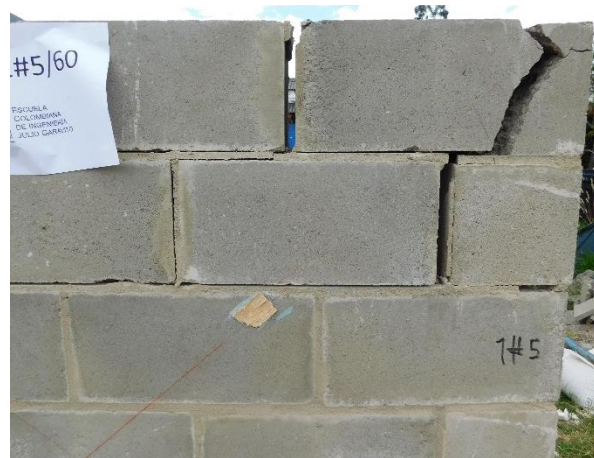
Fotografía 5.20 Fisuras de la parte superior derecha en la cara frontal
