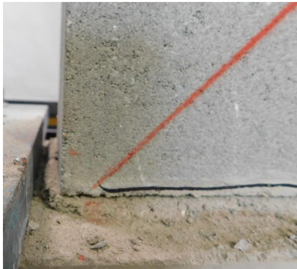
Fotografía 5.81 Desprendimiento del primer bloque de mampostería entre la primera hilada y la viga de cimentación en la cara frontal
