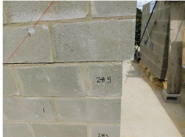
Fotografía 5.38 Desplazamiento horizontal en la parte derecha de la cara frontal/
