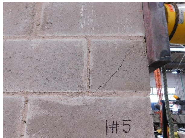
Fotografía 5.62 Fisuras en el bloque de la hilada 6 de la cara posterior
