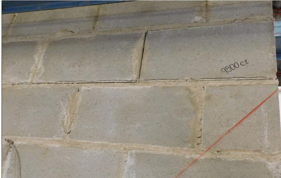
Fotografía 5.78 Línea de falla entre las hiladas 8, 9 y 10 de parte derecha en la cara frontal
