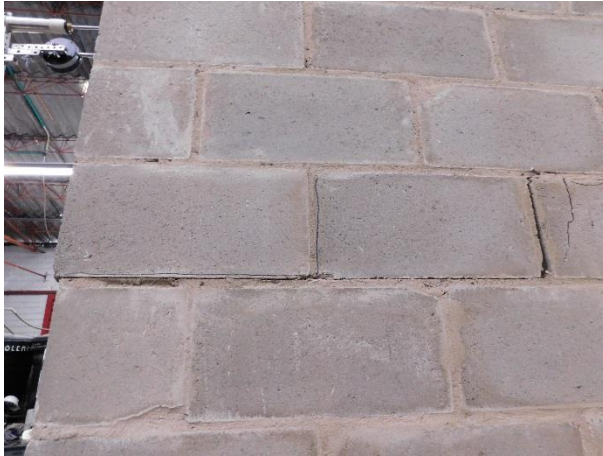
Fotografía 5.90 Fisuras en la parte izquierda de la cara posterior
