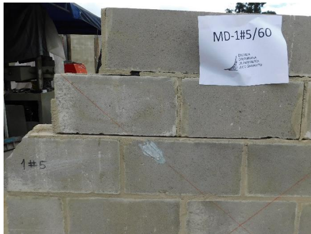
Fotografía 5.19 Fisuras de la parte superior izquierda en la cara frontal
