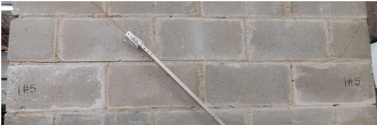
Fotografía 5.58 Línea de falla entre las hiladas 5 y 6 en la cara posterior
