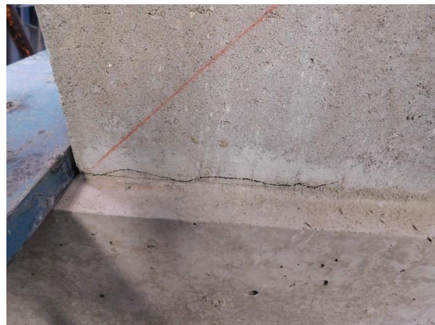
Fotografía 5.64 Desprendimiento del primer bloque de mampostería entre la primera hilada y la viga de cimentación
