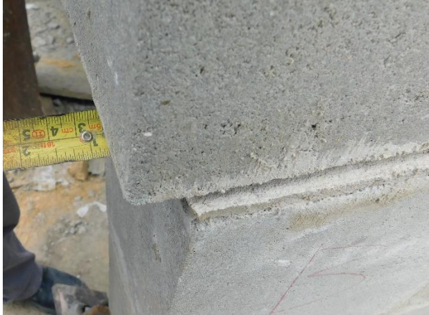
Fotografía 5.32 Desplazamiento horizontal de aproximadamente 2 cm/
