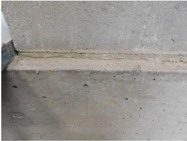
Fotografía 5.87 Desprendimiento del primer bloque de mampostería entre la primera hilada y la viga de cimentación en la cara frontal
