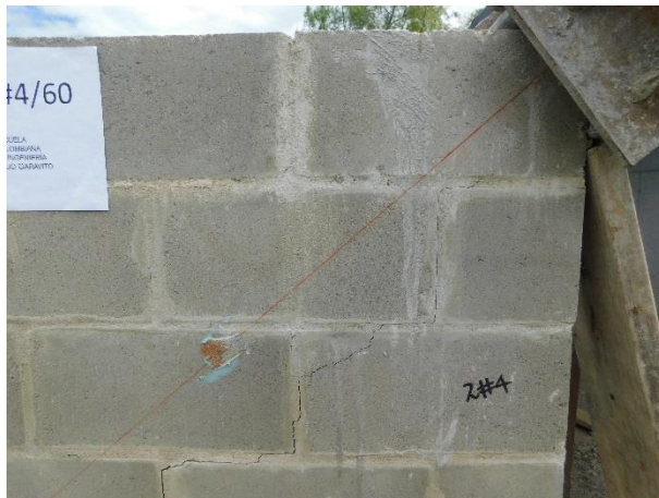
Fotografía 5.24 Fisuras de la parte superior derecha en la cara frontal
