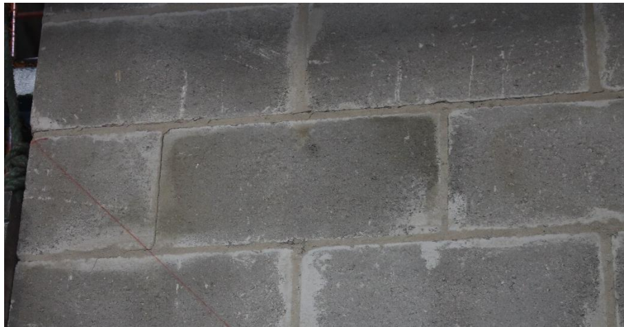
Fotografía 5.52 Línea de falla entre las hiladas 8 y 9 de la parte izquierda en la cara frontal
