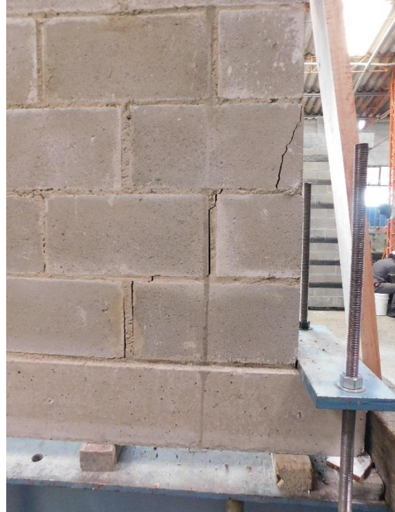
Fotografía 5.51 Fisuras de la parte inferior derecha en la cara posterior
