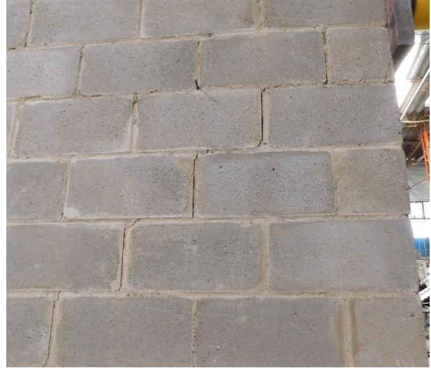
Fotografía 5.45 Fisuras de la parte inferior derecha en la cara posterior
