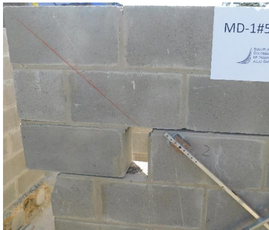
Fotografía 5.14 Fisuras de la parte superior izquierda en la cara frontal
