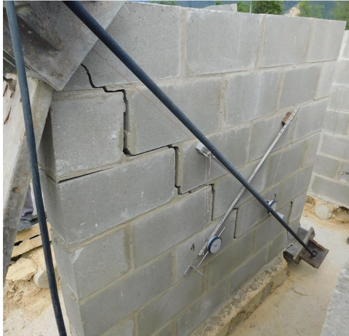
Fotografía 5.8 Fisuras en la cara posterior del muro MD-C
