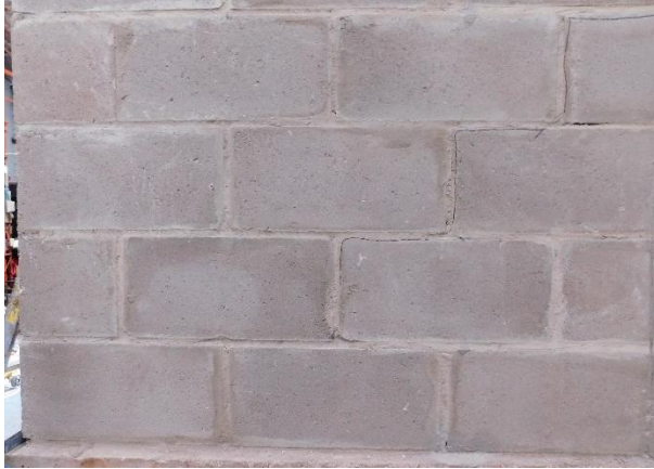
Fotografía 5.72 Fisura escalonada de la parte inferior izquierda en la cara posterior
