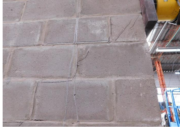
Fotografía 5.73 Fisura escalonada de la parte inferior derecha en la cara posterior
