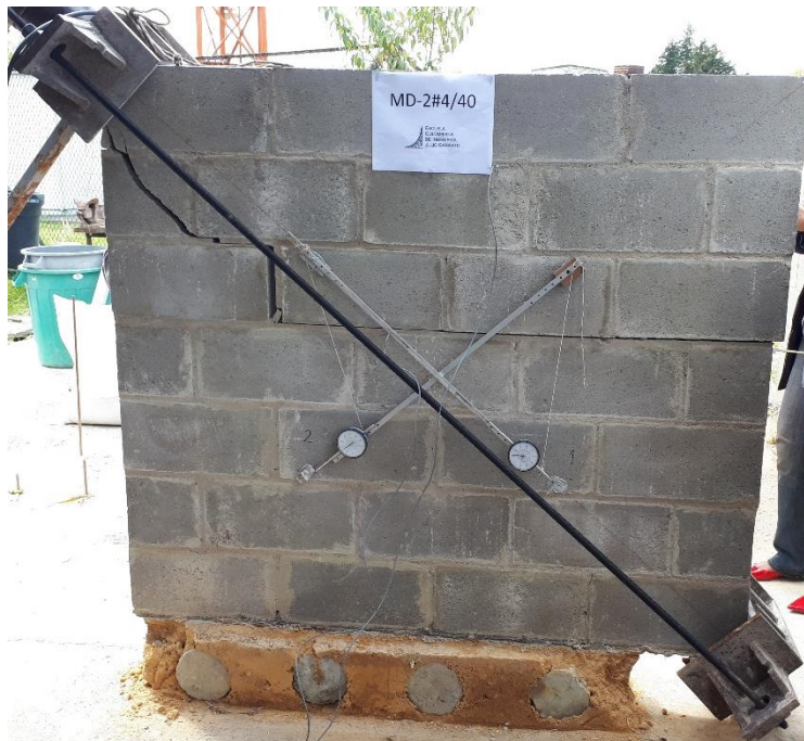
Fotografía 5.28 Fisuras en la cara frontal del muro MD-2#4/40
