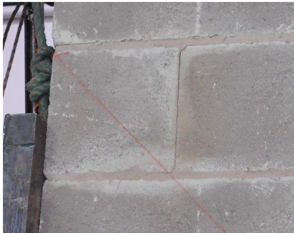
Fotografía 5.54 Tensión de junta vertical entre el primer y segundo bloque de la hilada 8 en la cara frontal
