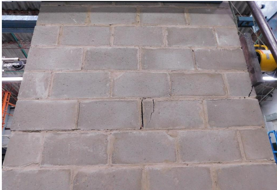
Fotografía 5.89 Fisuras en la cara posterior del muro MC-2#5/40
