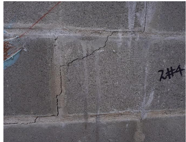
Fotografía 5.27 Fisuras en el bloque de la hilada 5 de la cara frontal
