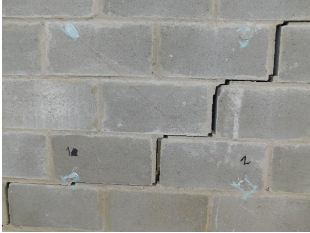
Fotografía 5.11 Fisuras de la parte central de la cara frontal
