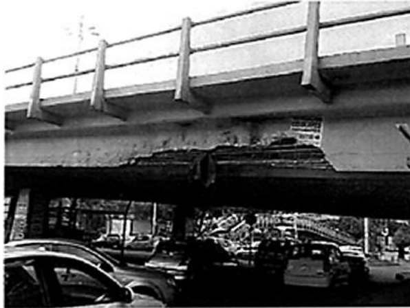
Figura 92. Acero de refuerzo expuesto en viga ( www.idu.gov.co )
