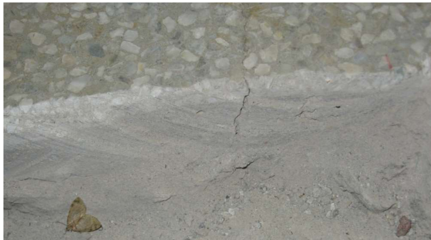
Figura 67. Fisura en plaqueta de acabado (archivo propio)
