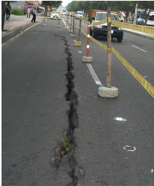
Figura 162. Grieta de la estructura del pavimento vía adyacente (archivo parque industrial)
