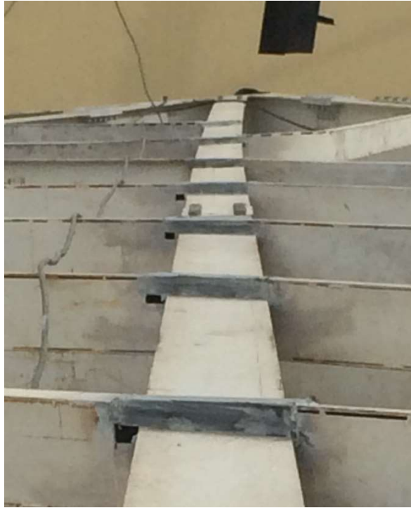
Figura 80. Detalle de viga secundaria torcida (archivo propio)
