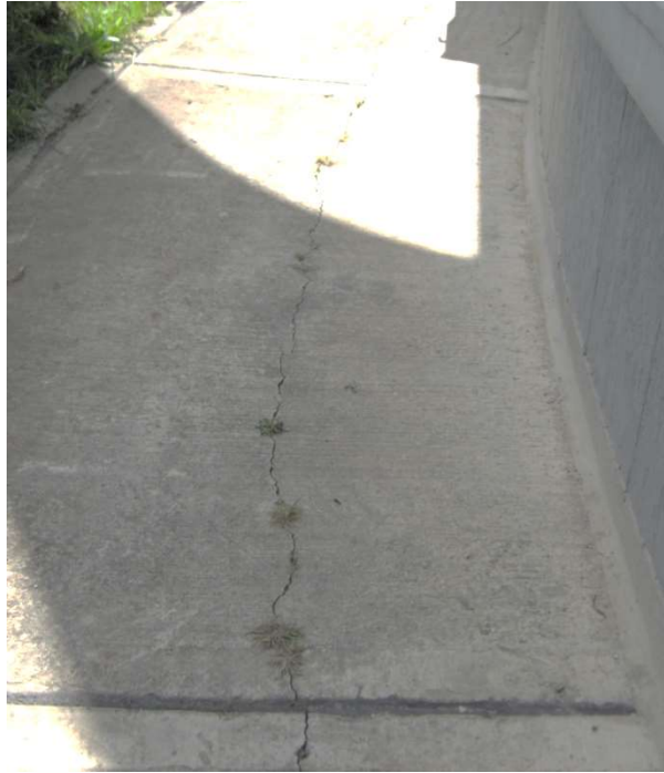
Figura 76. Fisuras y grietas en andén perimetral caseta de bombas (archivo propio)
