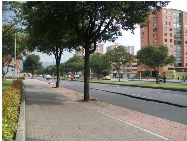
Figura 163. Hundimientos del andén adyacente (archivo parque industrial)
