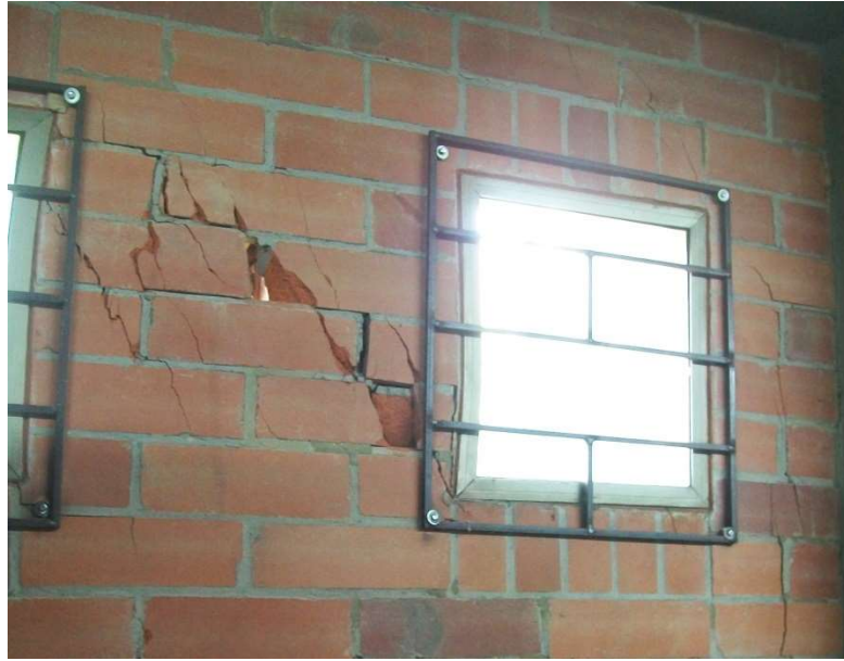
Figura 152. Fisuras y grietas cercanas a ventanas (archivo parque industrial)
