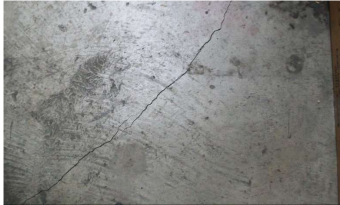
Figura 160. Fisura en placa de piso (archivo parque industrial)
