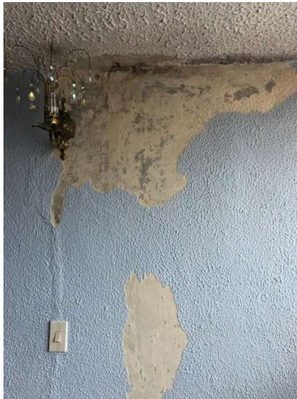
Figura 87. Deterioro generado por la humedad (archivo propio)
