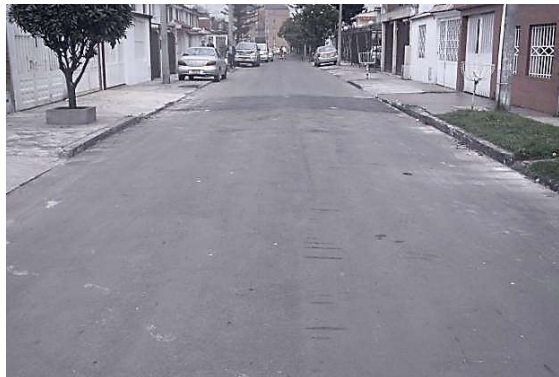
Figura 113. Defectos en la carpeta asfáltica (archivo propio)
