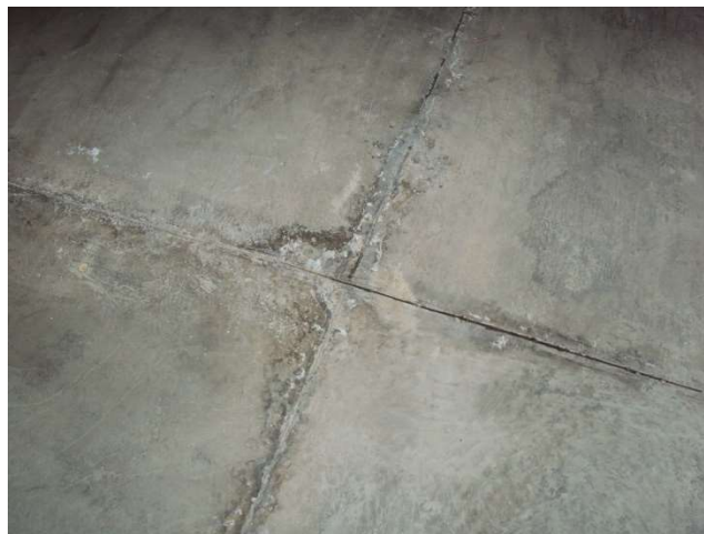
Figura 38. Eflorescencias en juntas de sobre placas (archivo propio)
