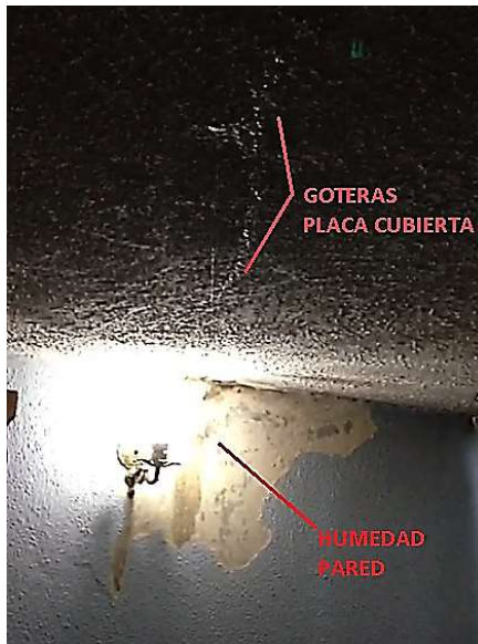
Figura 86. Goteras en el techo y mancha de humedad en la pared (archivo propio)
