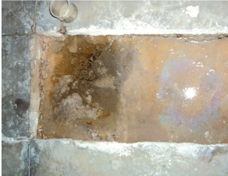
Figura 43. Perforación en la placa de contrapiso con presencia de nivel freático (archivo propio)
