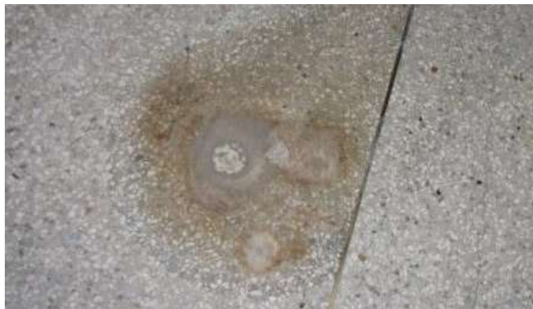
Figura 75. Efecto de goteras sobre el acabado de placa (archivo propio)
