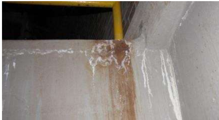
Figura 74. Corrosión de anclajes de baranda (archivo propio)
