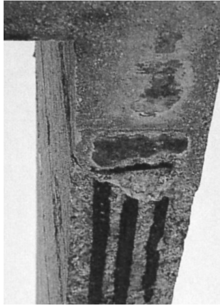
Figura 13. Daños por carbonatación en concreto reforzado (Broto, 2005).
