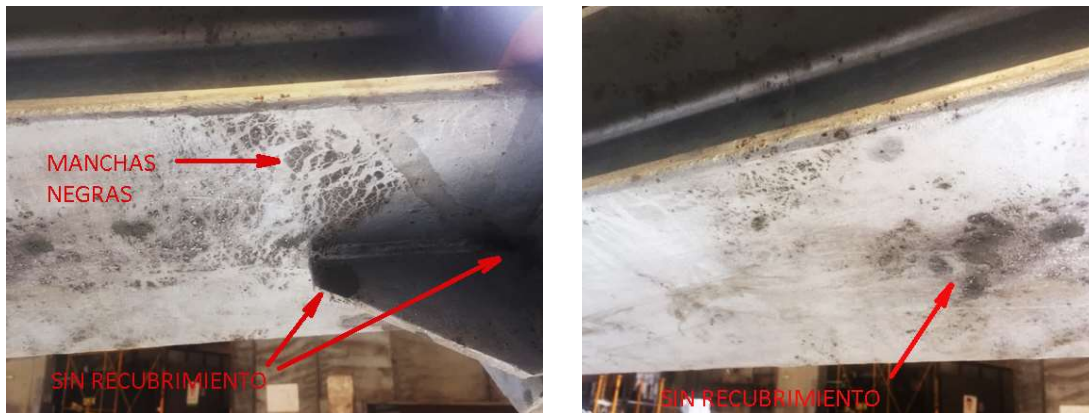
Figura 171. Manchas negras y ausencia de recubrimiento (archivo propio)
