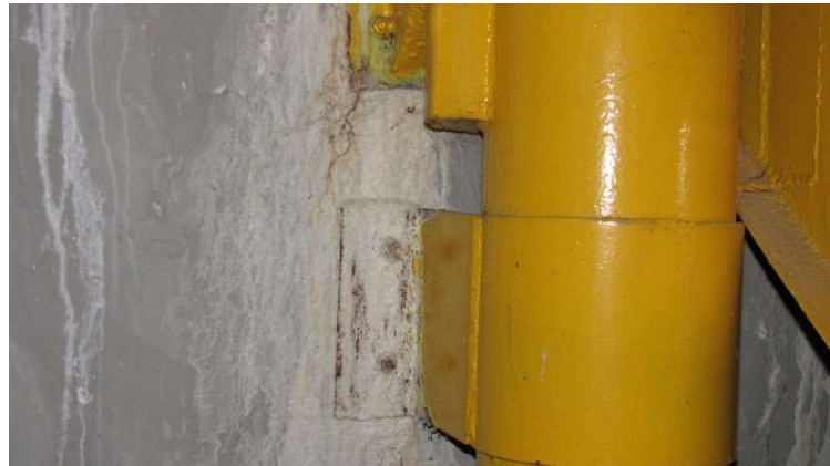
Figura 71. Corrosión de elementos metálicos de escalera (archivo propio)
