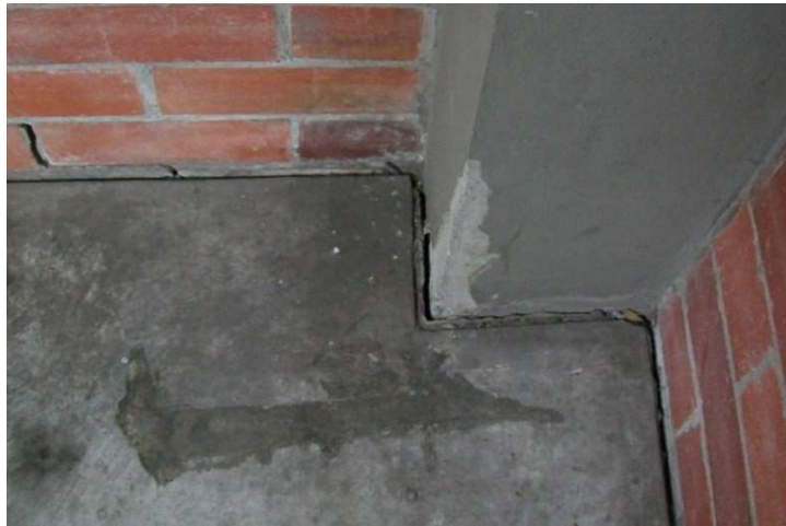
Figura 158. Abertura en junta entre placa de piso y muro (archivo parque industrial)
