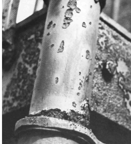
Figura 12. Corrosión de una estructura metálica (Broto, 2005).
