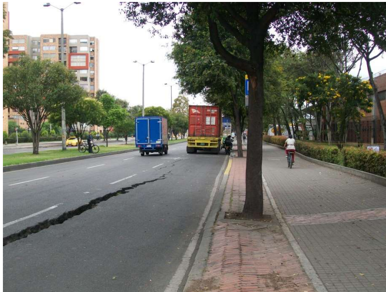
Figura 161. Daños en vía adyacente (archivo parque industrial)
