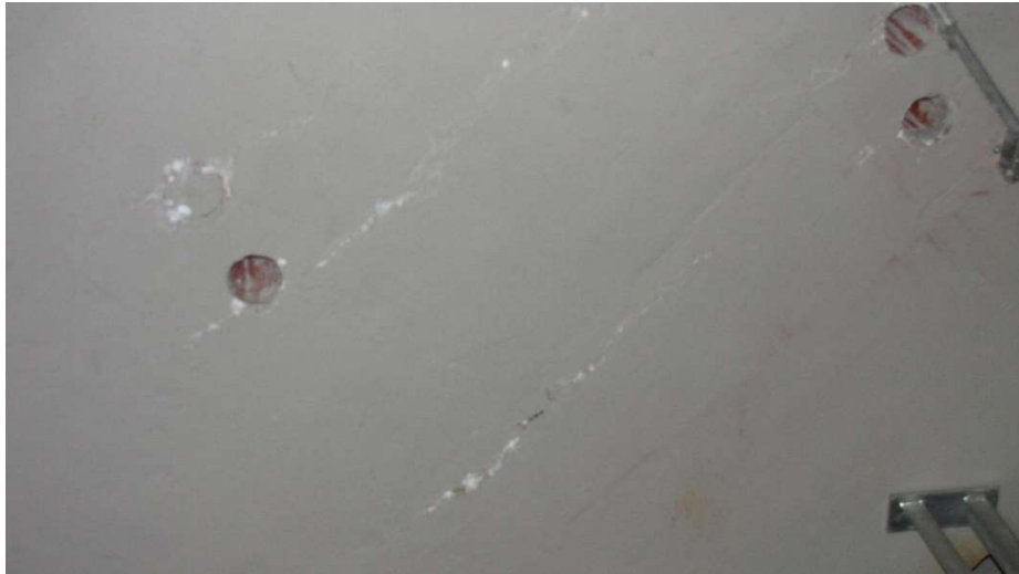
Figura 66. Eflorescencias cara inferior de placas (archivo propio)
