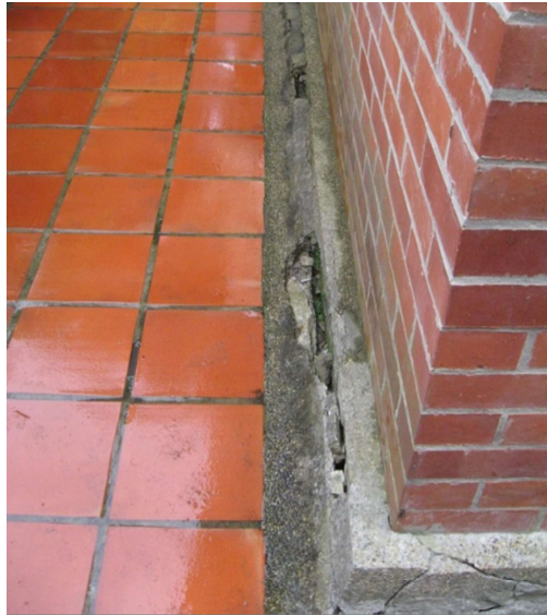
Figura 25. Desplazamiento de placa de piso respecto al muro (archivo propio)
