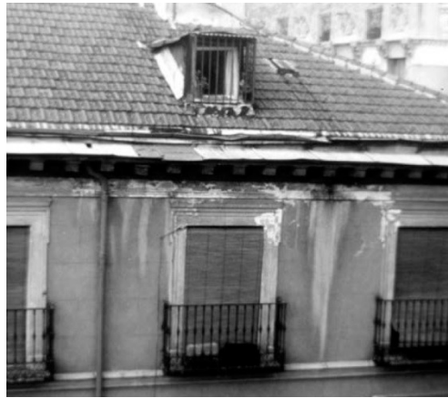
Figura 11. Humedad debida a perdida de bajante de aguas lluvias (López, Rodríguez, Santa Cruz, et al, 2004).
