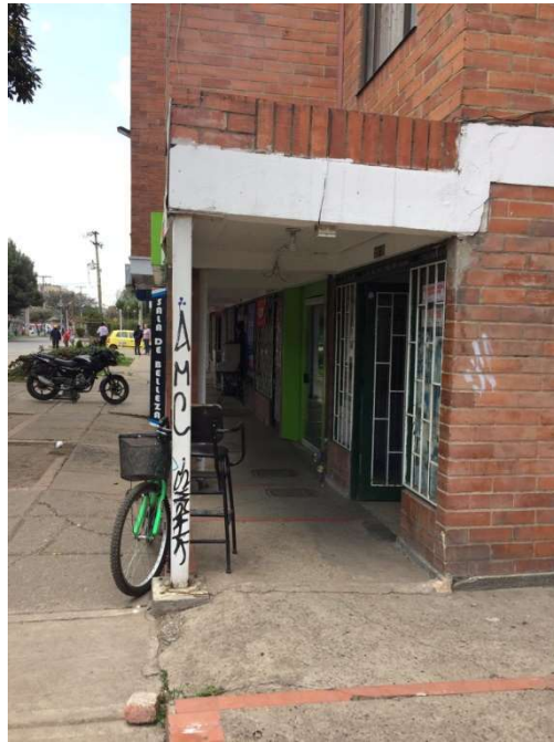
Figura 121. Detalle desnivel sentido transversal cubiertas (archivo propio)
