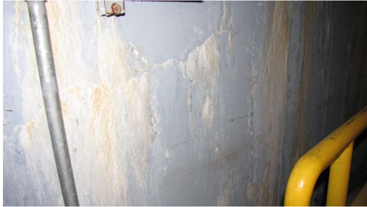
Figura 70. Eflorescencias que se originan en fisuras de los muros pantalla (archivo propio)
