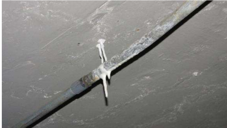
Figura 73. Lixiviados en el concreto de la placa (archivo propio)
