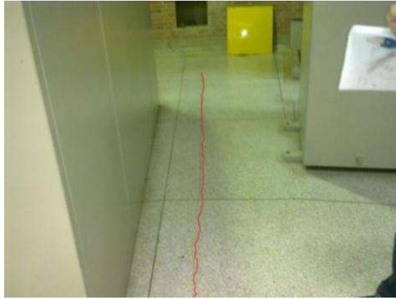
Figura 58. Fisura cercana a equipo hidro-reóstato (archivo propio)
