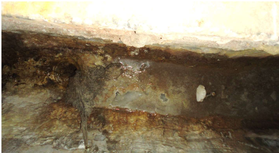
Figura 69. Agua acumulada en canales perimetrales (archivo propio)
