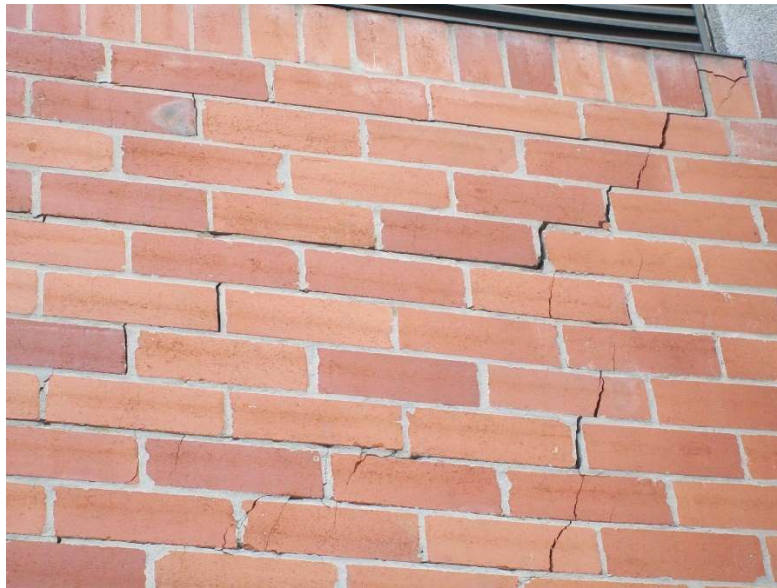
Figura 153. Fisura en diagonal en la fachada (archivo parque industrial)
