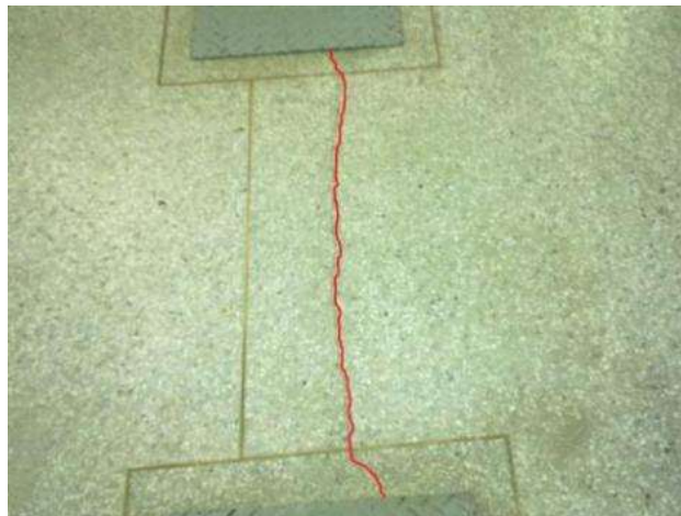
Figura 57. Fisura entre aberturas de placa (archivo propio)
