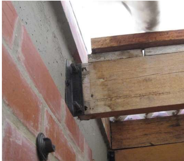
Figura 29. Perforaciones de conexión de correa fuera de lugar (archivo propio)
