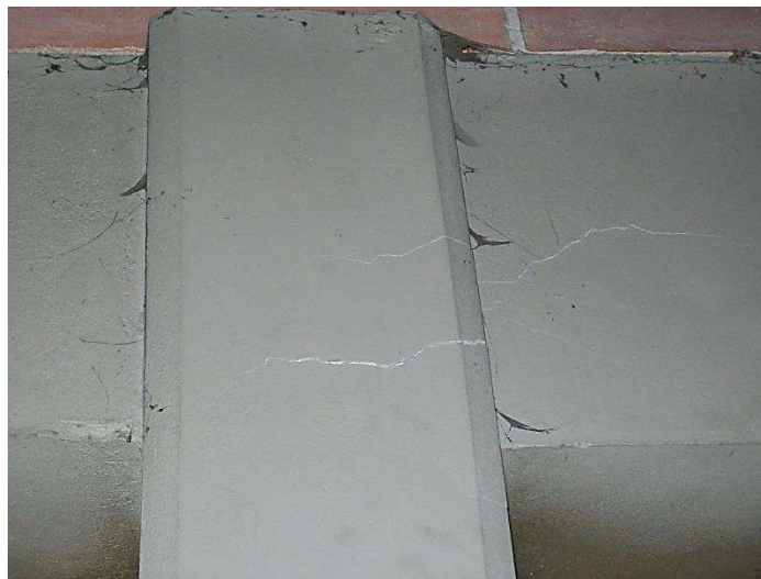
Figura 159. Fisuras transversales en cabeza de columna (archivo parque industrial)
