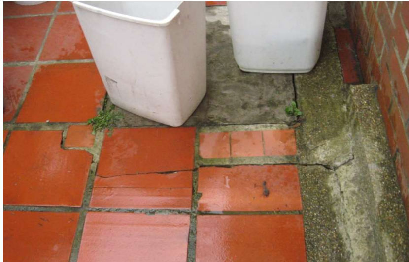
Figura 28. Fisura alrededor de caja de inspección (archivo propio)
