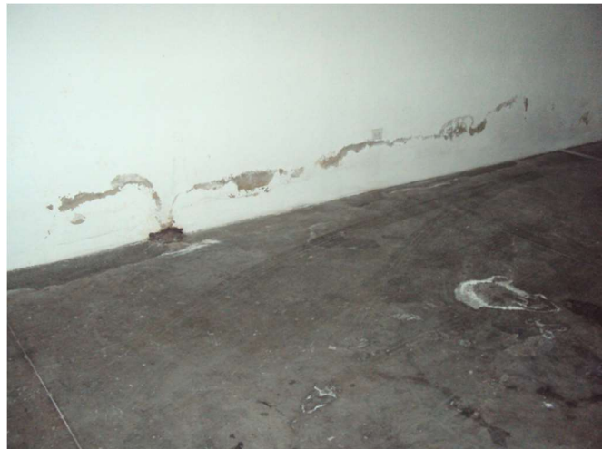
Figura 41. Manchas de humedad en muros de limpieza (archivo propio)
