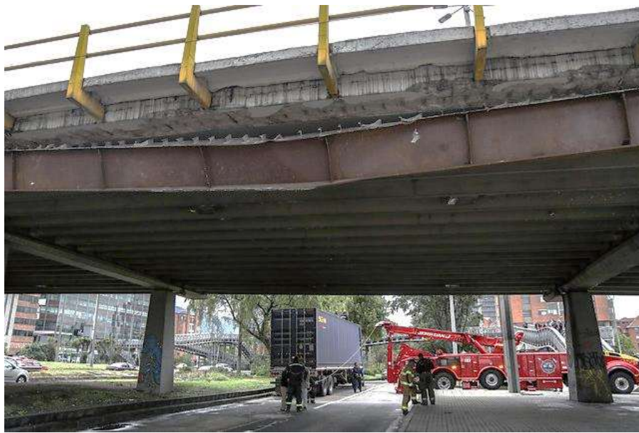
Figura 93. Daño en viga metálica por impacto de vehículo de carga ( www.lafm.com.co )
