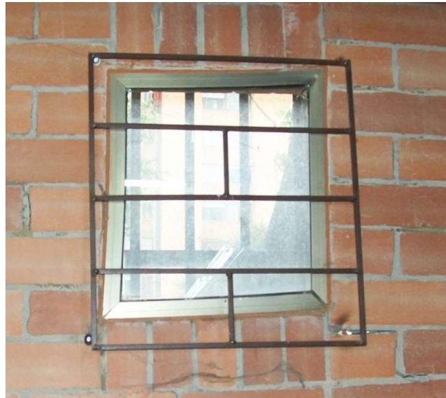
Figura 155. Marco de ventana torcido (archivo parque industrial)
