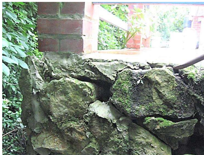
Figura 32. Desplazamiento lateral de muro en piedra (archivo propio)
