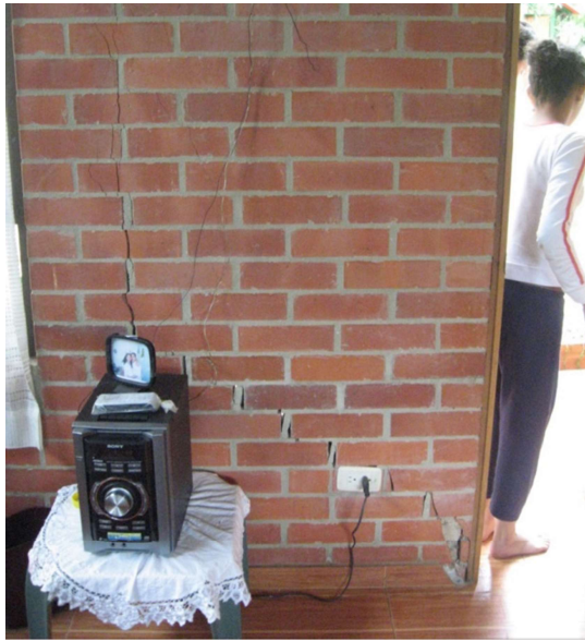
Figura 23. Fisuras y grietas fachada principal costado occidental (archivo propio)
