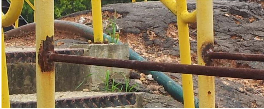
Figura 141. Daños por procesos de soldadura en elementos existentes (archivo contratista)
