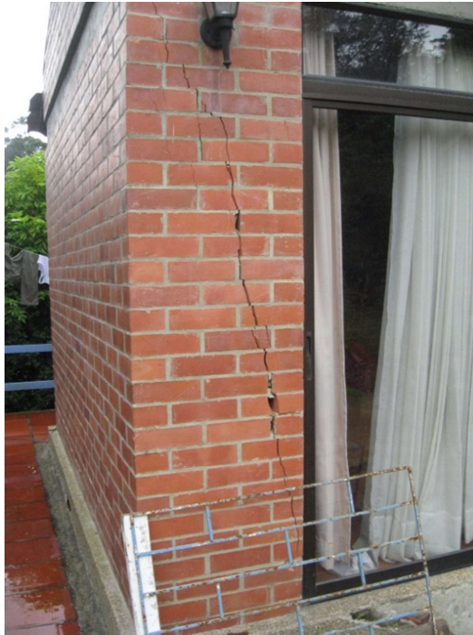
Figura 21. Grieta en fachada principal costado oriental (archivo propio)
