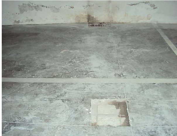
Figura 46. Presencia de agua que al parecer se filtra a través de las junta de la sobre placa y por el muro de limpieza (archivo propio)
