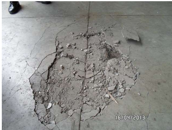
Figura 109. Falla de placa de contrapiso (archivo propio)
