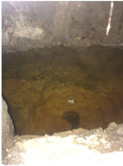
Figura 40. Drenajes obstruidos al interior de los muros de limpieza (archivo propio)
