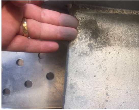
Figura 173. Reparación inicial con producto inadecuado (archivo propio)
