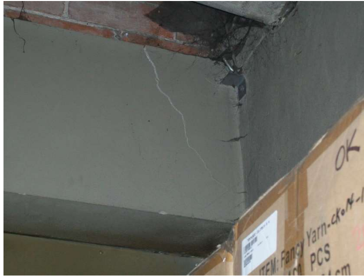
Figura 156. Fisura en diagonal unión viga columna (archivo parque industrial)
