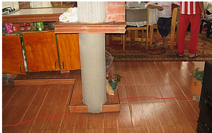
Figura 24. Fisuras en piso de acabado a lo largo de toda la casa (archivo propio)
