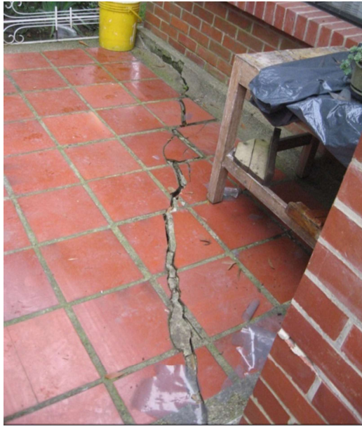
Figura 27. Grieta en placa de piso fachada posterior (archivo propio)
