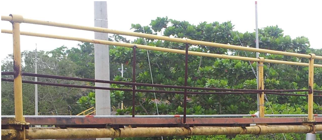
Figura 143. Falla en elementos de barandas (archivo contratista)
