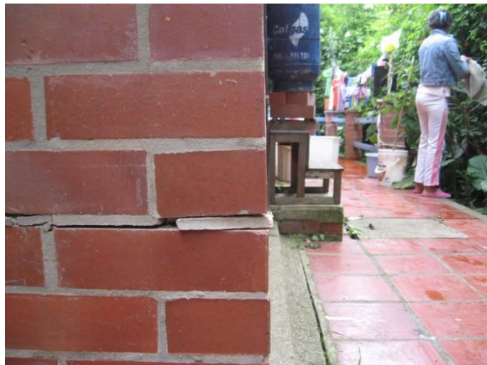
Figura 22. Grieta en fachada posterior costado occidental (archivo propio)
