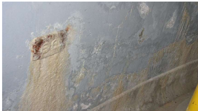
Figura 72. Daños en toma eléctrica y señales de lixiviados en el muro (archivo propio)
