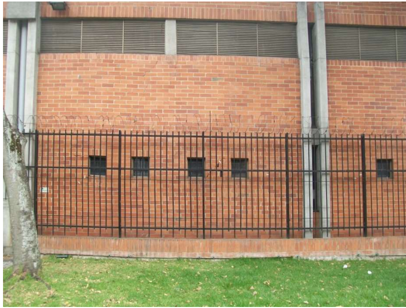
Figura 150. Deformación vertical diferencial de fachada (archivo parque industrial)
