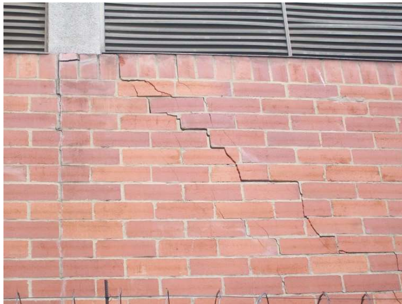
Figura 151. Fisuras y grietas en fachada (archivo parque industrial)
