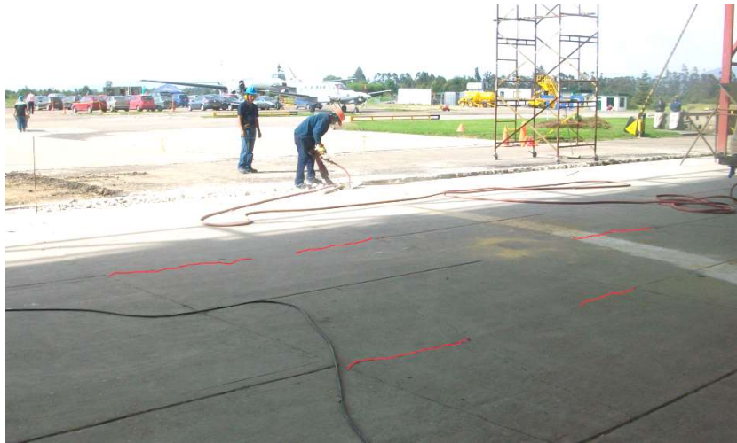
Figura 116. Fisuras en placa de piso (archivo propio)
