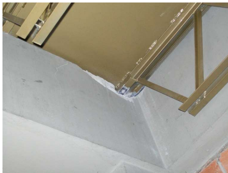
Figura 157. Desprendimiento de recubrimiento superior de viga (archivo parque industrial)
