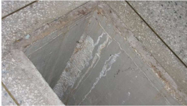
Figura 68. Filtración entre plaqueta de acabado y placa (archivo propio)
