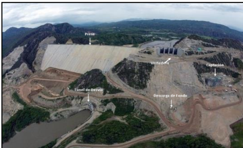
Fotografía 13.1. Presa CFRD y obras en el estribo derecho CHEQ. Fuente del autor.
