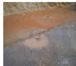
Fotografía 10.2. Resurgencias de agua en la perforación por efectos de la presión artesiana. Fuente del autor.
