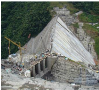
Fotografía 13.2. Presa CFRD Porce III. Tomado de "Descripción de obras Porce III". EPM, 2019.
