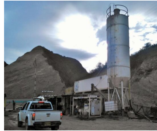
Fotografía 8.2. Planta estacionara de inyecciones. Fuente del autor.
