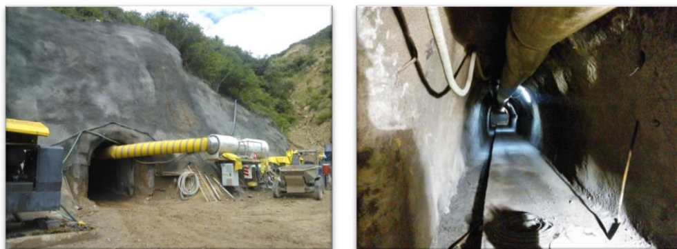
Fotografía 3.9. Galería de inyección desde el portal de entrada y dentro de la excavación. Fuente del autor.
