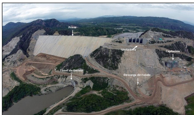
Fotografía 13.2. Presa y obras en el estribo derecho de la presa El Quimbo. Fuente del autor
