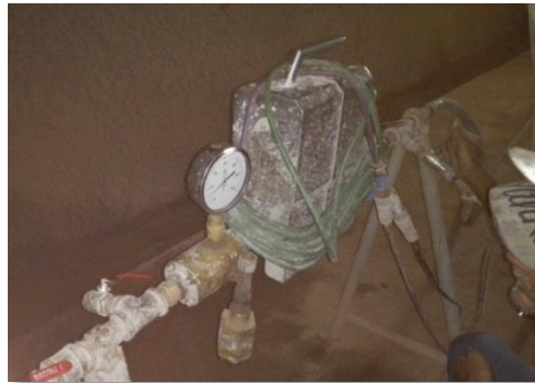
Fotografía 3.3. Manómetro de inyección utilizado en tratamiento de inyección. Fuente del autor.
