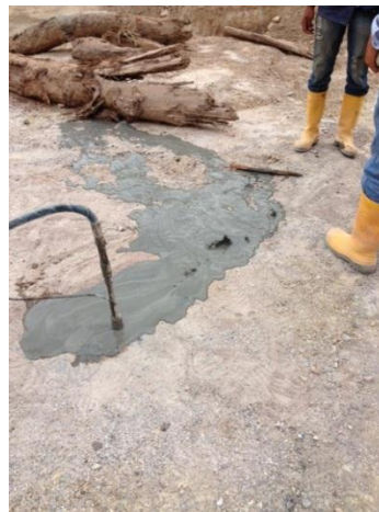
Fotografía 9.1. Resurgencias de mezcla de inyección en superficie Fuente del autor.
