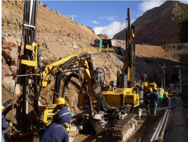
Fotografía 8.1. Perforadoras de rotación realizando procedimiento de perforación para inyecciones. Fuente del autor.
