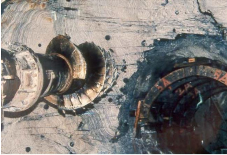
Fotografía 13.9. Excavación por medio de road header de la sección del túnel de fuga en sector tratado con inyecciones.
