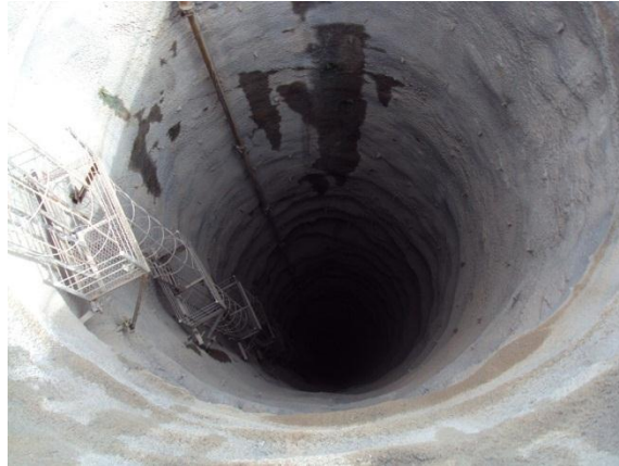
Fotografía 3.8. Excavación de pozo para compuertas de un túnel de conducción de agua. Fuente del autor.
