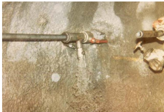
Fotografía 13.7. Uso del sistema Antiavalancha en el frente de excavación de la galería piloto.
