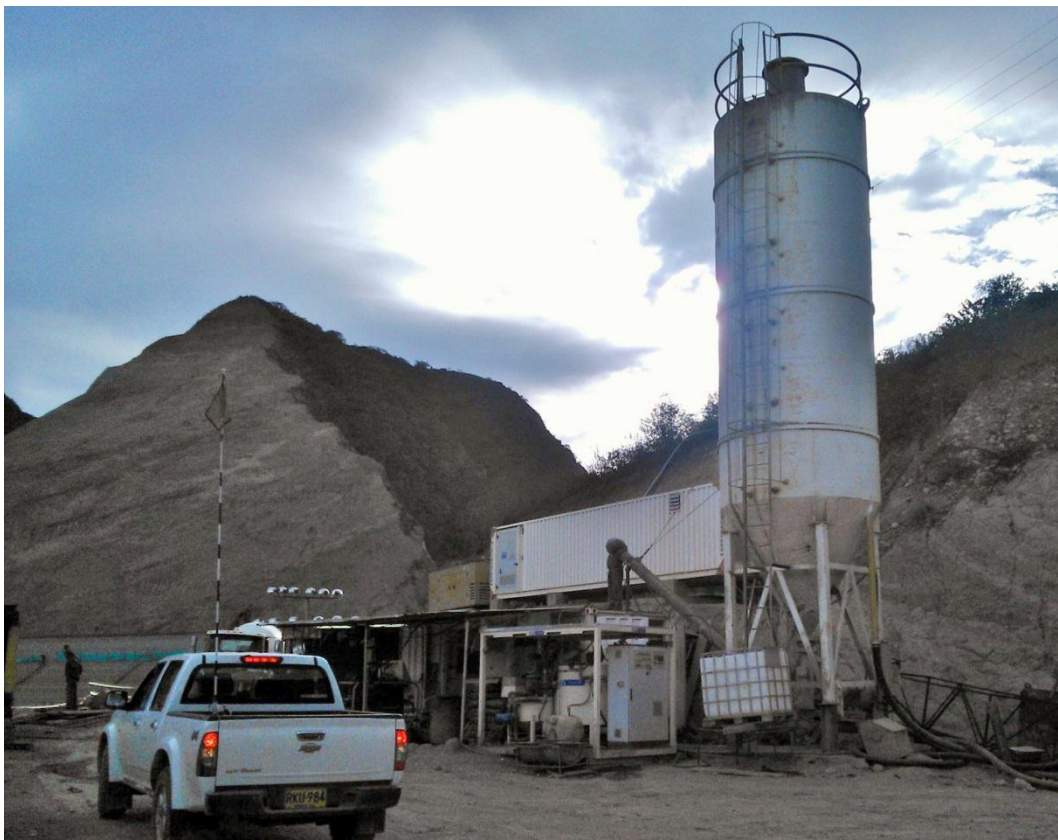
Fotografía 8.3. Planta estacionaria de inyecciones. Fuente del autor.
