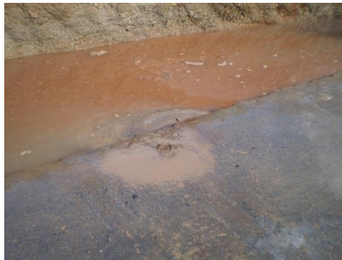
Fotografía 10.4. Resurgencias de agua en la perforación por efectos de la presión artesiana
