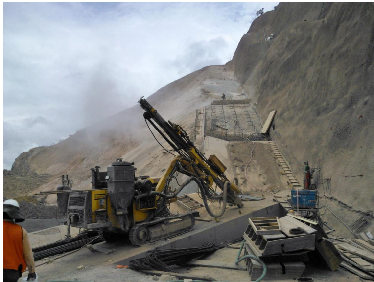
Fotografía 3.4. Perforación direccionada para tratamiento con inyecciones en el plinto de una presa CFRD. Fuente del autor.
