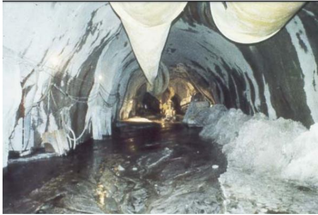
Fotografía 13.4. Flujos y avalanchas de material hacia la excavación en el túnel de fuga. Tomado de “Experiencias de excavación de túneles con métodos convencionales y maquinas TBM en la cordillera de los Andes. Casos históricos”. Marulanda, C. 2015.
