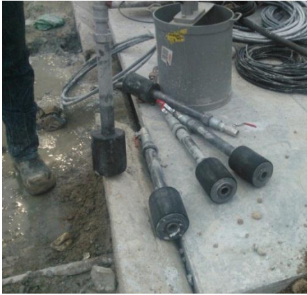
Fotografía 8.13. Empaques mecánicos. Fuente del autor.
