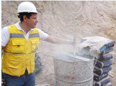
Fotografía 8.9. Preparación de mezcla de inyección a base de cemento. Fuente del autor.
