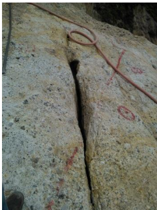
Fotografía 10.2. Cizallas abiertas por tratar con inyecciones desde superficie. Fuente del autor.
