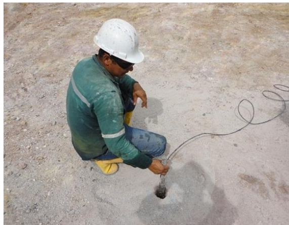
Fotografía 8.15. Colocación del empaque dentro de la perforación donde se realizará el procedimiento de inyección. Fuente del autor.
