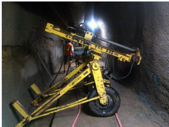
Fotografía 3.7. Perforación dirigida en túnel para perforación de huecos para inyecciones. Fuente del autor.
