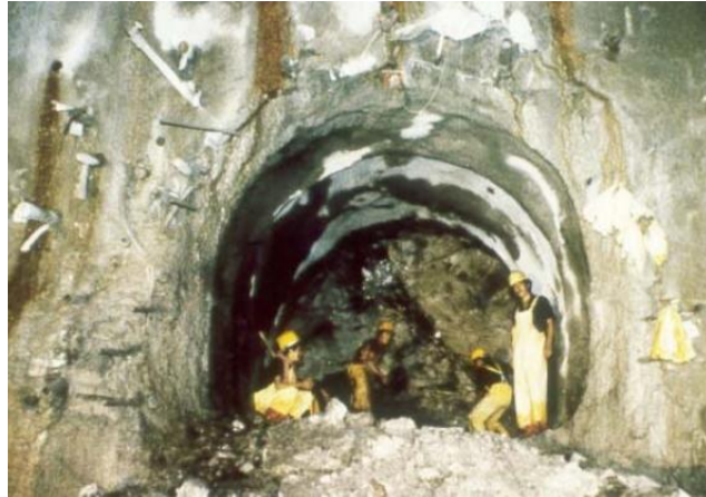
Fotografía 13.5. Excavación de galería piloto en el frente de excavación. Tomado de "Experiencias de excavación de túneles con métodos convencionales y maquinas TBM en la cordillera de los Andes. Casos históricos". Marulanda, C. 2015.
