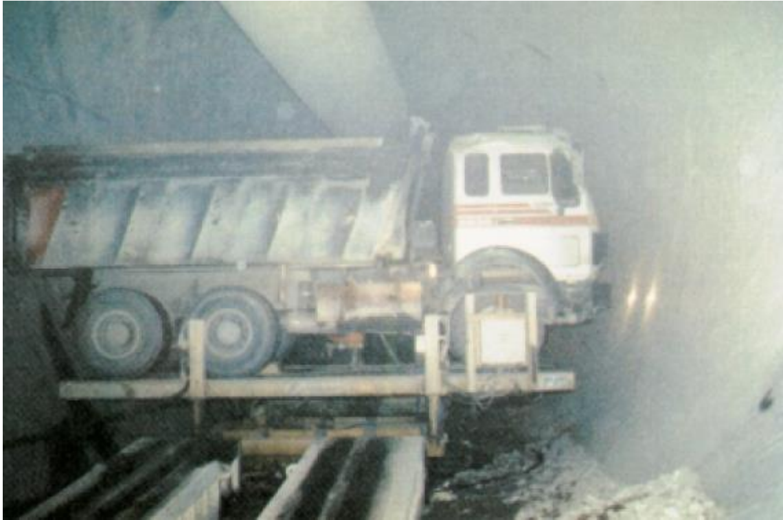
Ilustración 3 - 74: Mesa giratoria para camiones en un túnel de 8,5 m de diámetro. (Bruland, 2015).
