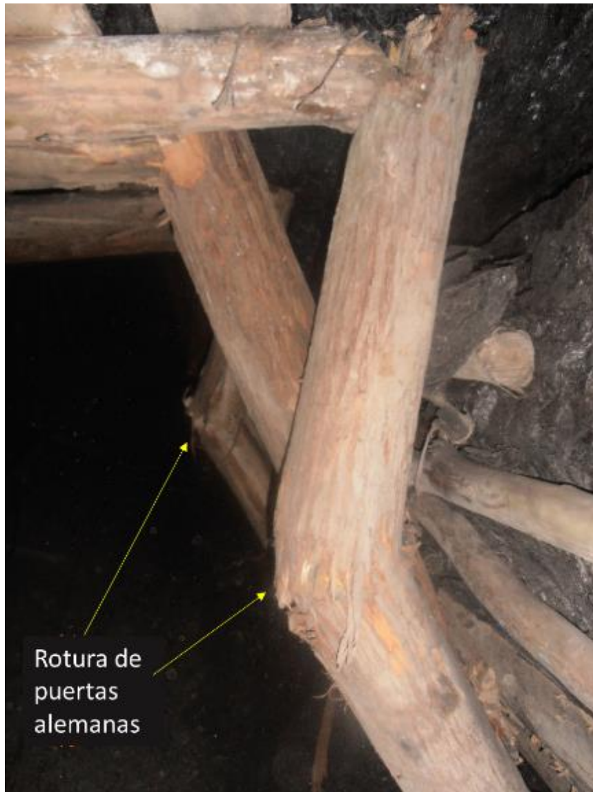
Foto 23. Rotura de las puertas de sostenimiento.
