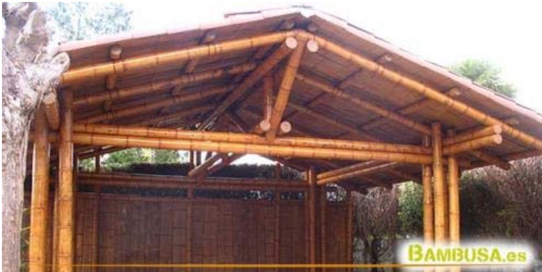
Fotografía 2.3. Estructura teóricamente inestable ante cargas laterales.
