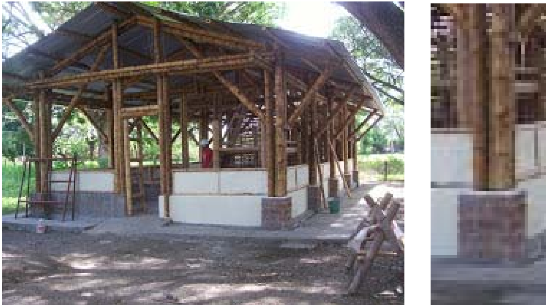
Fotografía 2.7 Estructura con columnas sin conexión rígida a su cimentación 4.
