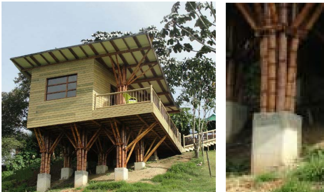
Fotografía 2.4. Estructura con columnas sin conexión rígida a su cimentación 1.
