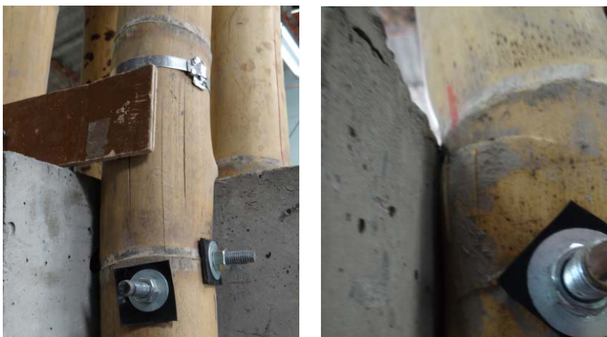
Fotografía 8.1 Aplastamiento contra el pedestal
