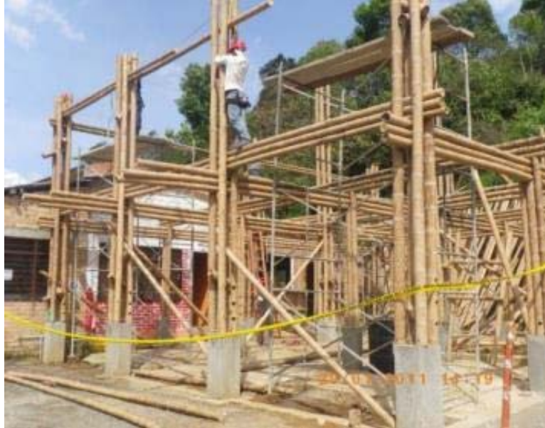
Fotografía 2.6 Estructura con columnas sin conexión rígida a su cimentación 3.
