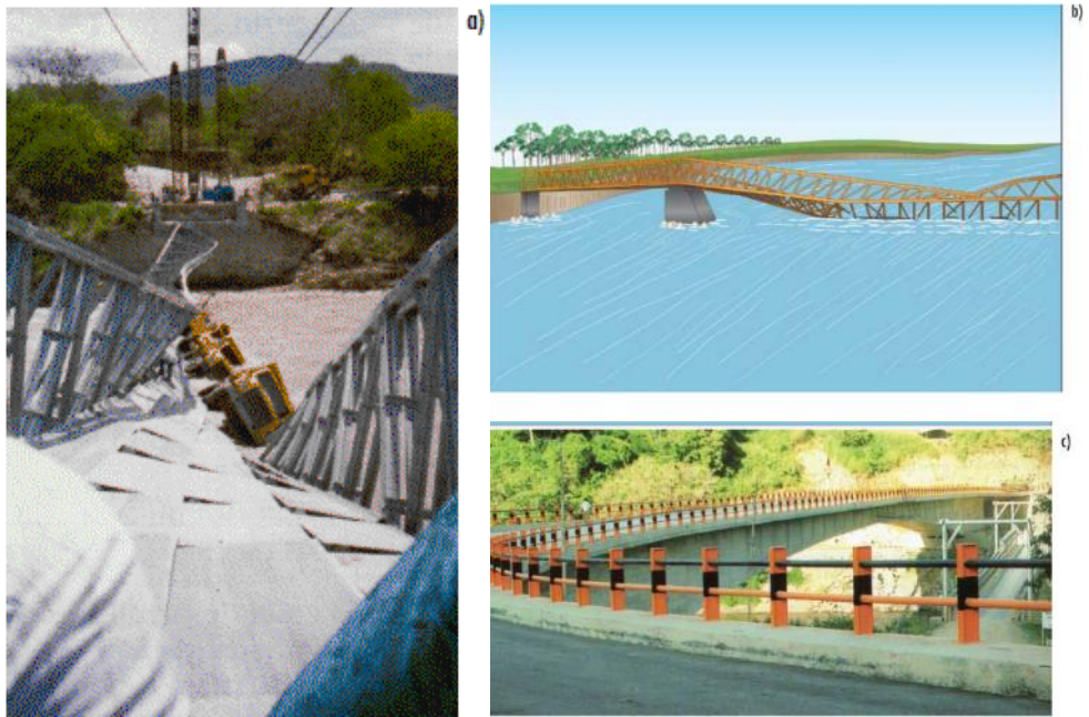
Figura 72. (a) y (b) Fotos del colapso del puente los Ángeles (Huila). Tablero de armadura de paso a través que falló por estabilidad lateral. (c) Solución después de su colapso en varias oportunidades. Puente provisional al lado que se construyó por el tercer colapso. Fuente: (a) y (b) Autorizado por (Universidad Nacional de Colombia, 1994). (c) tomada de la revista Notivías de julio de 1998.
