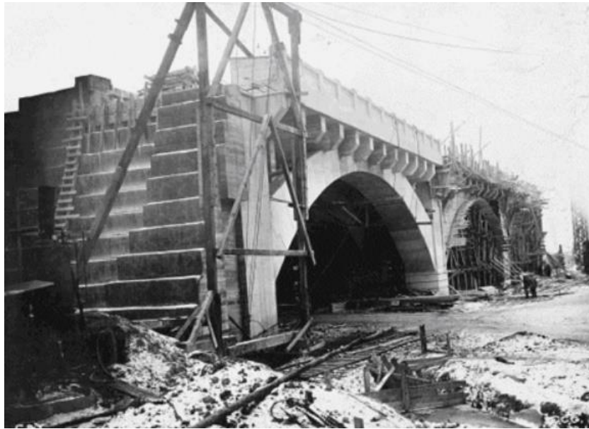
Figura 6. Lowe, Jet (1978). Puente de arco en hormigón - Cleveland del condado de Cuyahoga, Estados Unidos.
