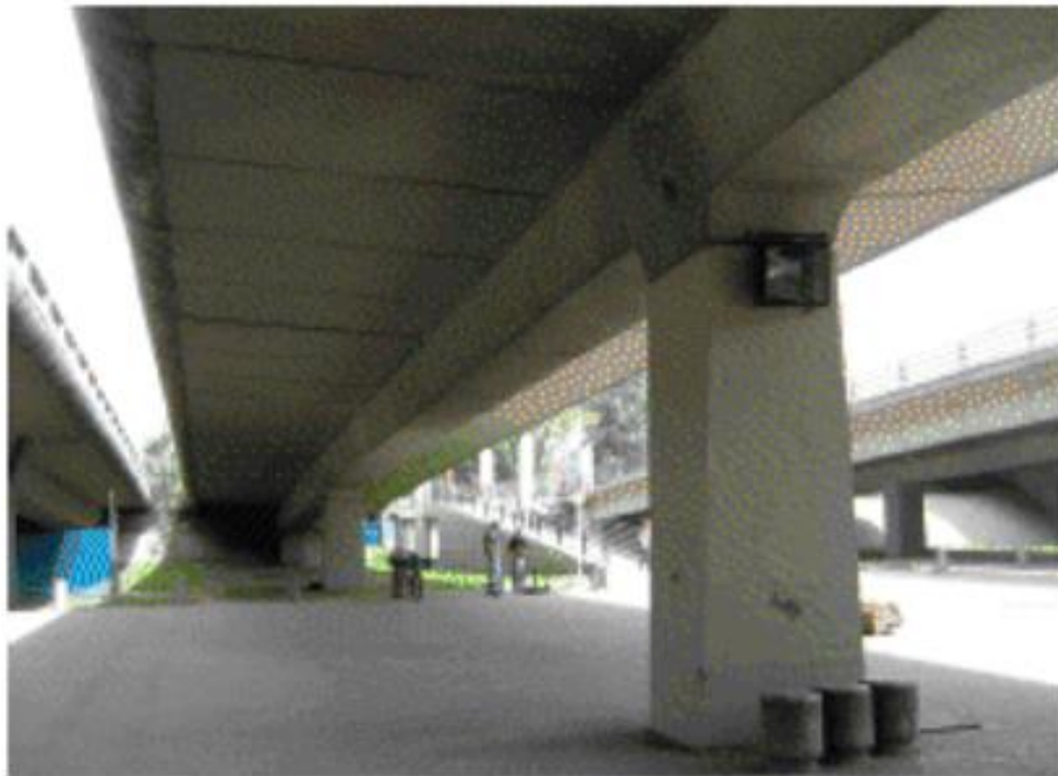
Figura 31. Tipología de sistema de entripiso vigas y losa. Vigas continuas de preesforzado. Puente de la Calle 26 Av. Boyacá (Bogotá). Fuente: (Muñoz, E., 2011)
