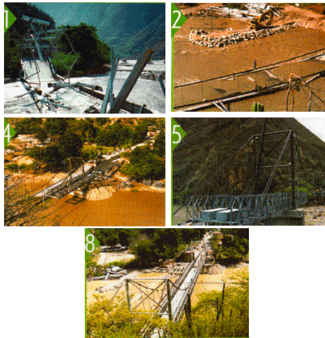
Figura 74. Ejemplo de puente colapsado por deficiencias estructurales. Puente Pescadero (Santander). (a) y (b) colapso, (c) y (d) construcción de puente provisional, (e) puente provisional definitivo.
