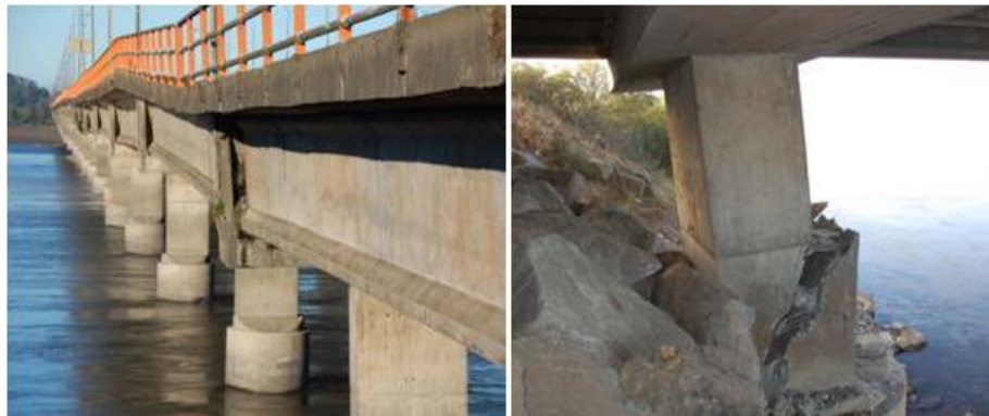
Figura 69. Puente vehicular Juan Pablo II (Chile) luego del colapso tras el sismo Fuente: (Kawashima, Unjoh, Hoshikuma, et al, 2010)
