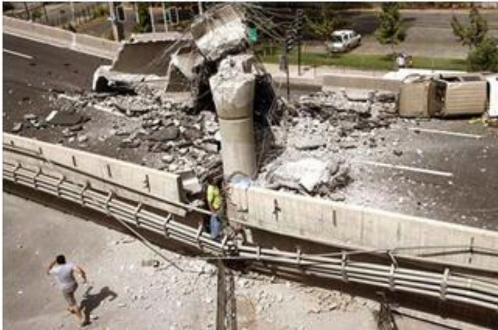
Figura 68. Puente vehicular Lo Echeveres (Chile) luego del colapso tras un terremoto Fuente: (Kawashima, Unjoh, Hoshikuma, et al, 2010)
