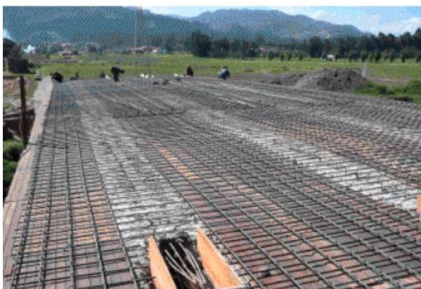
Figura 44. Después de terminadas la construcción de las cuatro vigas, construcción de la losa con su correspondiente refuerzo a flexión. Segundo tensionamiento desde la losa para la sección compuesta.
