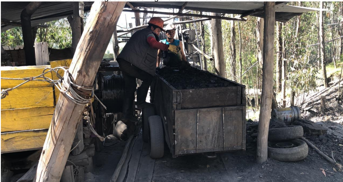
Ilustración 8. Llegada de las vagonetas a las tolvas de almacenamiento
