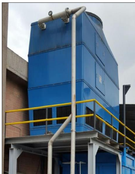
Figura 8 Torre de Enfriamiento, (Fuente: Manual de operaciones PTARII)
