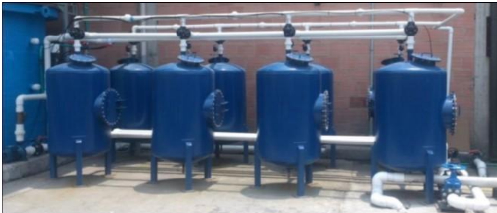
Figura 9 Tren de Filtración, (Fuente: Manual de operaciones PTARII).
