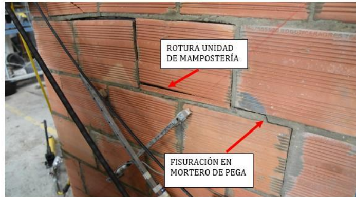
Figura 90. Rotura de unidad de mampostería y fisuración de mortero de pega por compresión diagonal.
