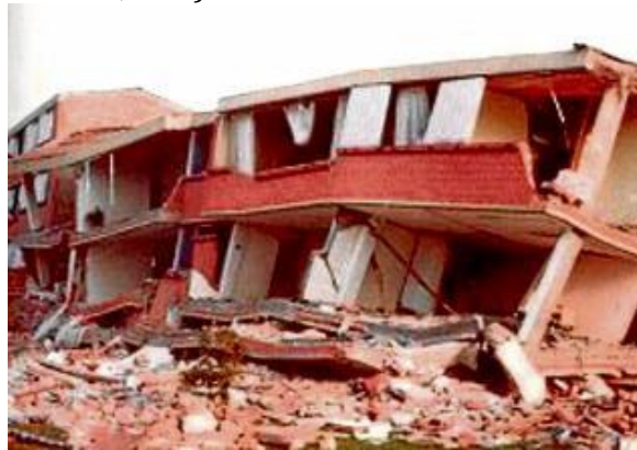
Figura 11. Vivienda en mampostería colapsada por terremoto de Popayán. Tomado de: https://www.eluniversal.com.co/colombia/yo-vivi-el-terremoto-de-popayan-cronica-de-un-sobreviviente-114188-BSEU201110
