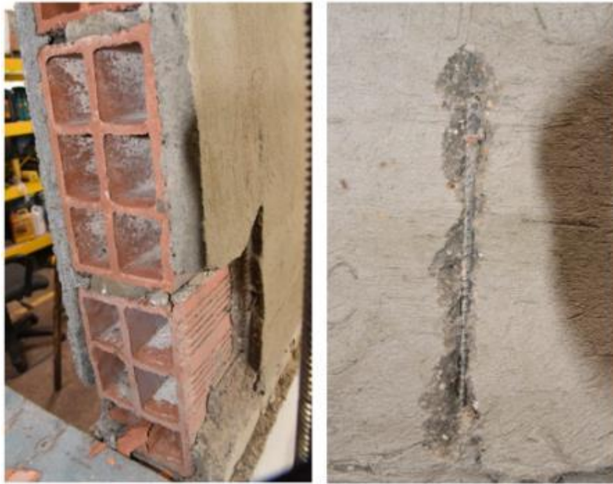
Figura 105. Fisuras en bloques de primera hilada; fisuración en zona de anclajes.
