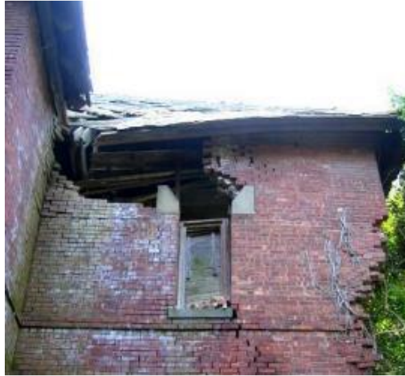
Figura 14. Colapso de muro de mampostería perimetral. Tomado de: https://inspectapedia.com/structure/Brick_Structure_Damage.php
