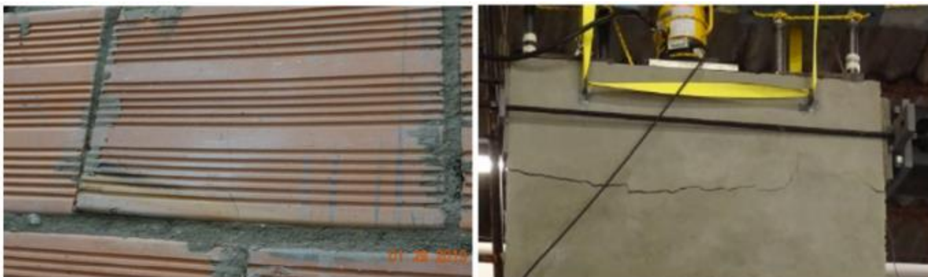
Figura 100. Fisuración en unidades de mampostería; fisuración en pañete de refuerzo en zona superior – MMP2 PD.
