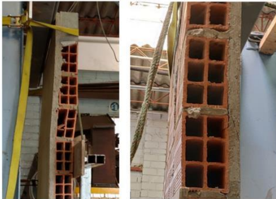
Figura 110. Falla en unidad de mampostería por flexión fuera del plano; Fisuración en pañete.
