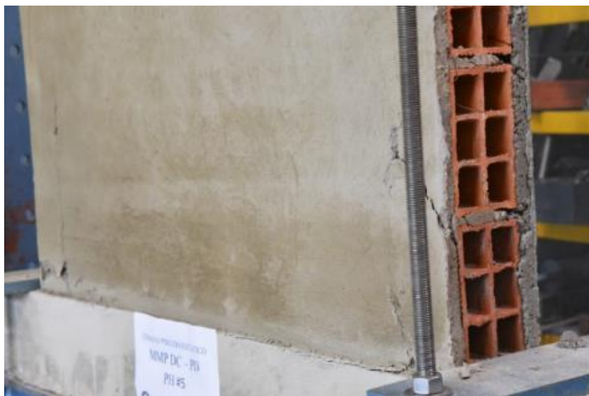
Figura 104. Fisuración de pañete en zonas de anclajes - MMP DC.
