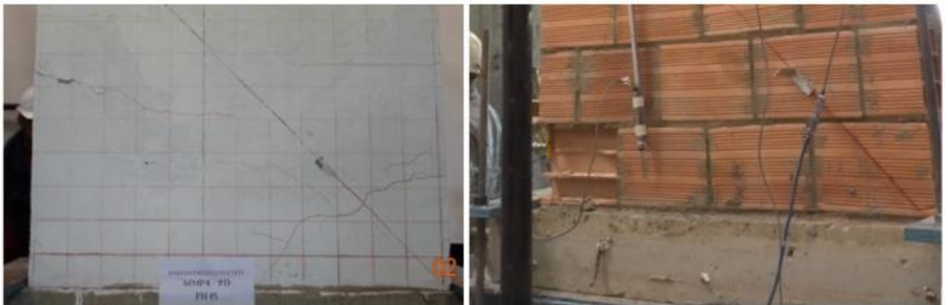
Figura 99. Fisuración en pañete de refuerzo en zona inferior del muro; rotura por compresión en unidad de mampostería - MMP4 PD.
