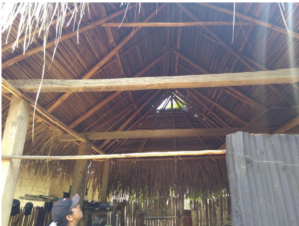
Fotografía 55. Techo empalmado cocina de M.C.
