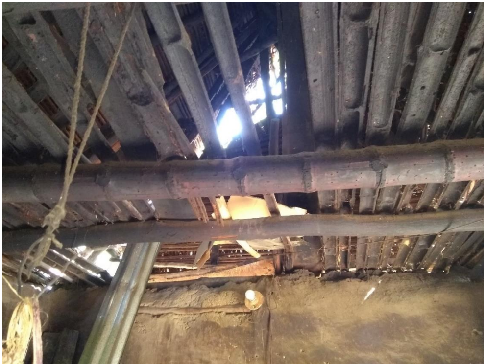
Fotografía 78. Techo en empalmado con cielo raso en guadua de cocina de E.C.D.
