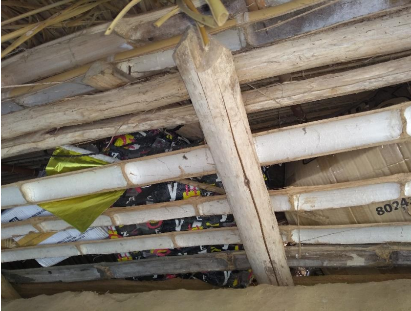
Fotografía 106. Viga transversal de casa de E.D.
