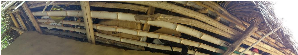
Fotografía 93. Ventilación en guadua casa de E.D.
