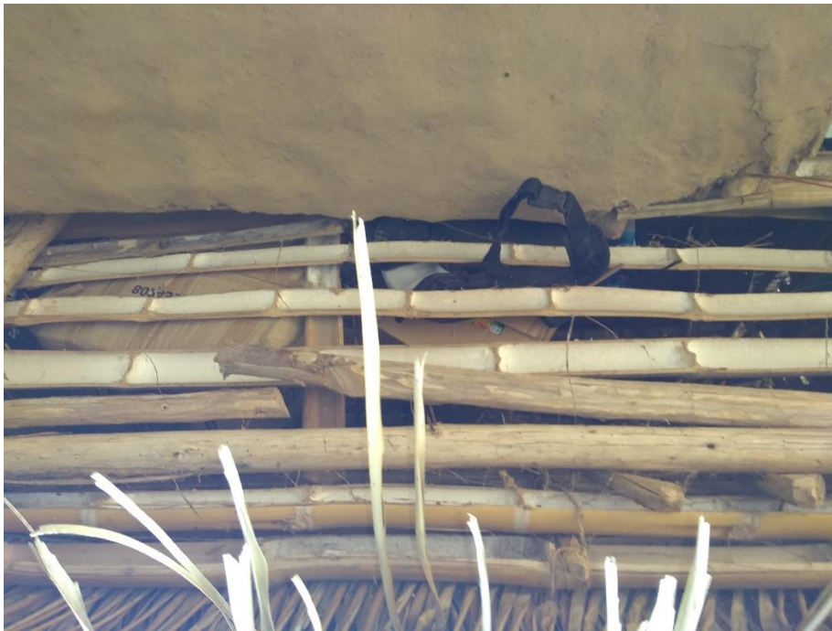
Fotografía 105. Ventilación en guadua casa de E.D.
