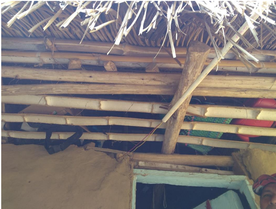
Fotografía 104. Ventilación en guadua casa de E.D.
