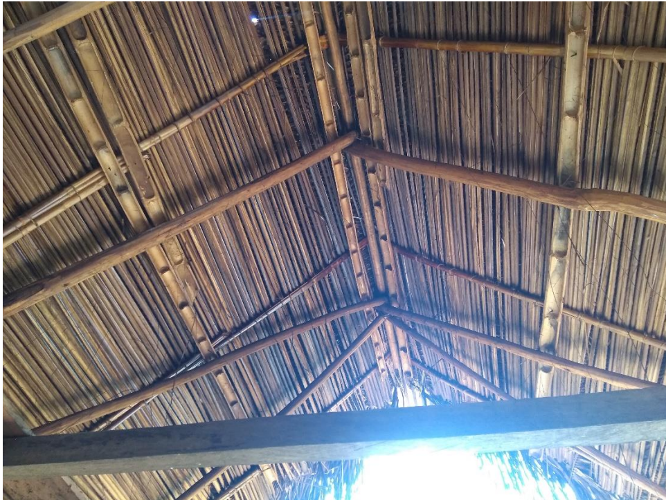
Fotografía 53. Techo empalmado cocina de M.C.
