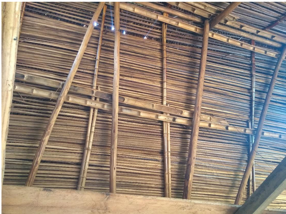
Fotografía 54. Techo empalmado cocina de M.C.
