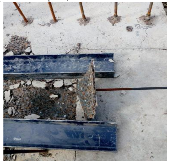
Fotografía 1. Arrancamiento del concreto.
