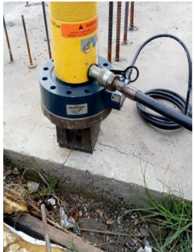
Fotografía 5. Falla de borde.
