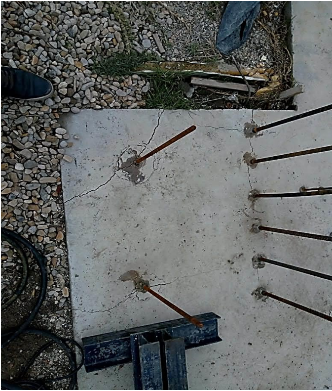
Fotografía 2. Falla de borde del concreto.
