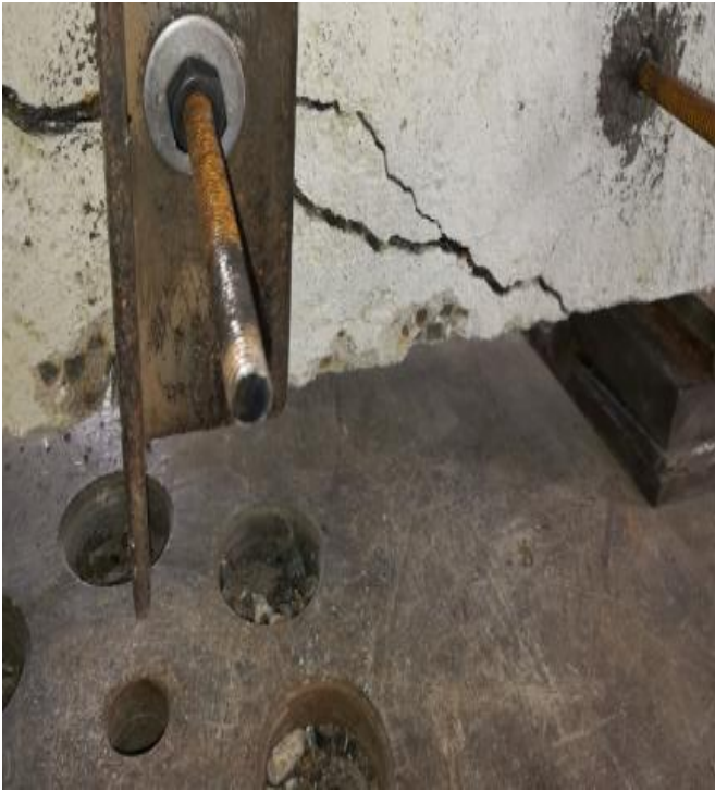
Fotografía 6. Falla por arrancamiento.
