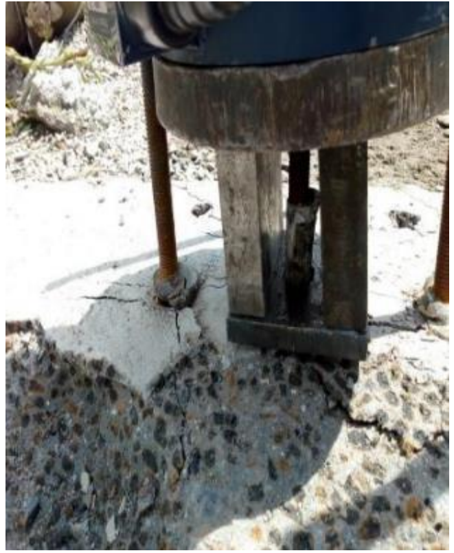
Fotografía 4. Falla de Adherencia.
