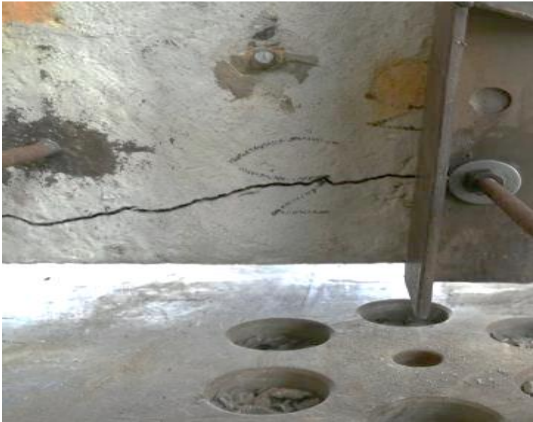
Fotografía 21. Falla por arrancamiento del concreto. *Fuente: Propia.
