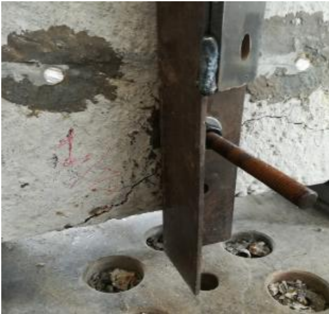
Fotografía 20. Falla por arrancamiento del concreto.
