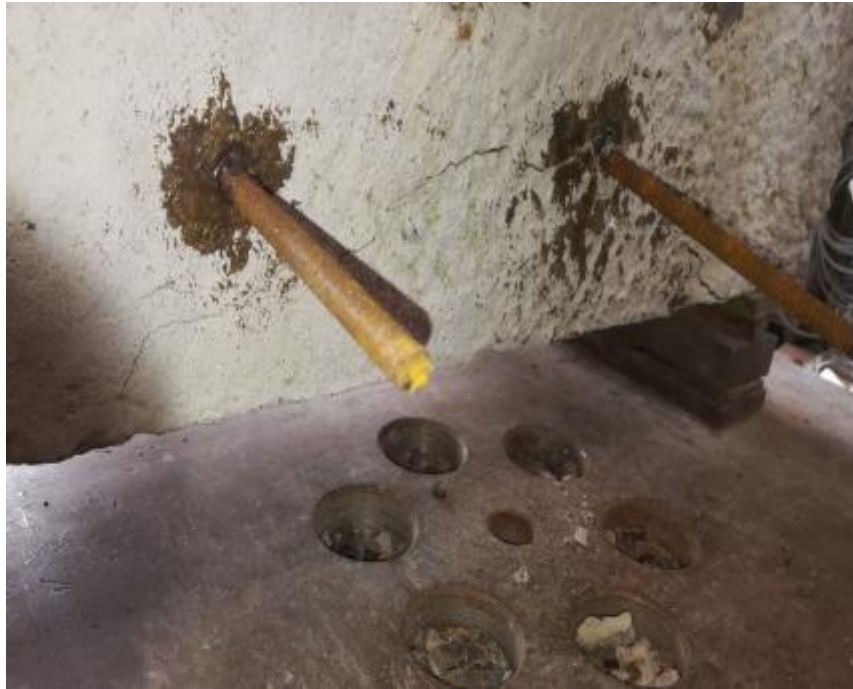
Fotografía 22. Falla por arrancamiento del concreto M 4. *Fuente: Propia.
