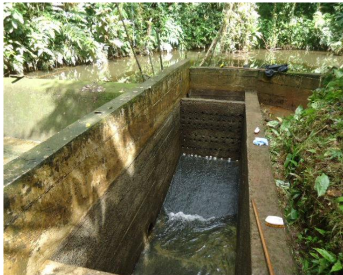
Ilustración 13. Bocatoma y desarenador de corregimiento de Bellavista.
