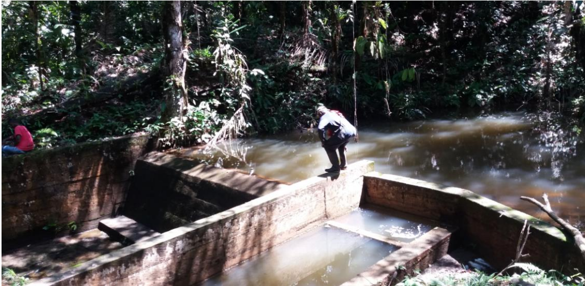
Ilustración 12. Estado de la bocatoma existente.
