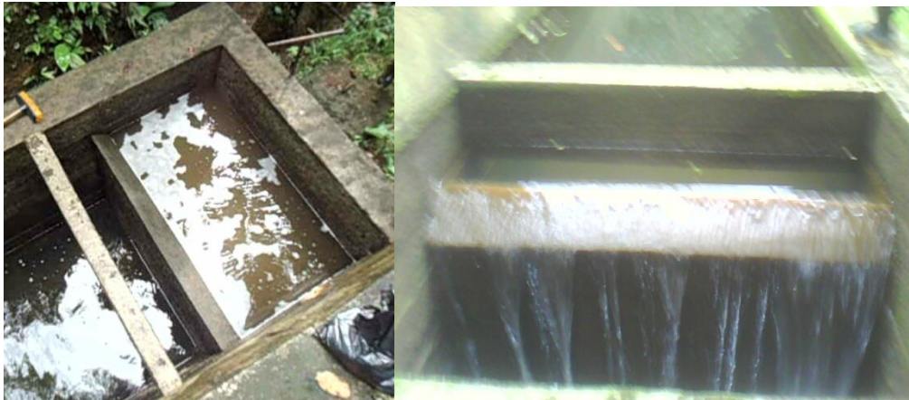
Ilustración 14. Cámara de salida del desarenador.
