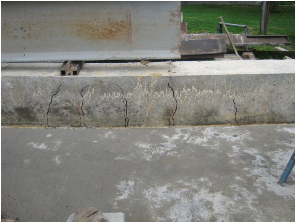
Fisuras luz derecha
