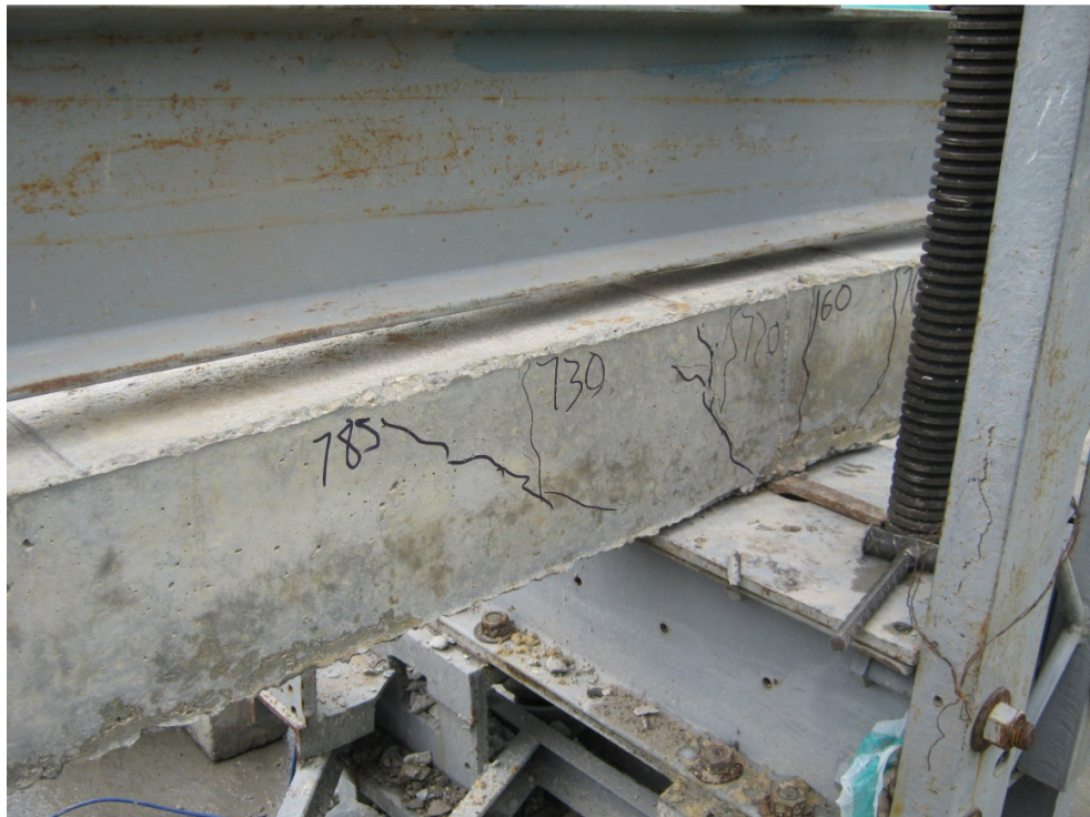
Fisuras apoyo central vista luz derecha
