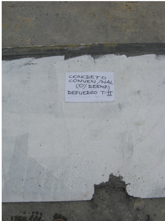
Esquema de fisuración centro y exploración del recubrimiento
