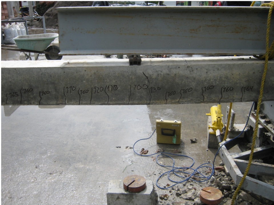
Fisuras luz derecha
