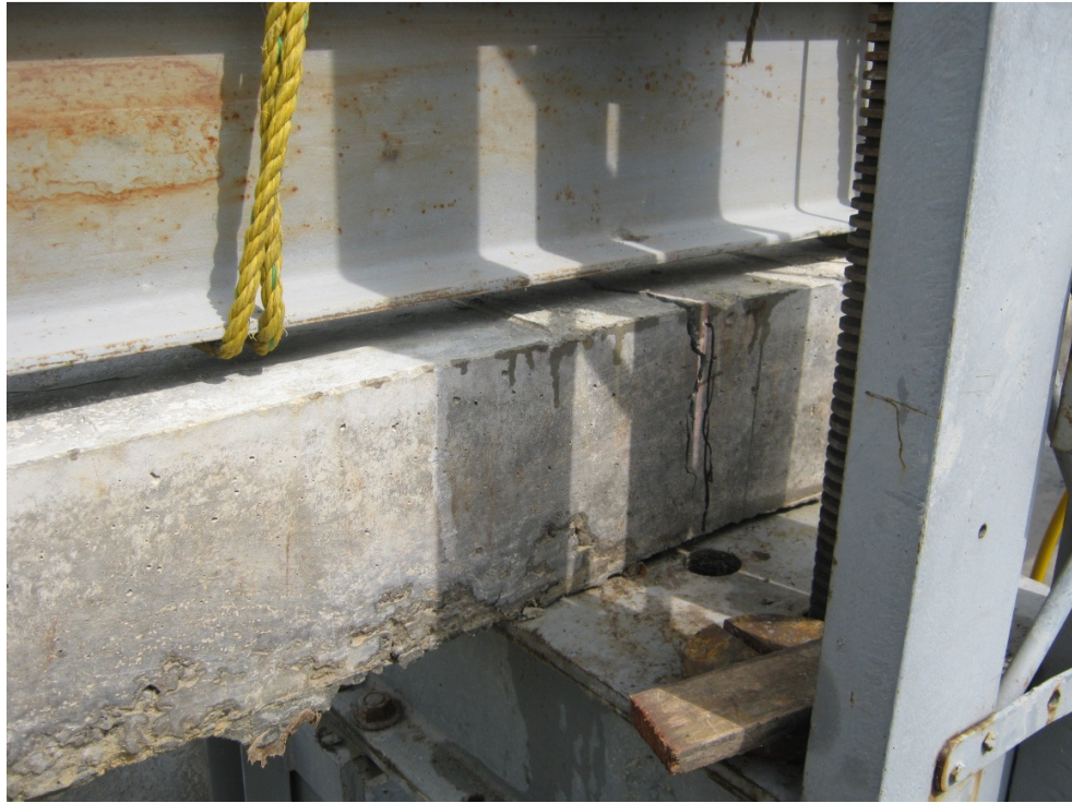
Fisura apoyo central
