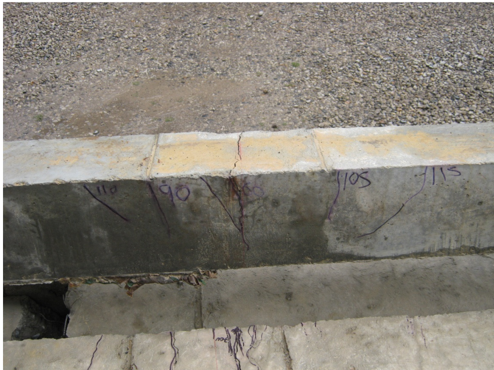
Vista superior apoyo central
