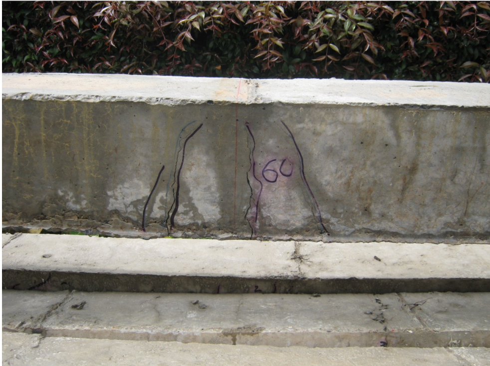
Fisuras luz izquierda
