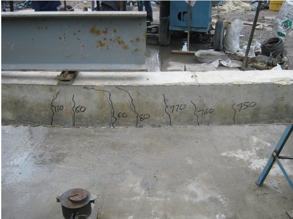
Fisuras luz izquierda
