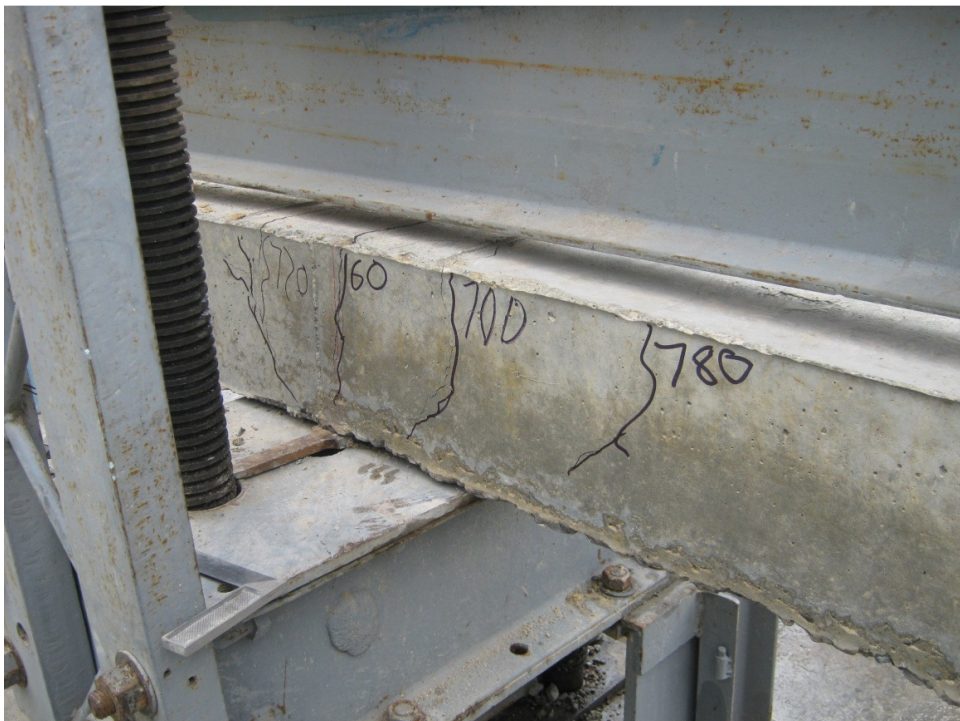
Fisuras apoyo central vista luz izquierda
