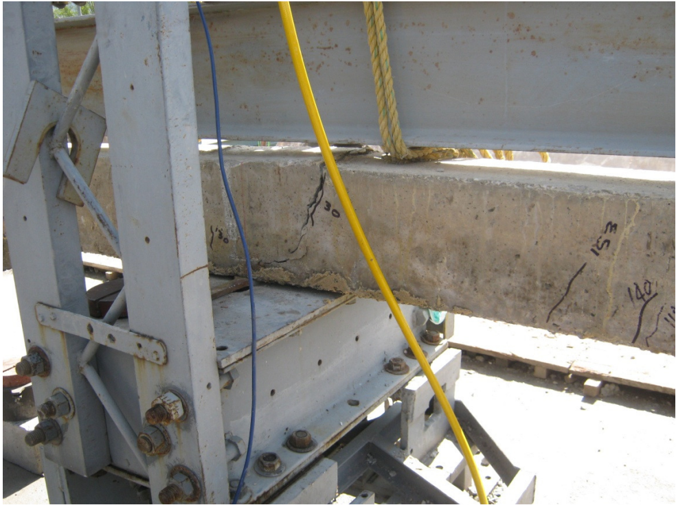
Fisuras apoyo central
