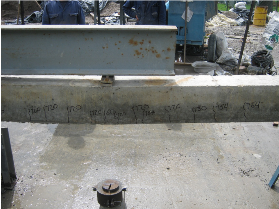
Fisuras luz izquierda
