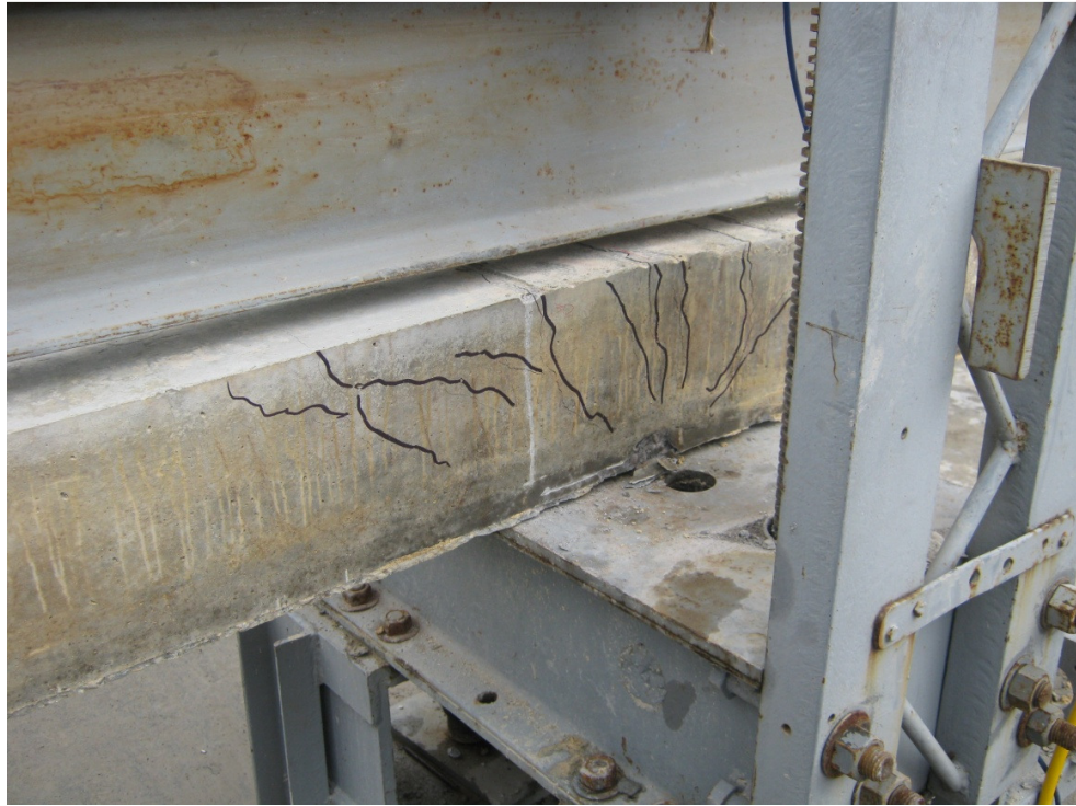
Fisuras apoyo intermedio
