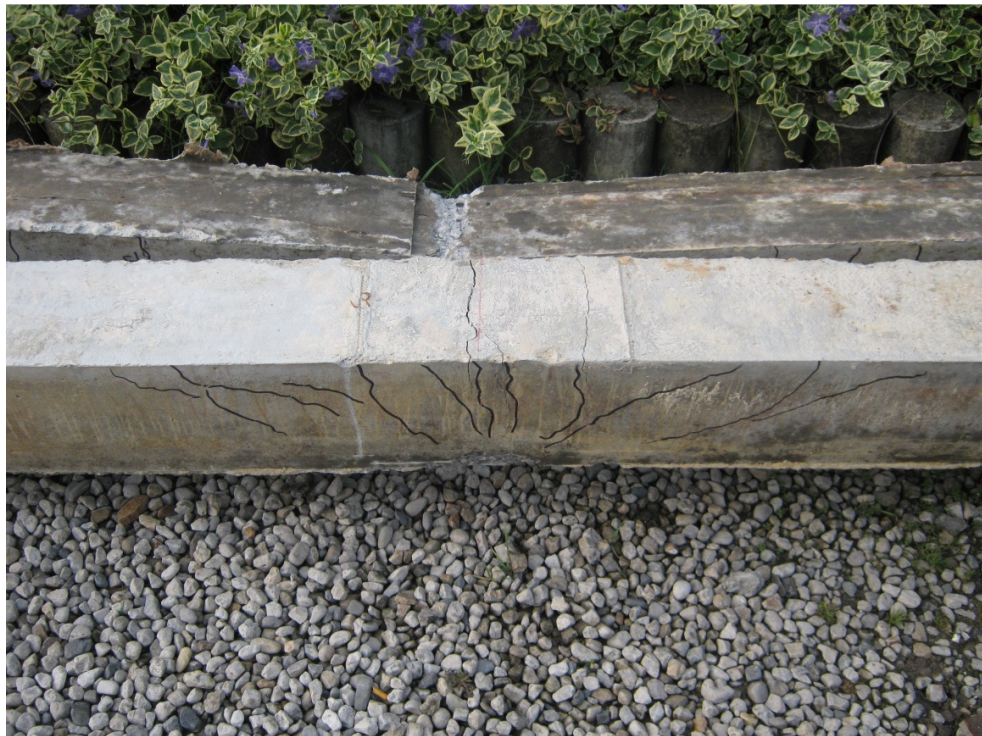
Vista superior apoyo central
