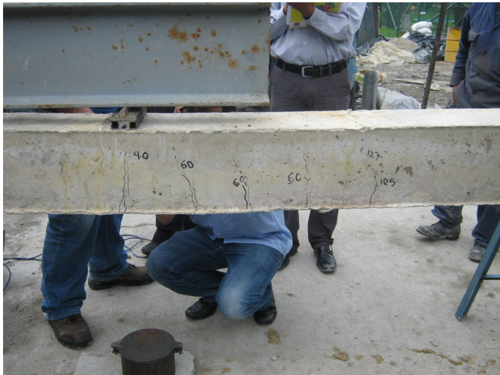
Fisuras luz derecha
