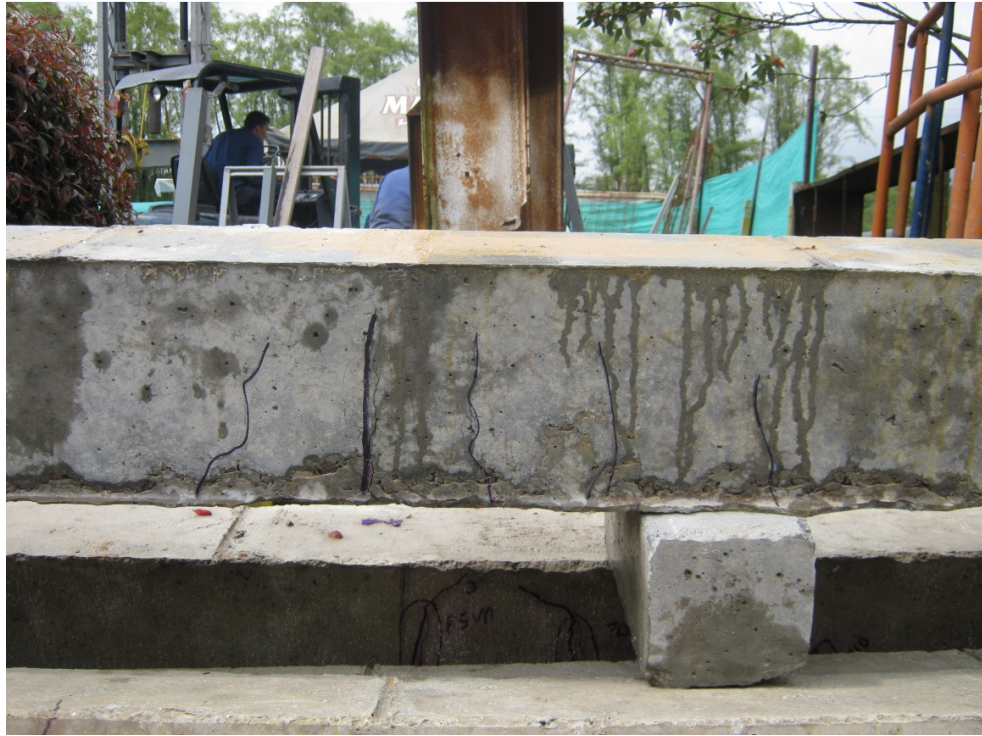
Fisuras luz derecha
