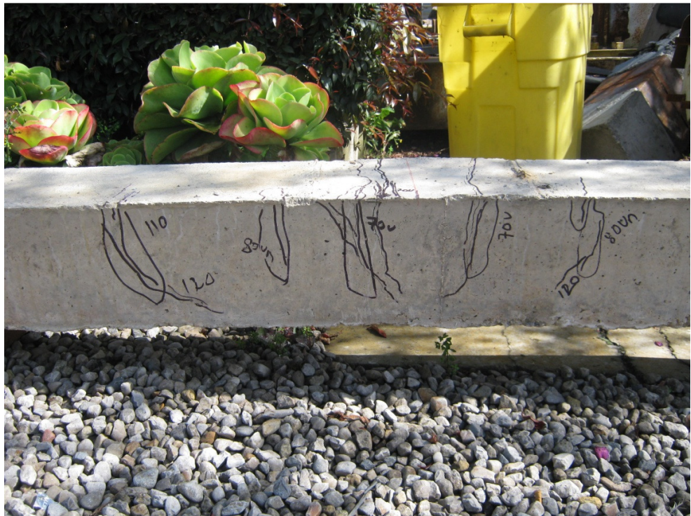
Fisuras apoyo central
