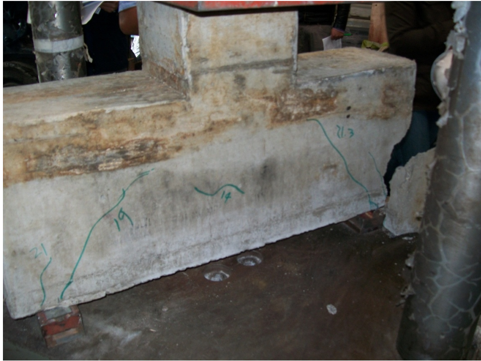
Mecanismo de falla cara 2
