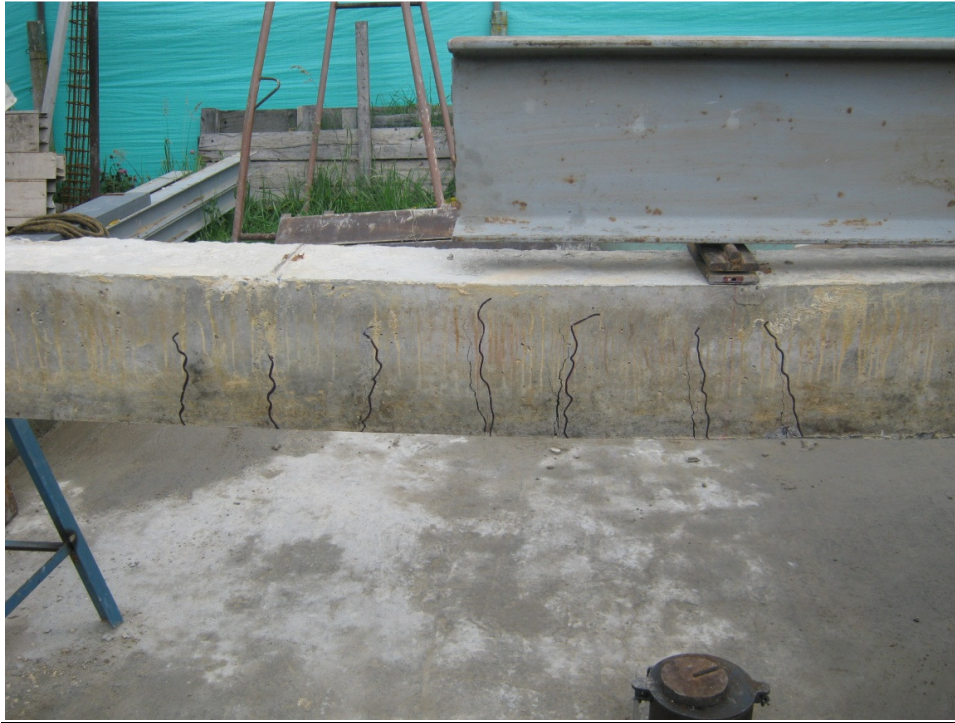
Fisuras luz izquierda
