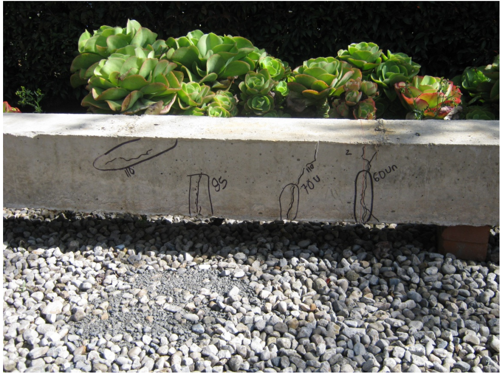
Fisuras luz izquierda
