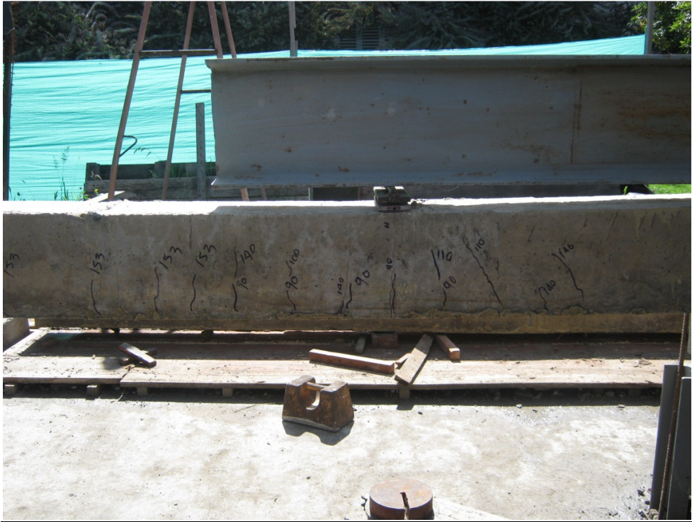
Fisuras luz izquierda
