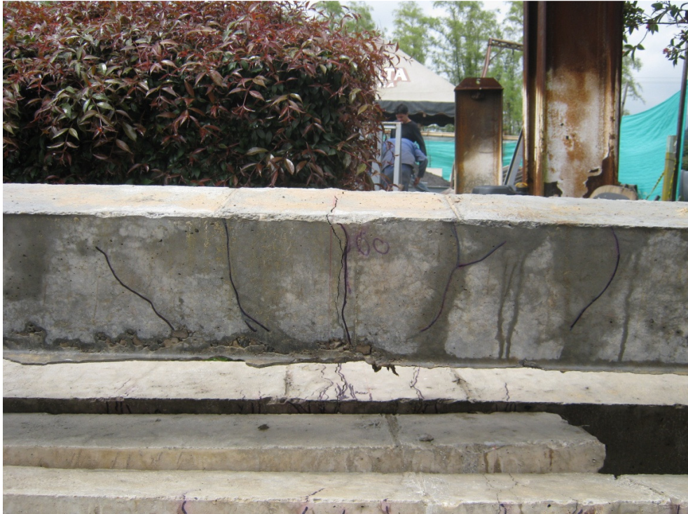
Fisuras apoyo central
