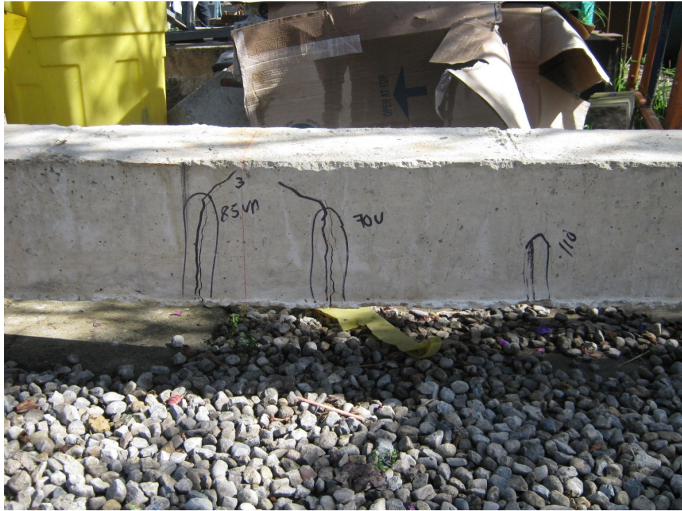
Fisuras luz derecha
