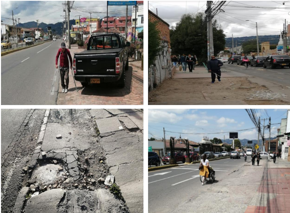
FIGURA 54. SITUACIONES CRÍTICAS AV. PRADILLA 1
