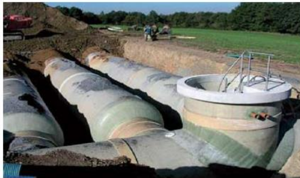
Figura 53. Tanques de tormenta GRP Pavco Fuente: Capacitación Pavco de SUDS enero 2018.
