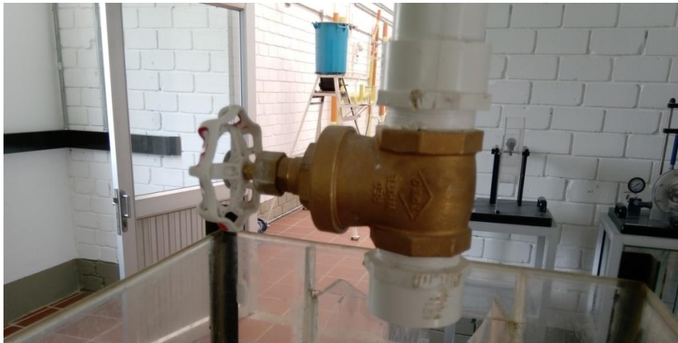
Figura 44: tubería de acople en el laboratorio de mecánica de fluidos del centro de estudios hidráulicos (CEH)
