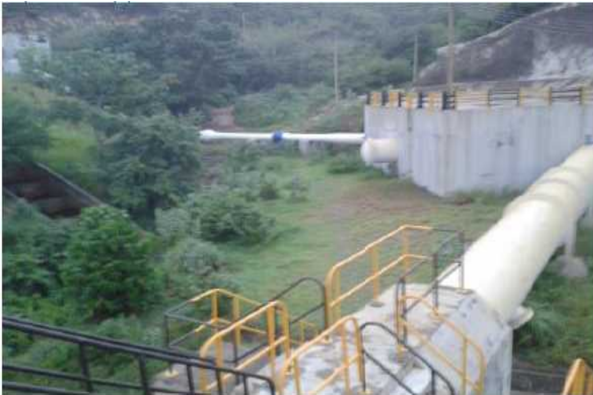
Figura 9-9: Bloque distribuidor (Deriva a la conducción San Juan-PCH-Descarga Válvula HB)
