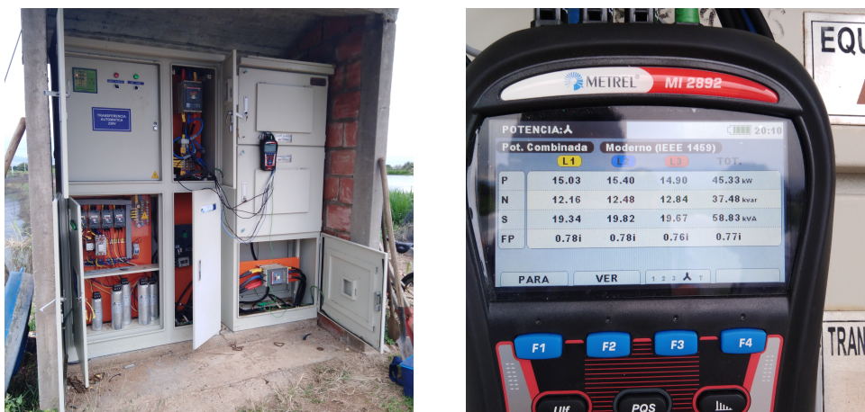
Figura 3.7: Medición de 30 aireadores de 2 hp operando en SFF con analizador de redes, en barraje principal de tablero de distribución
