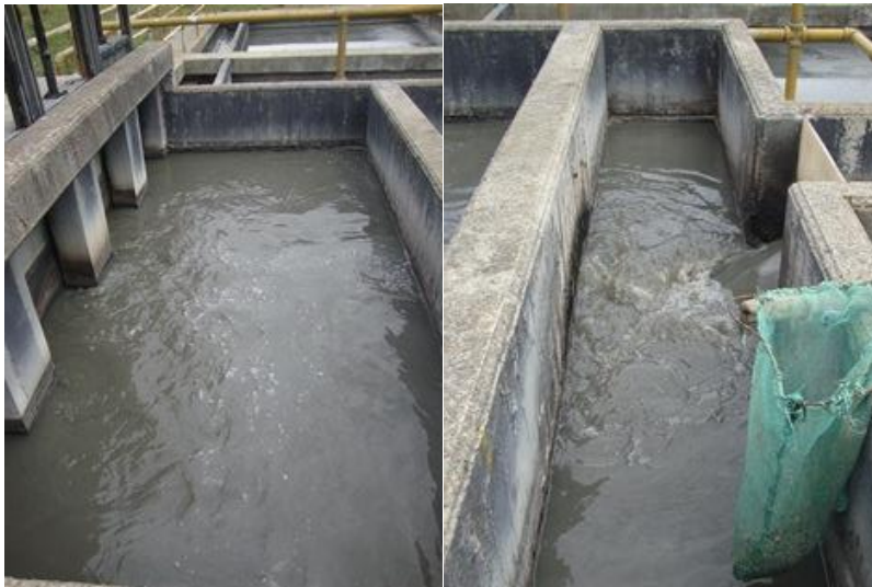
Figura 12. Tanque de homogeneización
