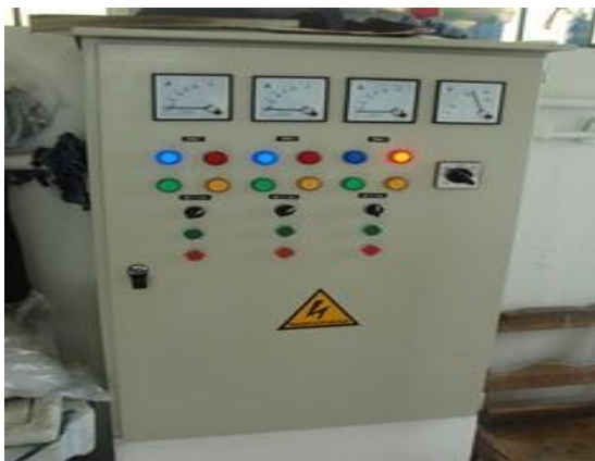
Figura 4. Sistema de control del bombeo
