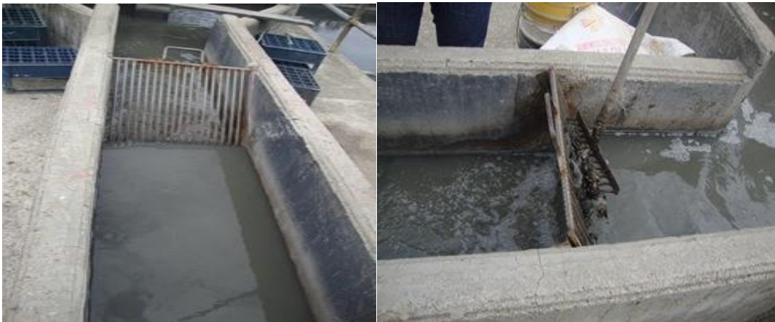
Figura 9. Sistema de cribado
