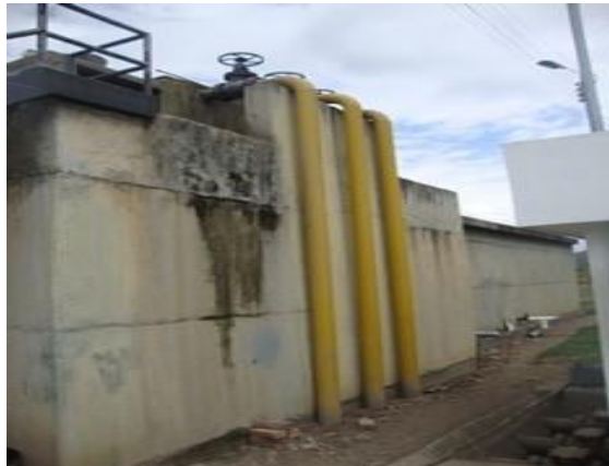
Figura 7. Válvulas para control de caudales a la salida de la estación de bombeo
