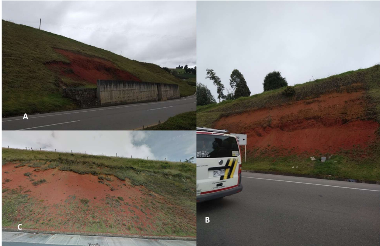
Imagen 21. Fenómenos de inestabilidad de taludes ocasionados por la pérdida de cobertura vegetal y erosión superficial, casos observados en la zona de estudio. Imágenes A y B son fuente propia, imagen C extraída de Google Maps (Street View). En B y C se puede observar el desprendimiento superficial de material producto de la erosión.
