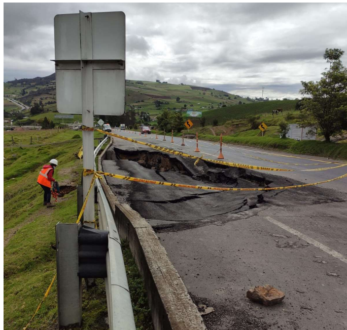
Imagen 26. deslizamiento en zona de Ventaquemada, se observa la corona del deslizamiento dentro de la calzada, también es posible apreciar el levantamiento del material debido al movimiento sobre la superficie circular de falla generada. Fotografía suministrada por Servicios de Ingeniería Ltda - SIL.
