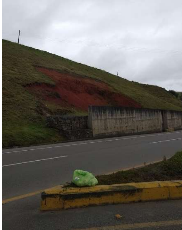
Imagen 27. Posible deslizamiento rotacional, podría convertirse en un movimiento complejo. En este se han aplicado algunas medidas de mitigación, como la instalación de un muro en gaviones y posteriormente un muro de contención. Fuente propia.
