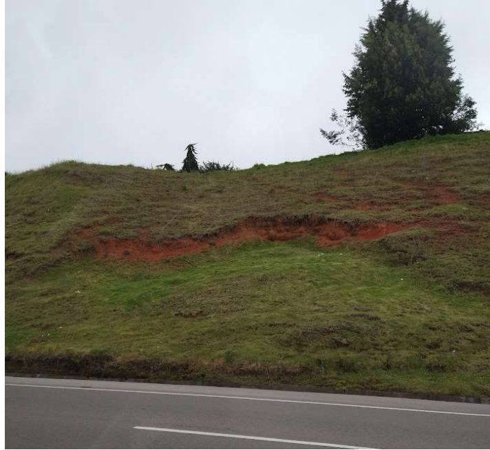
Imagen 25. Deslizamiento rotacional en el sector de Tierra Negra, se observa el escarpe principal en la zona media del talud, el deslizamiento podría evolucionar a un movimiento complejo retrogresivo. Fuente propia.
