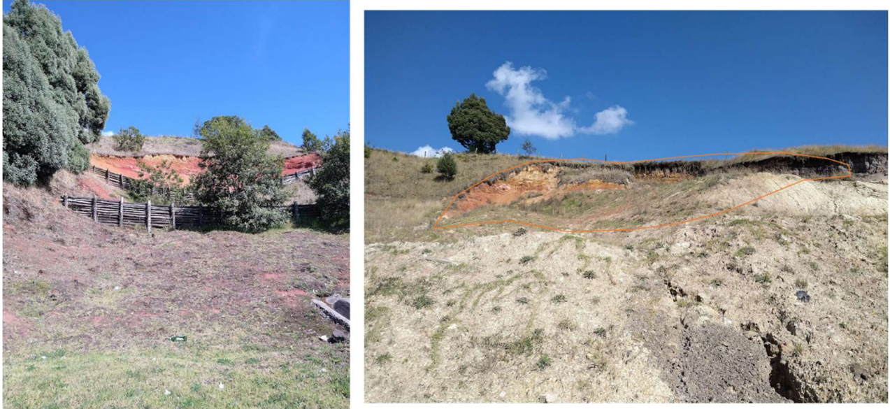
Imagen 22. Deslizamientos rotacionales en la zona alta de un depósito de cenizas volcánicas en cercanías de Tierra Negra, se observa el escarpe principal de falla, al igual que los flancos del deslizamiento, en la fotografía de la izquierda se observa la implementación de sistemas de estabilización (trinchos). Es posible ver estos grandes deslizamientos en la figura 26, en la sección 4.3, en esta la morfología se observa claramente. Fuente propia.
