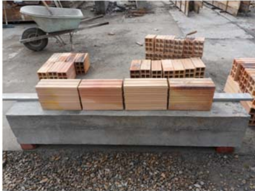
1) Ubicación de la primera hilada sobre viga de cimentación sin mortero de pega.
