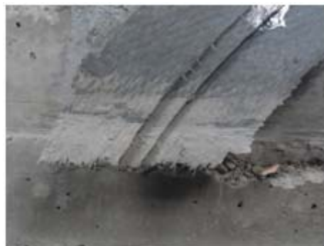
Detalle de la rotura de la fibra en el anclaje
