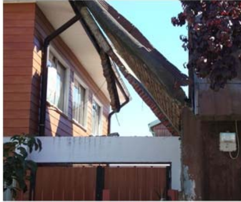
Figura 2-13 Caída de muro de mampostería en vivienda vecina por falta de confinamiento (Terremoto de Chile, 2010).
