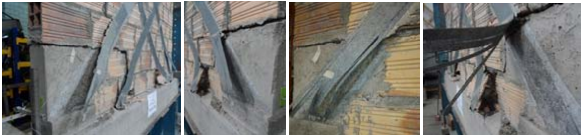
Rotura y arrancamiento de la fibra en el anclaje
