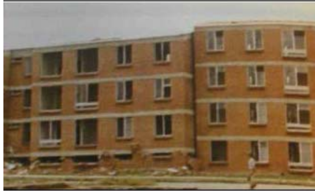
Figura 2-1 Colapso de edificación (Terremoto de Popayán, 1983)
