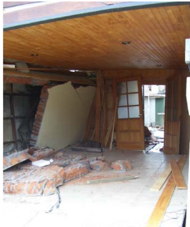
Figura 2-14 Volcamiento de muro de mampostería (Terremoto de Chile, 2010).
