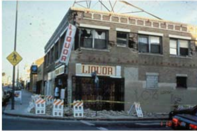
Figura 2-9 Falla por desprendimiento de las unidades de mampostería (Terremoto de Northridge, 1994)
