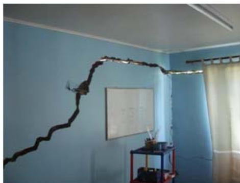
Figura 2-12 Grietas diagonales en muros (Terremoto de Chile, 2010).
