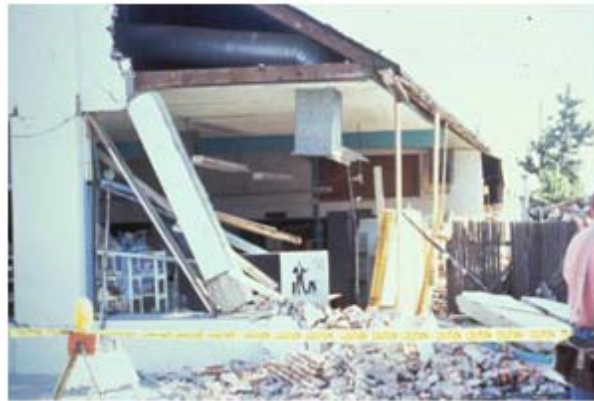
Figura 2-10 Colapso parcial de la mampostería (Terremoto de Northridge, 1994)
