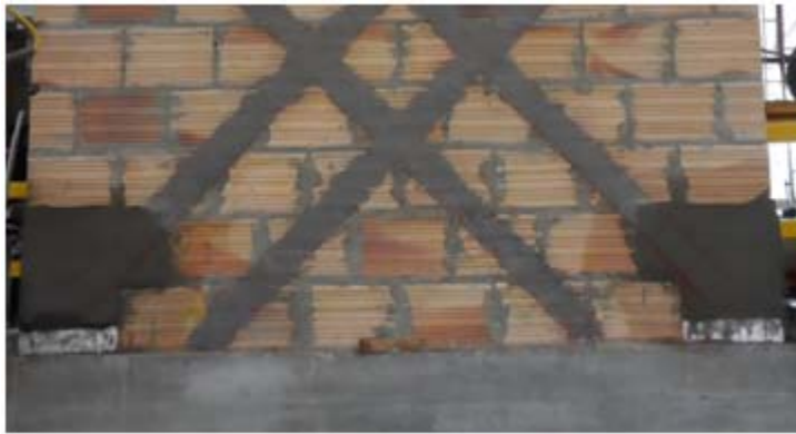
Estado del muro al quitar las formaletas del concreto de la primera etapa
