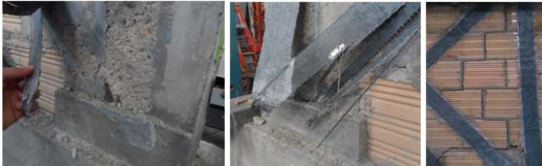
Detalle de rotura y delaminación de la fibra
