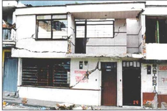
Figura 2-5 Falla de una edificación de mampostería no estructural en Armenia (Terremoto del Eje Cafetero, 1999)
