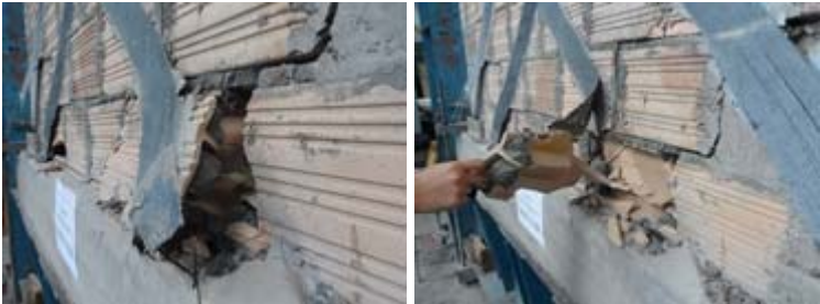
Rotura de unidades por la adherencia con la fibra
