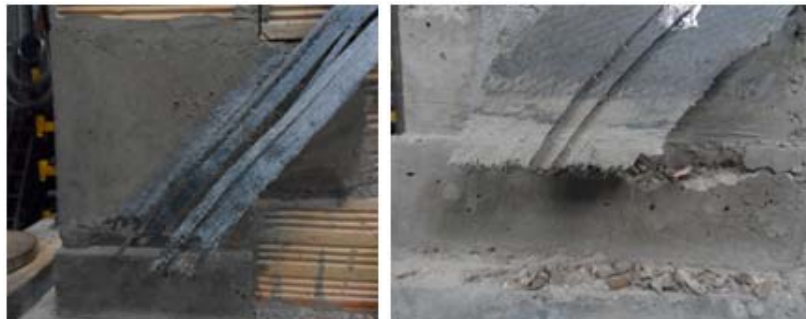
Figura 5-12 Falla de la fibra en el sistema de anclaje No. 4.
