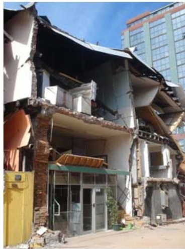
Figura 2-11 Caída de muros de fachada (Terremoto de Chile, 2010).
