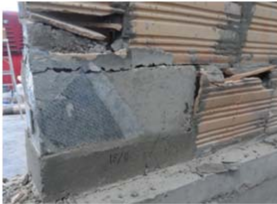
Falla por tensión del anclaje
