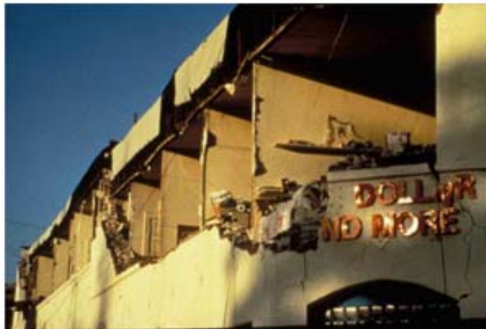
Figura 2-8 Fallas en la mampostería no reforzada (Terremoto de Northridge, 1994)
