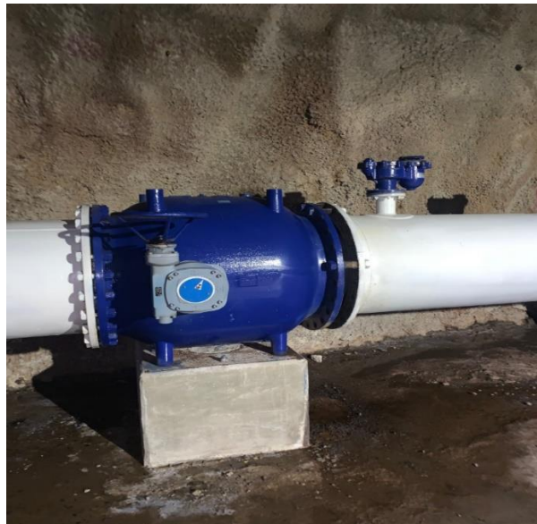
Figura 17. Vista de la válvula anular de descarga de fondo. Fuente: (Avila, 2021)
