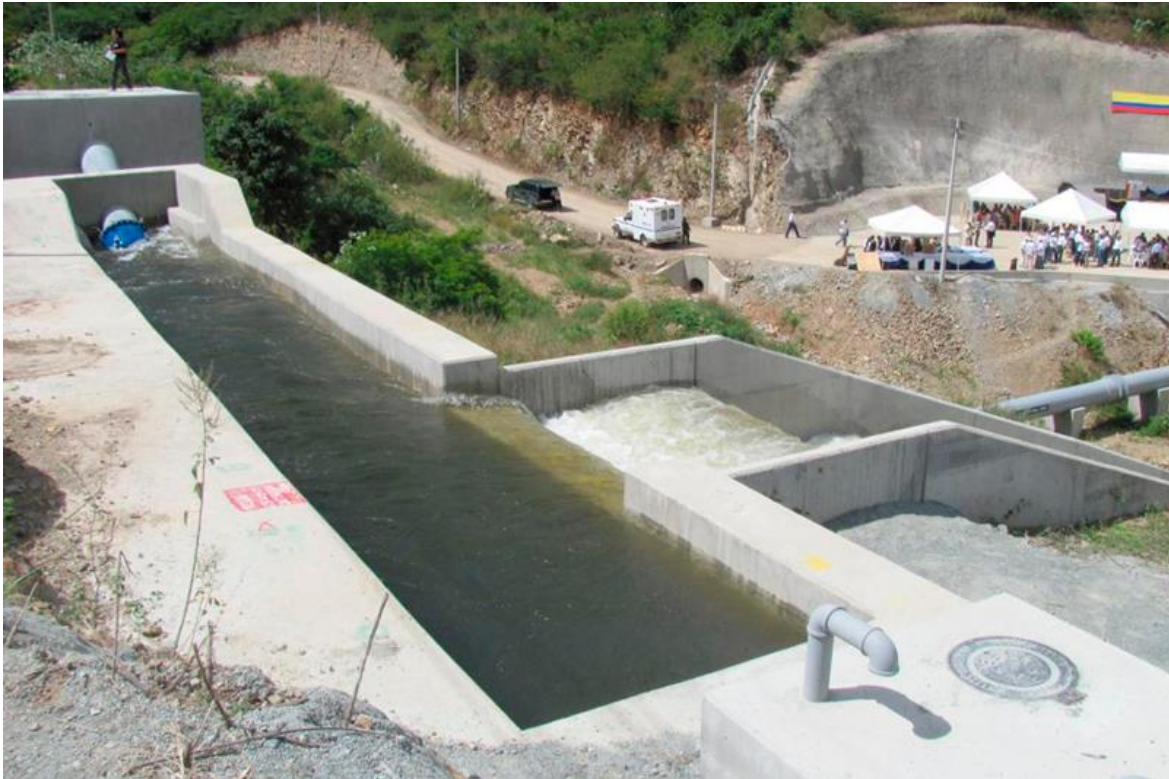
Figura 21. Tanque de amortiguación conducción San Juan del Cesar. Fuente: (ADR A. d., 2021)
