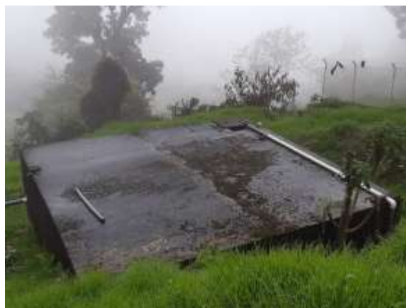
Imagen 21 Tanque de almacenamiento PTAP San Antonio Santa Barbara. Fuente: Autor
