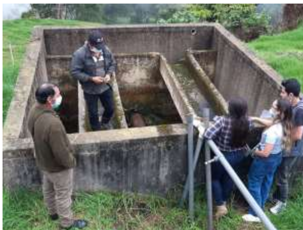
Imagen 18 Sistema de Filtración PTAP San Antonio Santa Bárbara. Fuente: Autor
