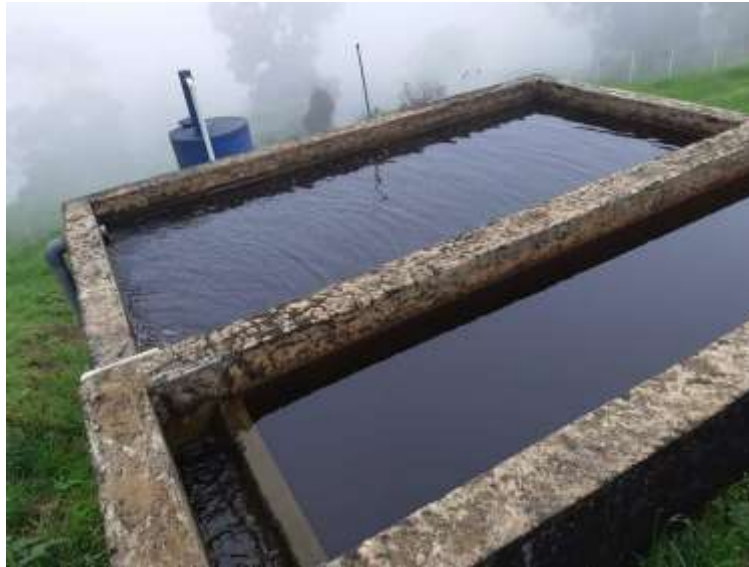
Imagen 16 Sedimentador de alta tasa de placas PTAP San Antonio Santa Bárbara.
