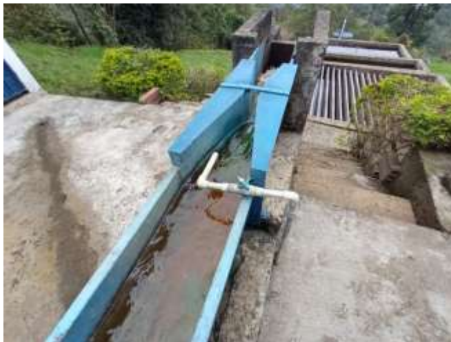
Imagen 10. Aforo y mezcla rápida mediante canaleta Parshall. Fuente: Autor
