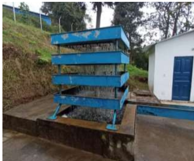
Imagen 8. Sistema existente de aireación PTAP San Antonio Santa Bárbara. Fuente: Autor
