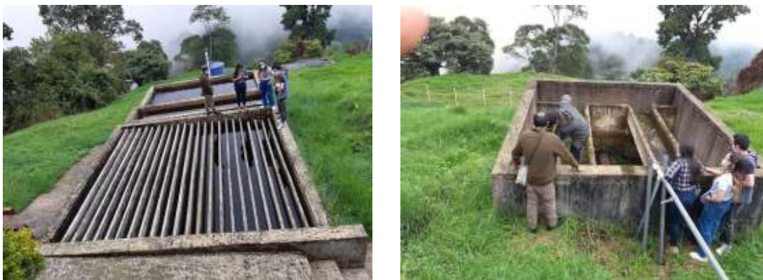
Imagen 3. Inspección visual y levantamiento de información técnica de las estructuras existentes de la PTAP San Antonio Santa Bárbara. Fuente: Autor
