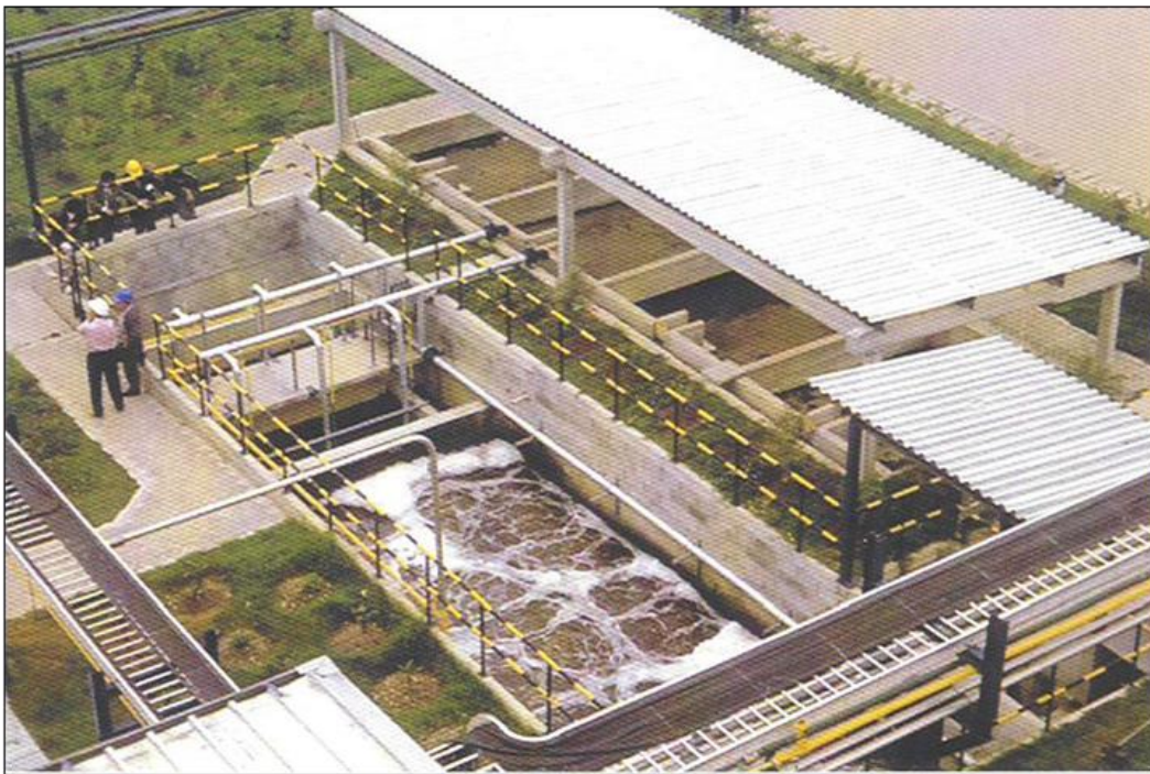
Ilustración 8 Tratamiento de lodos activados
