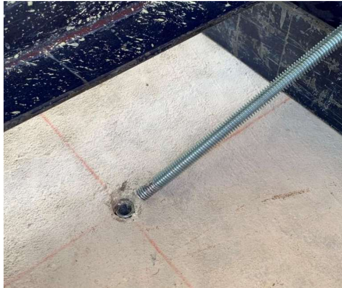
Ilustración 23. Falla del acero
