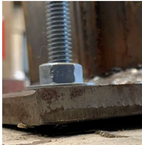
Ilustración 28. Falla anclaje adherido en condiciones ideales.
