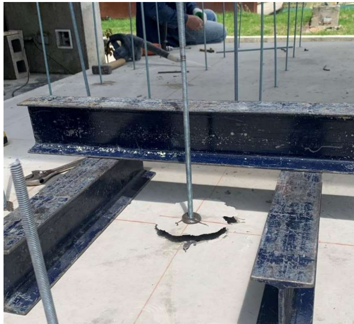
Ilustración 18. Arrancamiento del concreto
