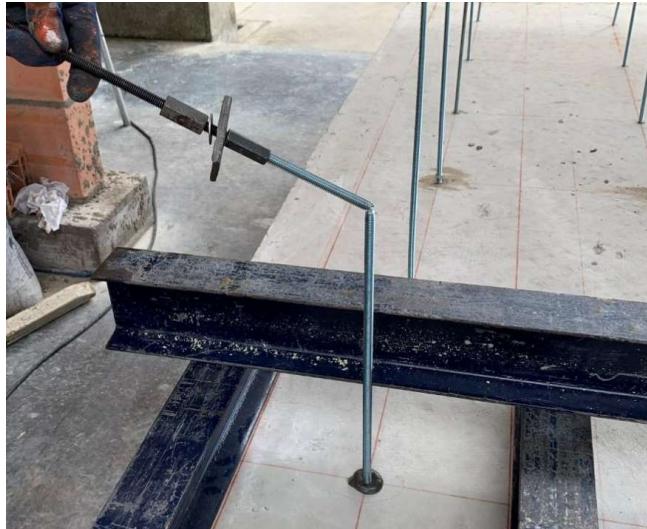
Ilustración 19. Falla del acero.
