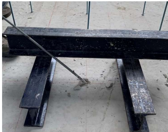
Ilustración 20. Falla por deslizamiento o Adhesión.
