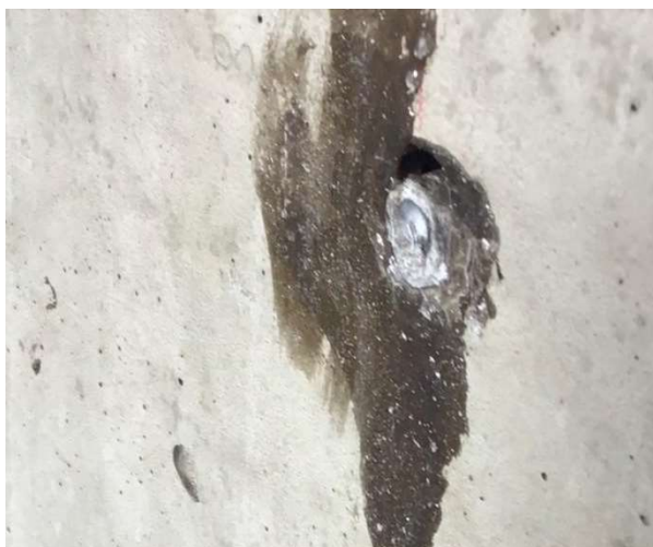
Ilustración 24. Falla del acero
