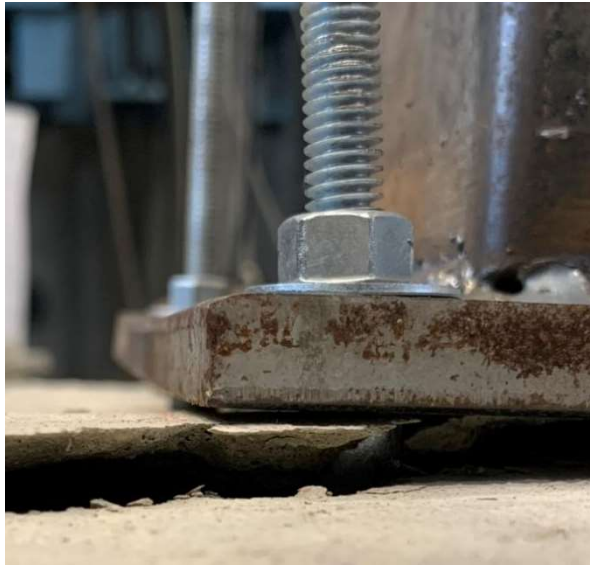
Ilustración 27. Falla de anclaje mecánico con imperfecciones.
