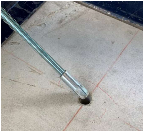
Ilustración 22. Falla por deslizamiento.
