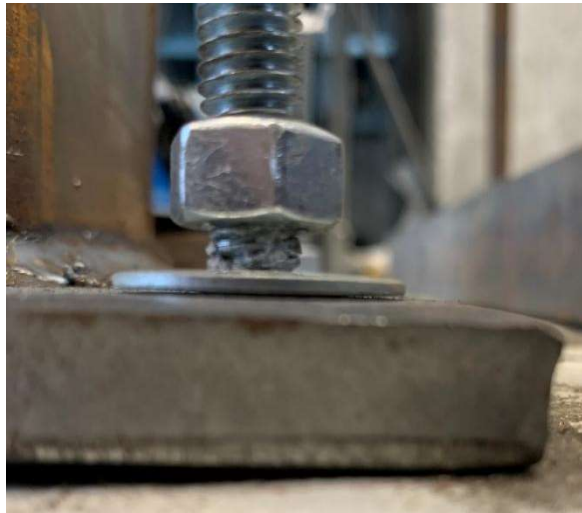
Ilustración 26. Falla de anclaje mecánico con imperfecciones.
