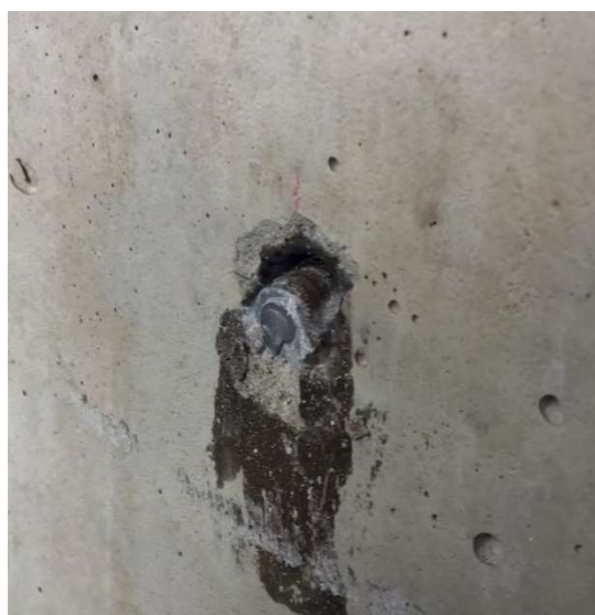
Ilustración 25. Falla del acero precedida por descascamiento del concreto.
