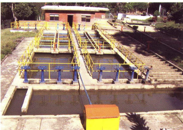
Vista general de la planta de tratamiento.
