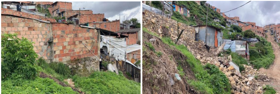
Fotografía 1. a) Vista fisura en muros y cimentación por movimientos del suelo de apoyo; b) Vista de vivienda en construcción recientemente afectada por deslizamiento local Fuente: Propia.
