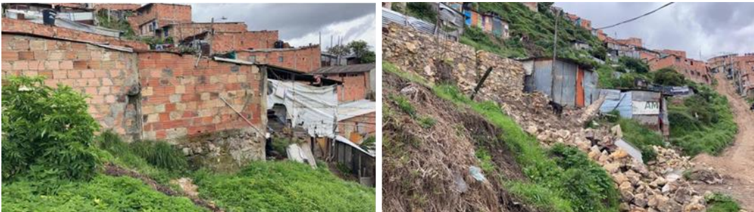
Fotografía 1.4. a) Vista fisura en muros y cimentación por movimientos del suelo de apoyo; b) Vista de vivienda en construcción recientemente afectada por deslizamiento local Fuente: Propia
