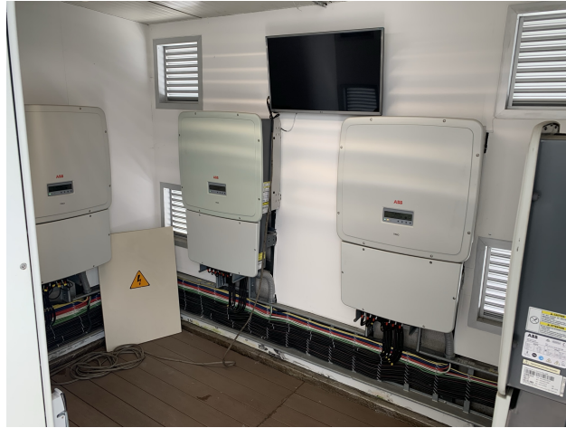
Figura 4.3: Cuarto técnico baja tensión
