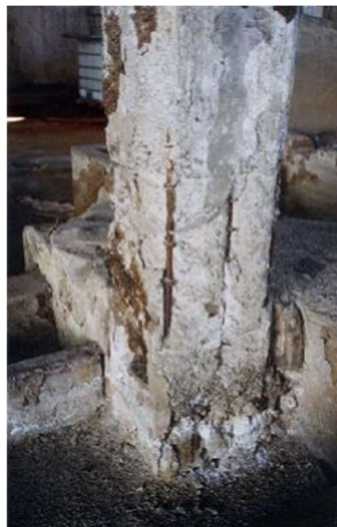
Ilustración 51 Deterioro acentuado en las aristas del elemento por ataque de sulfatos Fuente: (W. Mazer, G. Macioski, N. Soto, & E. Baettker)
