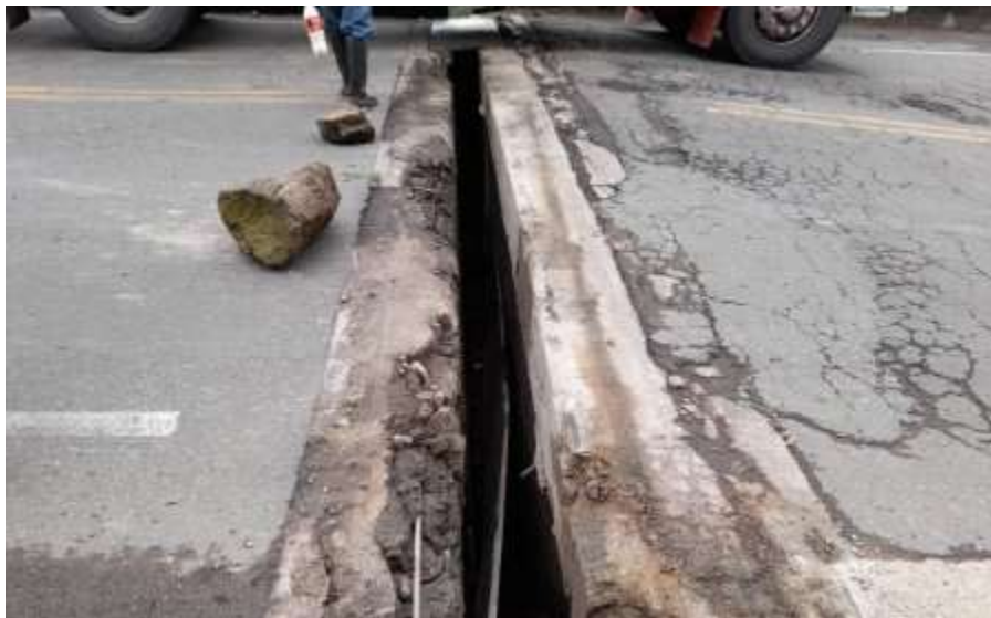
Ilustración 102 Desacople de juntas en puente La Leonera (Prensa Libre, 2022)
