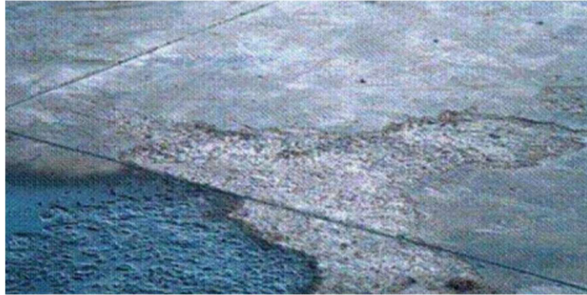
Ilustración 36 Ataque por congelamiento de una losa de concreto Fuente: (Cerna Vásquez & Galicia Guarniz, 2010)
