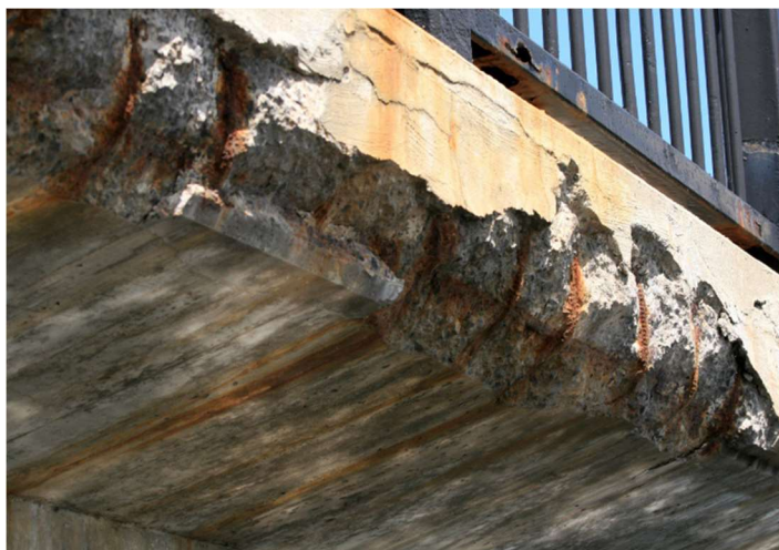
Ilustración 94 Ataque biológico en estructura de concreto Fuente: (Linex, 2018)
