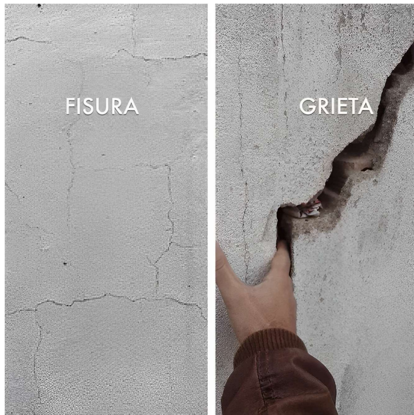
Ilustración 19 Comparativa gráfica entre grieta y fisura Fuente: (Enrique, 2017)
