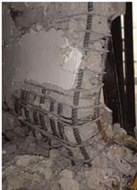
Ilustración 21 Pandeo en columna de concreto reforzado. Fuente: (Ccallo, 2016)
