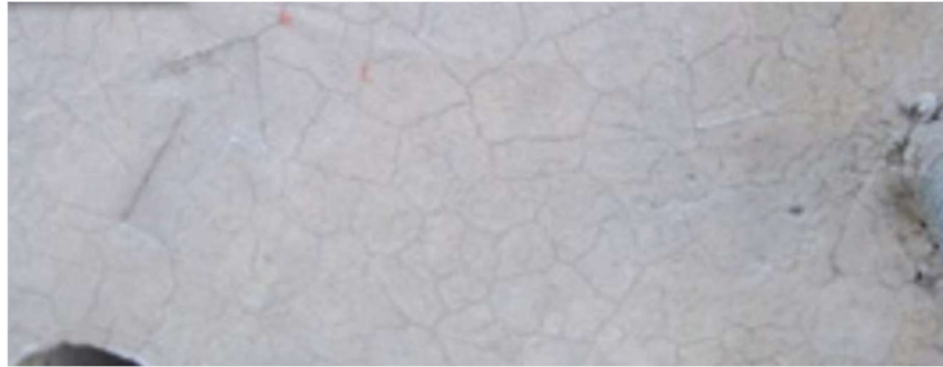
Ilustración 40 Fisuras de contracción plástica Fuente: (IMCYC, 2013)
