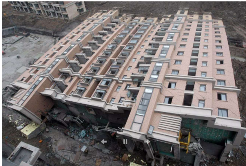
Ilustración 24 Falla por volcamiento de edificación. Fuente: (bloggauta wordpress, 2011)
