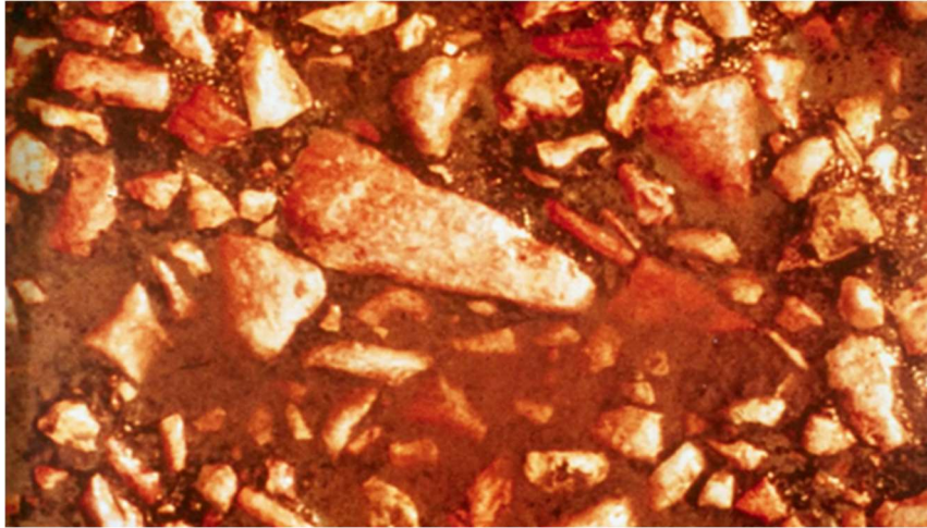
Ilustración 89 Desgaste por abrasión de superficie de concreto. Fuente: (Arango Mejía, 2013)
