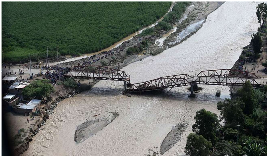
Ilustración 22 Falla por fatiga en puente de tres luces. Fuente: (La fatiga de los puentes, 2019)
