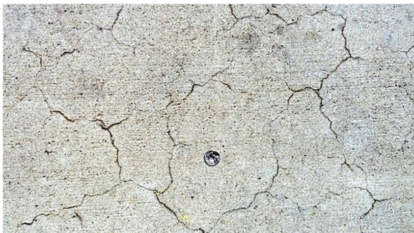
Ilustración 25 Agrietamiento por cambios de temperatura. Fuente: (industry surfer, 2023)
