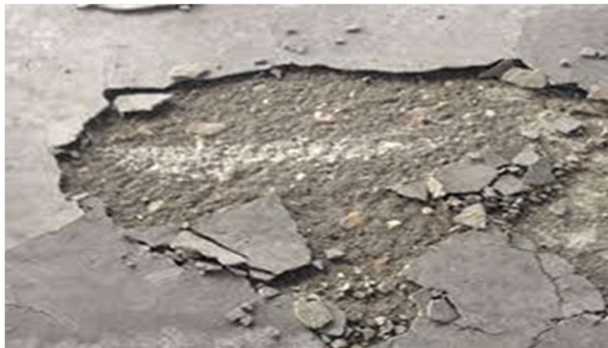
Ilustración 31 Falla por desprendimiento de la superficie de concreto. Fuente: (Constro Facilitator, 2019)
