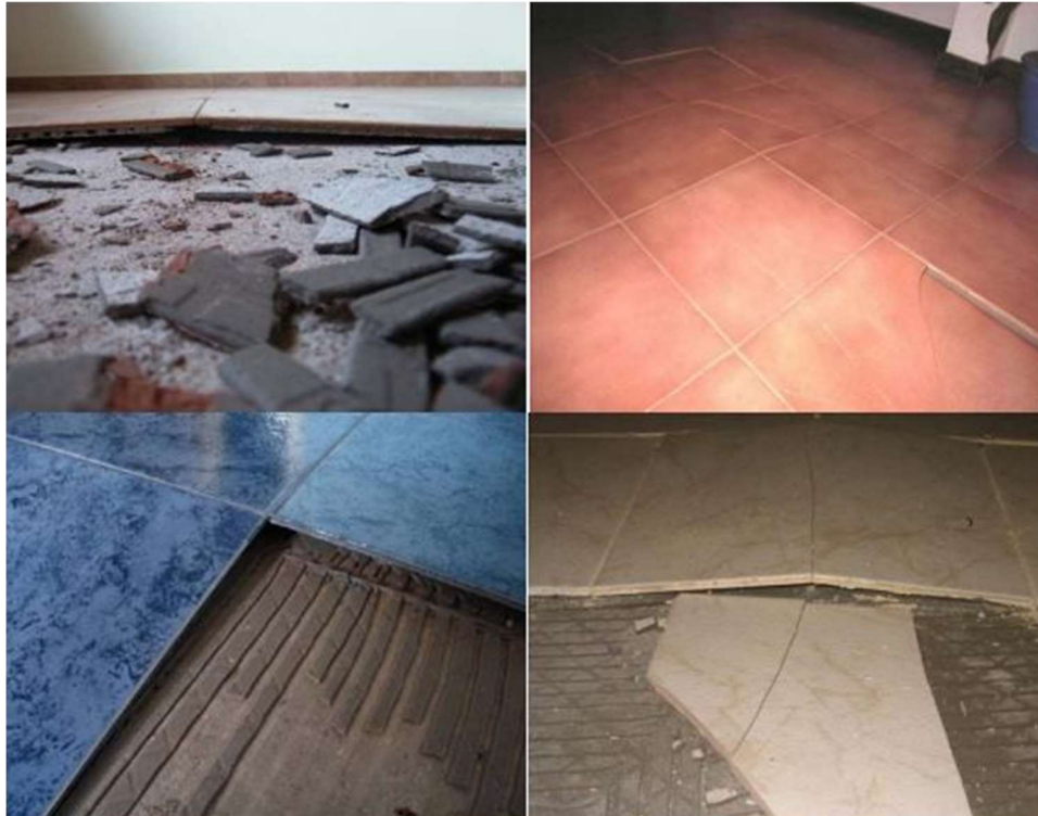
Ilustración 5 Fractura en acabados de piso Fuente: (Arqa, 2020)
