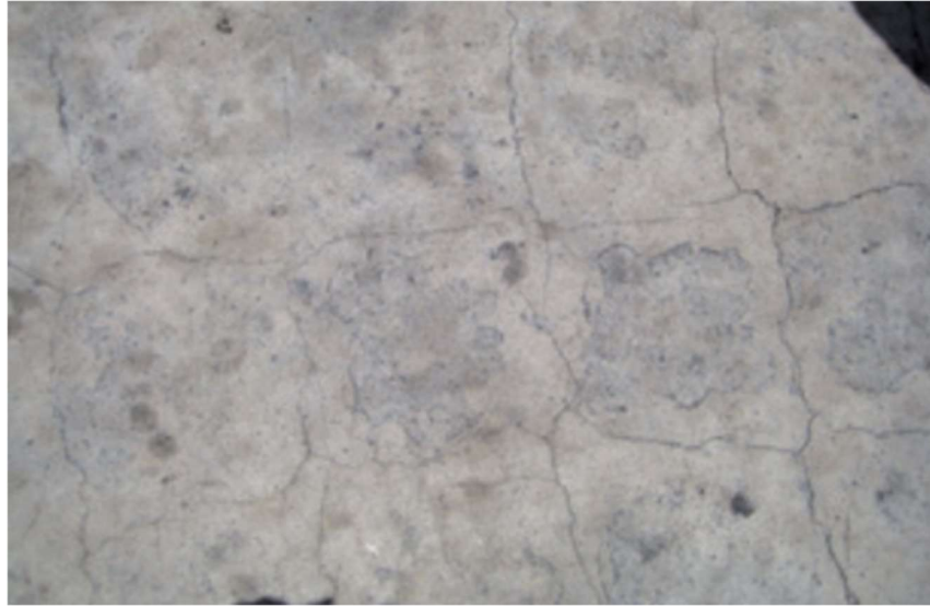
Ilustración 39 Fisuración por asentamiento plástico Fuente: (IMCYC, 2013)
