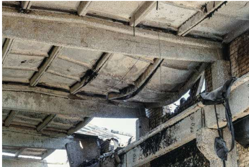
Ilustración 27 Falla por deflexión excesiva en losa de entrepiso de concreto. Fuente: (IStock, 2023)
