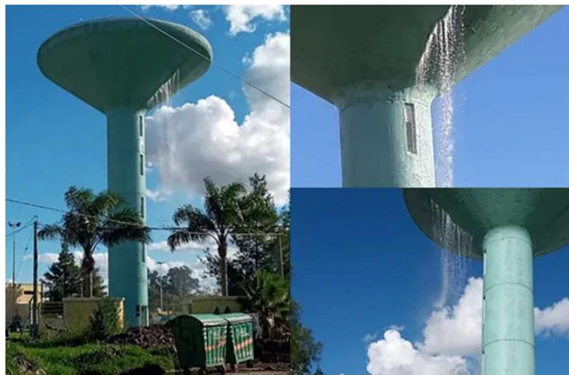
Ilustración 28 Falla por filtraciones en tanque aéreo. Fuente: (La Capital, 2021)
