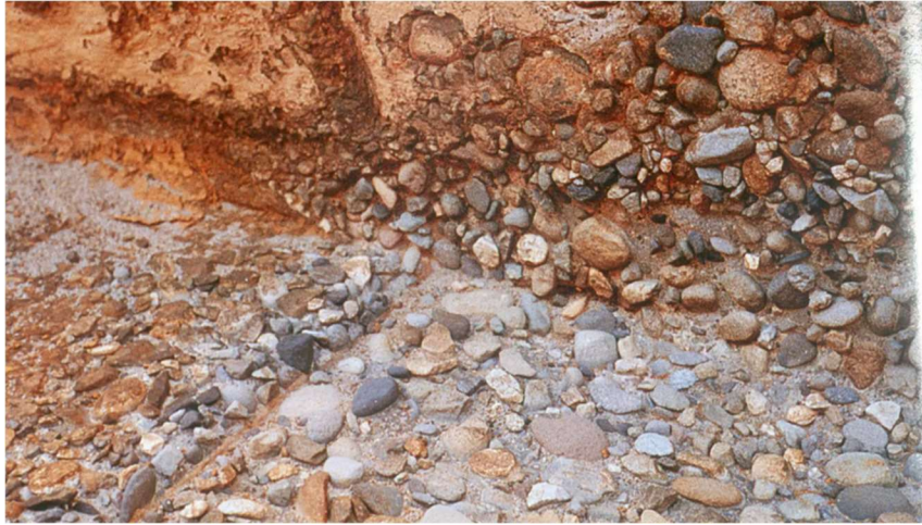
Ilustración 42 Lavado de la pasta de cemento por ataque químico Fuente: (Arango Mejía, 2013)
