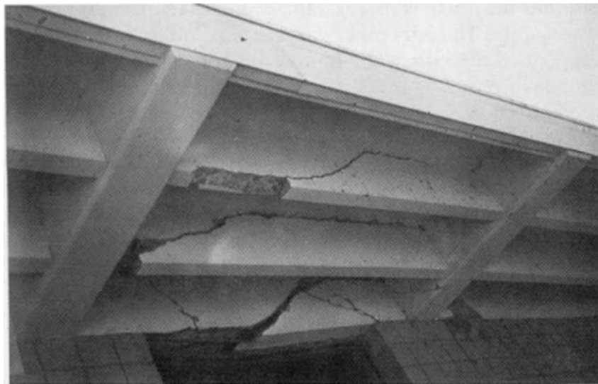
Ilustración 20 Falla por fractura en viguetas de entepiso. Fuente: (Murillo, 2004)
