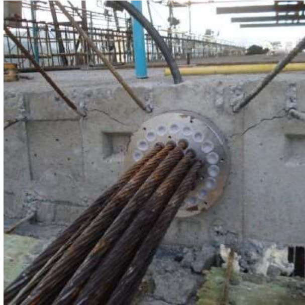
Ilustración 86 Fisuras por aplastamiento local en zona de anclaje de presfuerzo Fuente: (Construblog, 2023)
