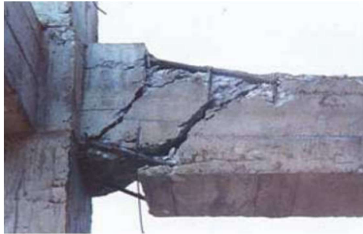
Ilustración 68 Falla de viga por cortante en proximidades al apoyo Fuente: (Serrano, 2023)
