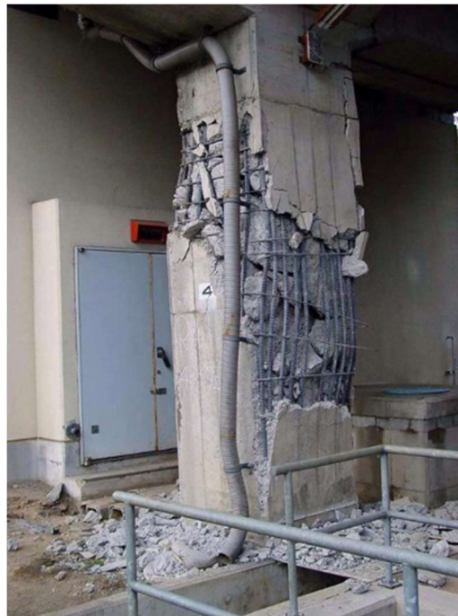
Ilustración 78 Falla por compresión en columna de concreto reforzado Fuente: (Arqzon, 2021)
