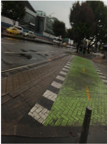
Figura 17. Estado del paso peatonal. Fuente: (Propia)
