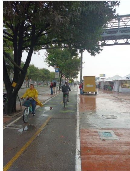
Figura 18. Estado de la ciclorruta al nivel del portal de Suba. Fuente: (Propia)
