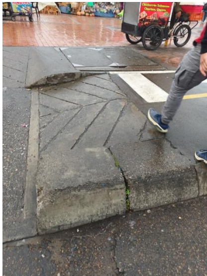
Figura 19. Estado de las rampas de conexión de la ciclorruta. Fuente: (Propia)
