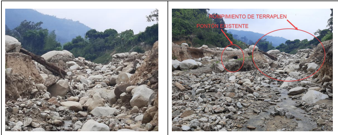
Figura 32 Rompimiento de terraplén existente
