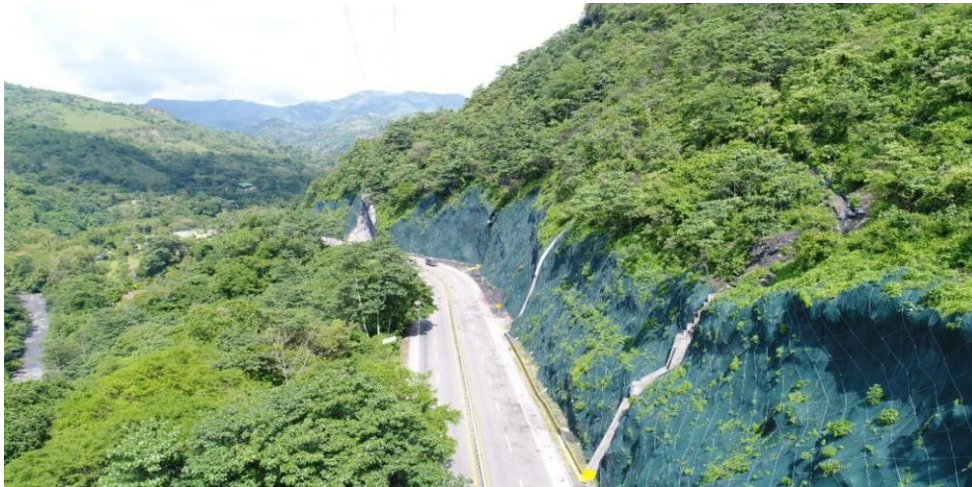
Figura 8: Manto de control de erosión, Concesión Sabana de Occidente (Pavco Wavin Geosintéticos)
