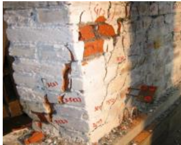
Ilustración 18. Falla por compresión. Fuente [33]
