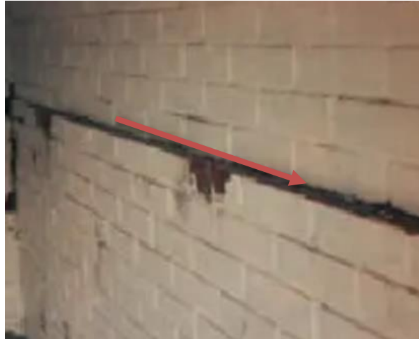
Ilustración 17. Falla por deslizamiento. Fuente [32].
