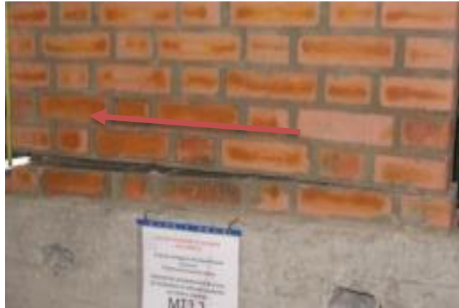
Ilustración 19. Falla por desprendimiento en la base. Fuente [34]
