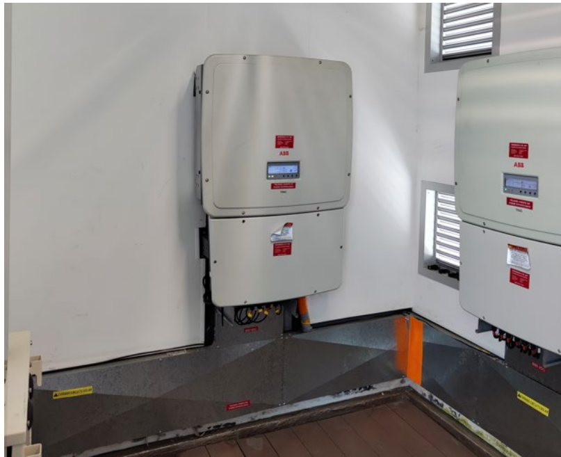
Ilustración 40 Inversores ABB, instalados en la Universidad Escuela Colombiana de Ingeniería Julio Garavito
