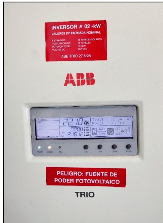
Ilustración 73 Inversor #2 - Instalación Solar Fotovoltaica Edificio Alejandro Sandino - Escuela Colombiana de Ingeniería Julio Garavito
