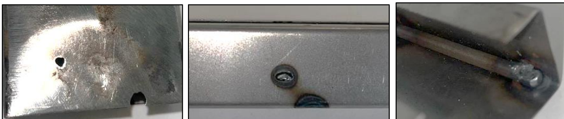
Figura 24. Fallas por soldadura en el proceso de adhesión de refuerzos.
