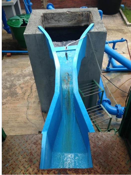
Ilustración 6 Mezcla rápida. PTAP Sopó (Cundinamarca). Fuente: autor.
