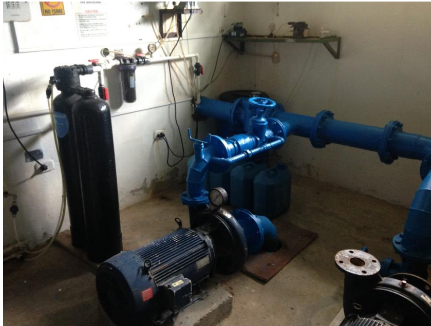
Ilustración 10 Cloración. PTAP Sopó (Cundinamarca). Se observa el sistema de bombeo. Fuente: autor.
