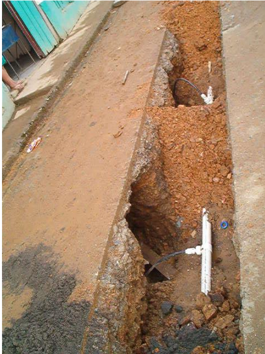
Ilustración 13 Tendido de una red de distribución y conexión domiciliaria, acueducto San José del Palmar (Chocó). Fuente: autor.
