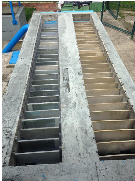
Ilustración 7 Floculación de flujo vertical. PTAP Sopó (Cundinamarca). Fuente: autor.
