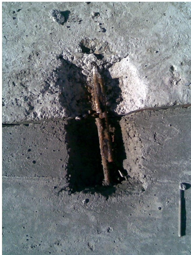
Fotografía No. 2 Conexión soldada usada entre placas del sistema prefabricado. (Fuente: Roque Armenta, IC constructora SAS).
