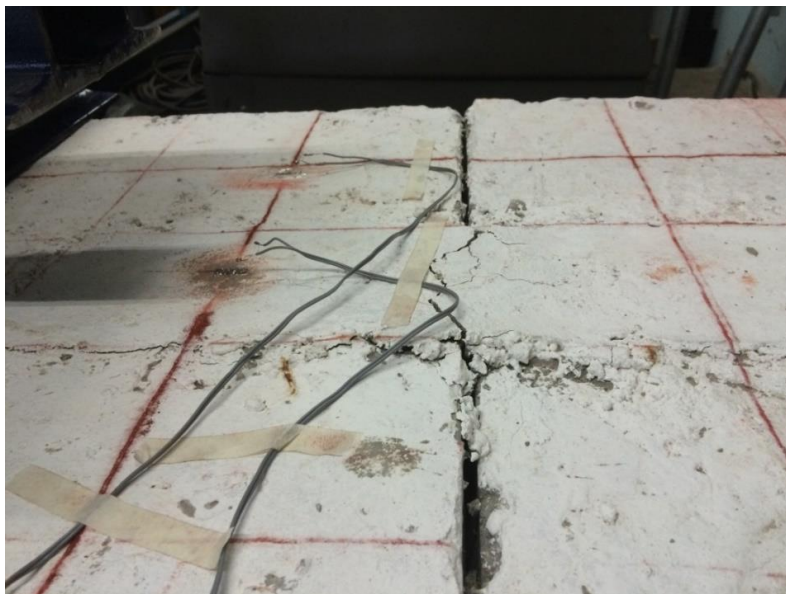
Fotografía No. 9. Fisuración transversal en conexión con carga normal a su plano.
