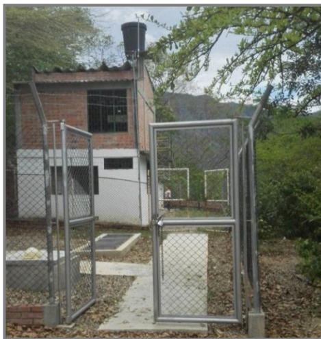
Fotografía 9 Planta de Tratamiento Casco Urbano del municipio de Beltrán
