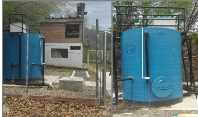
Fotografía 10 Planta de Tratamiento Compacta fuera de funcionamiento
