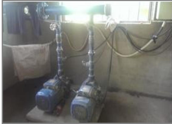
Fotografía 8 Equipos de bombeo Desarenador – PTAP
