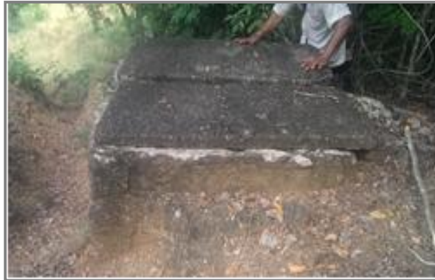
Fotografía 4 Cámara de Quiebre – Línea de Aducción
