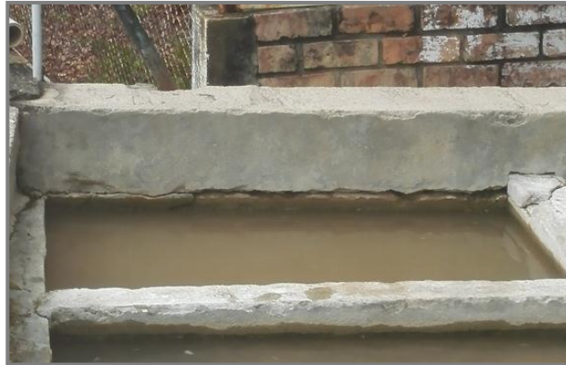
Fotografía 17 Grietas en el floculador
