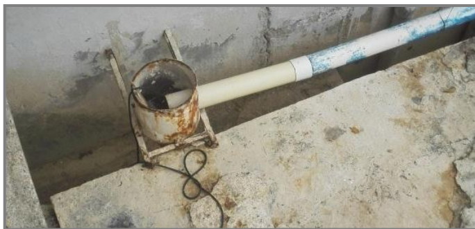
Fotografía 22 Dosificación de Cloro antes del tanque de almacenamiento
