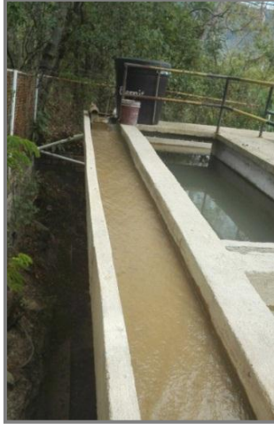
Fotografía 13 Canal de entrada
