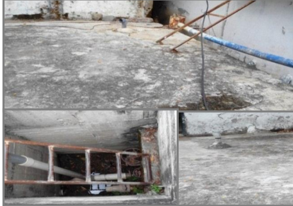
Fotografía 12 Tanque de Almacenamiento
